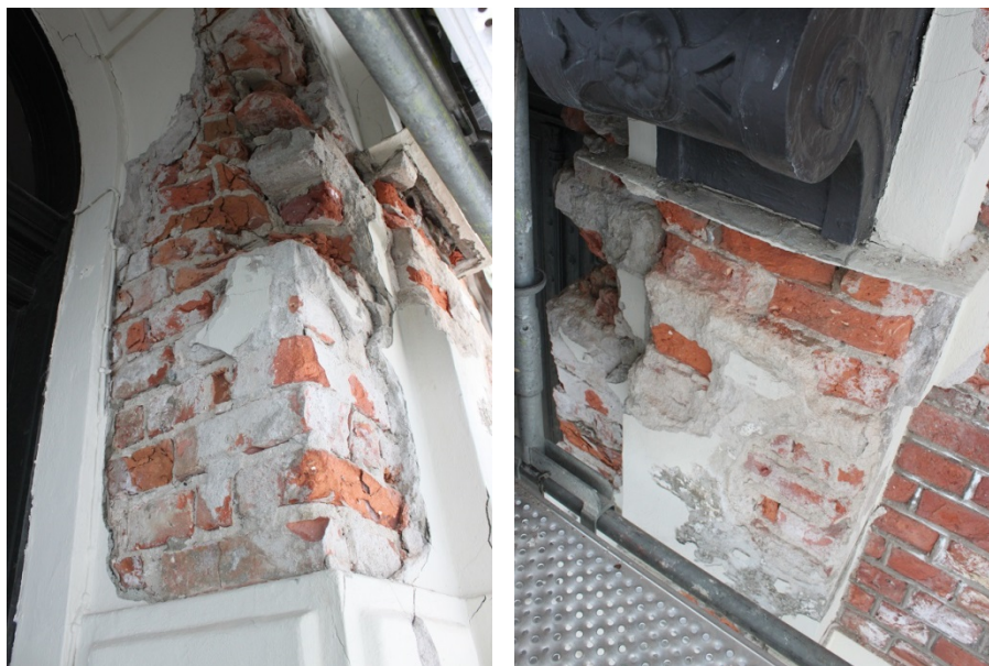
Figur 2 och 3. Exempel på murverks- och putsskador i anslutning till balkongen. Foto: Ulrika Olsson, Läns museet Gävleborg, 2018-03-01.
