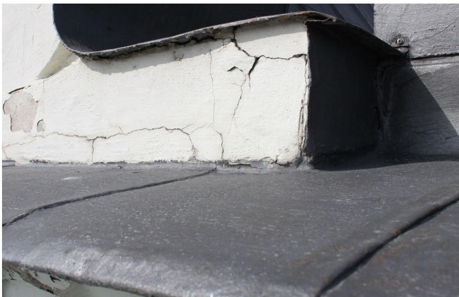
Figur 5 och 6. Skador på listverk på den sydvästra prydnadsgaveln. Foto: Ulrika Olsson, Läns museet Gävleborg, 2018-04-20.
