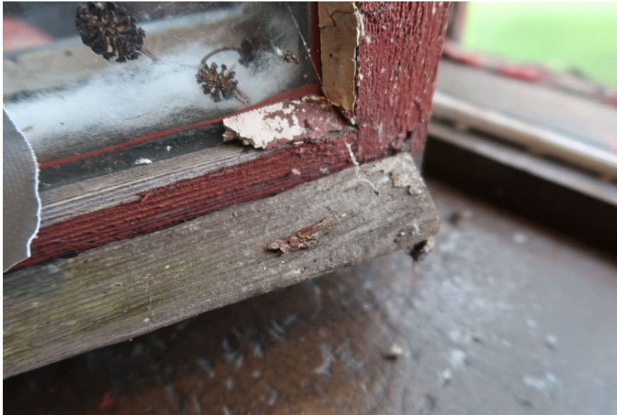
Figur 6. Innan påbörjade arbeten. Exempel på eftersatt underhåll på fönsterbågar. Foto: Ulrika Olsson, Läns museet Gävleborg, 2019-08-15.
