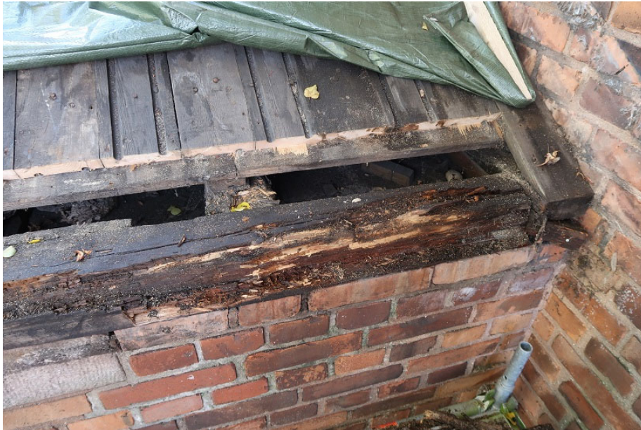
Figur 9. Rötskador på takfot och takpanel på entrétaket. Foto: Ulrika Olsson, Länsmuseet Gävleborg, 2019-10-30.
