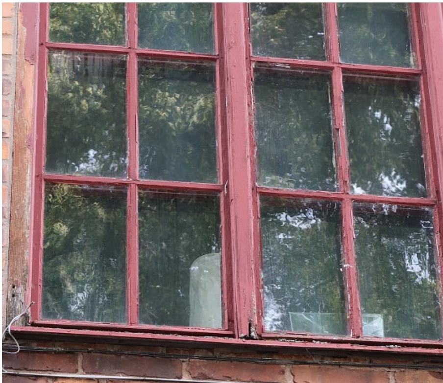
Figur 5. Innan påbörjade arbeten. Exempel på eftersatt underhåll på fönsterbågar. Foto: Ulrika Olsson, Läns museet Gävleborg, 2019-08-15.
