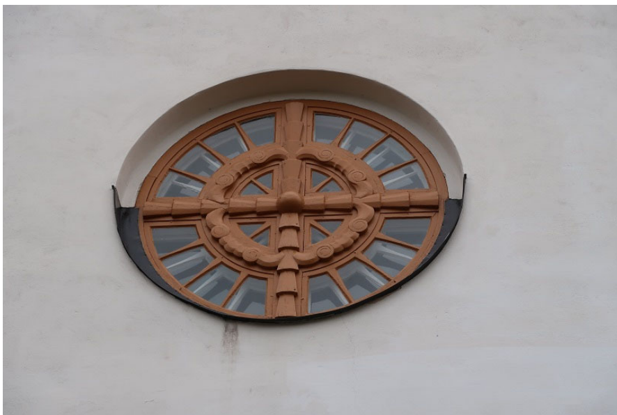
Figur 24. Det runda fönstret ovanför huvudentrén har sniderier som är spikade mot bågen. Mellanrummet mellan de båda delarna har nu kittats för att undvika att fukt tränger ner mellan delarna. Foto: Ulrika Olsson, Läns museet Gävleborg, 2019-10-15.
