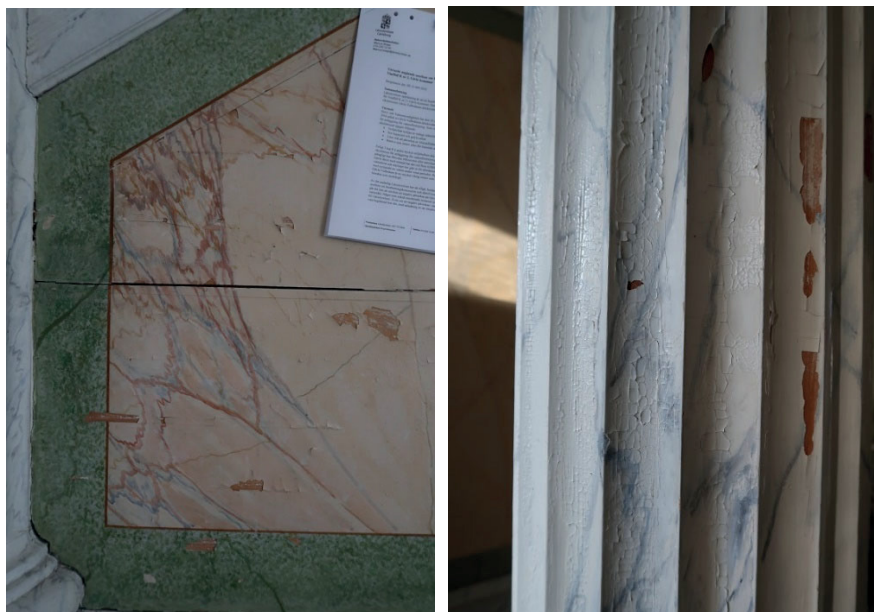
Figur 2 och 3. Exempel på skadade färgskikt innan påbörjade arbeten. Foto: Ulrika Olsson, Länsmuseet Gävleborg, 2019-11-05.
