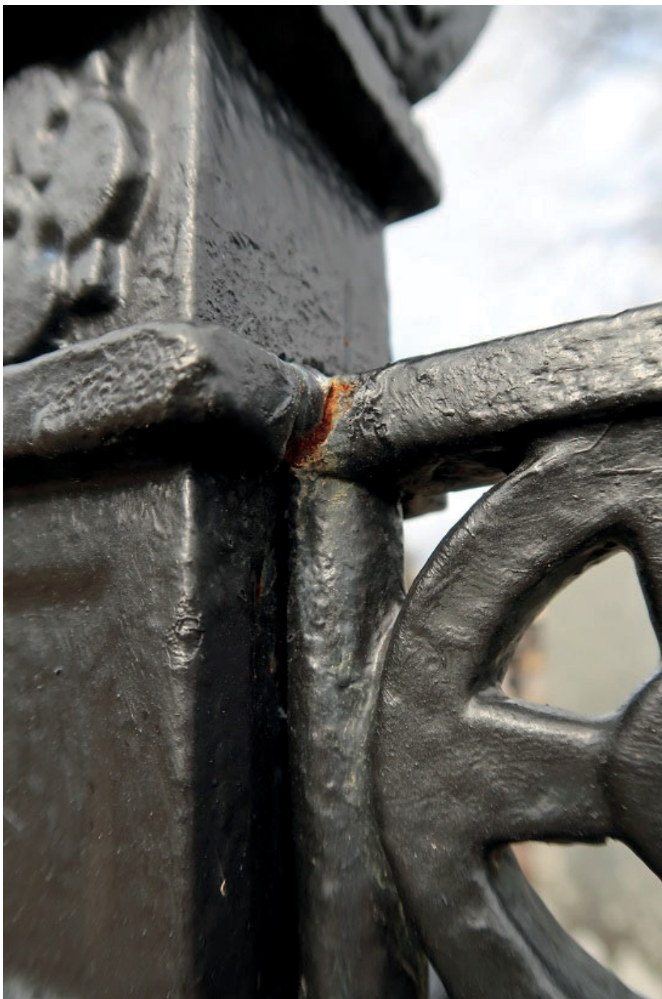
Figur 40. K7:0142 med staket av gjutjärn, efter avslutade arbeten. Här syns en detalj där målningsbehandlingen inte utförts fullt ut. Foto: Ulrika Olsson, Länsmuseet Gävleborg, 2020-03-18.
