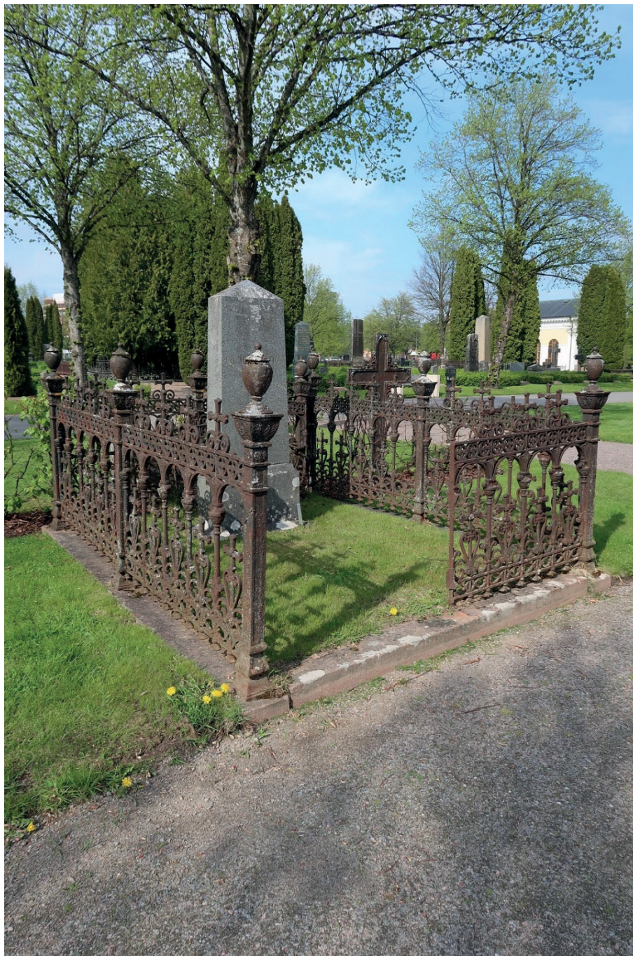
Figur 35. K7:0142 med staket av gjutjärn, innan påbörjade arbeten. Staketet uppvisade kraftiga rostangrepp samt flera lösa materialdelar. Foto: Ulrika Olsson, Läns museet Gävleborg, 2019-05-20.
