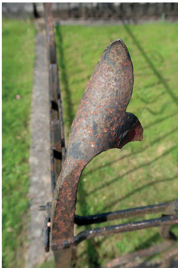
Figur 31–32. K7:0132 med staket i smide, innan påbörjade arbeten. Staketet uppvisade kraftiga rostangrepp och färgbortfall. Foto: Ulrika Olsson, Länsmuseet Gävleborg, 2019-05-20.
