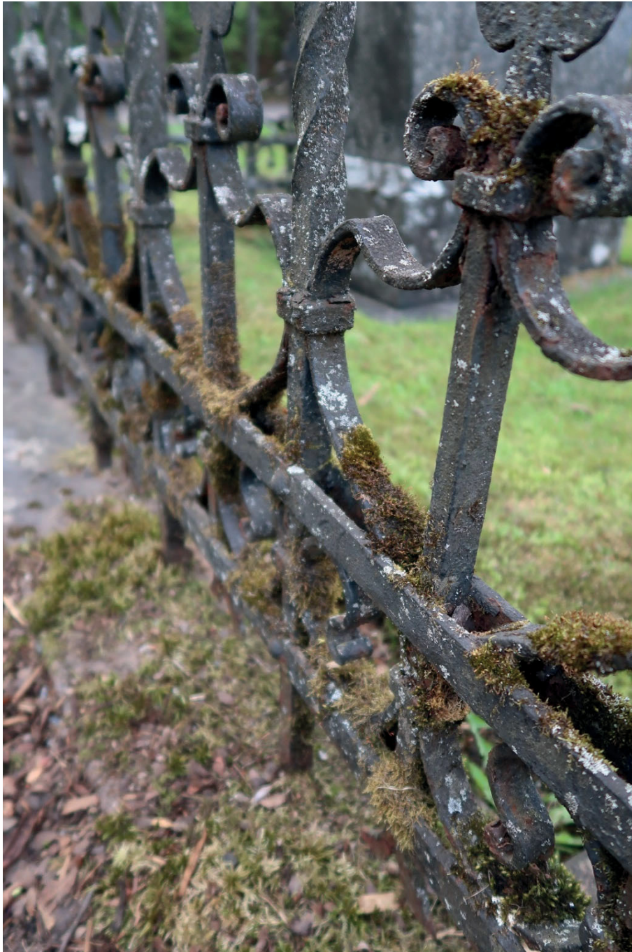
Figur 48. K7:0197 med staket i smide, innan påbörjade arbeten. Färgbortfall, rostangrepp och biologisk påväxt. Foto: Ulrika Olsson, Länsmuseum Gävleborg, 2019-05-20.
