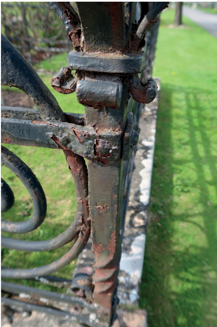
Figur 14. K7:0035 med staket i smide, innan påbörjade arbeten. Staketet uppvisade kraftiga rostangrepp. Foto: Ulrika Olsson, Länsmuseet Gävleborg, 2019-05-20.
