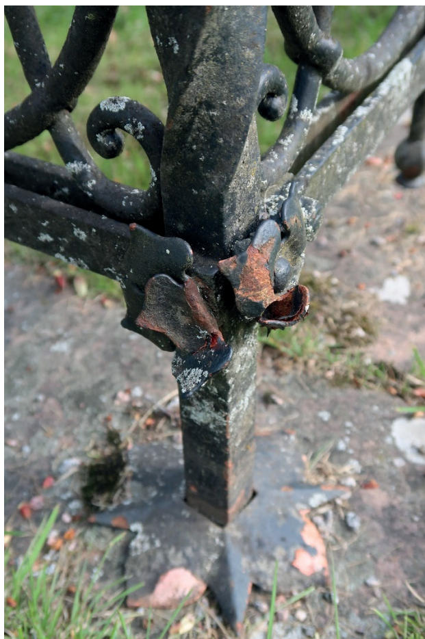
Figur 27–28. K7:0128 med staket i smide, innan påbörjade arbeten. Staketet uppvisade kraftiga rostangrepp och färgbortfall. Stensockeln har sjunkit. Foto: Ulrika Olsson, Läns museet Gävleborg, 2019-05-20.
