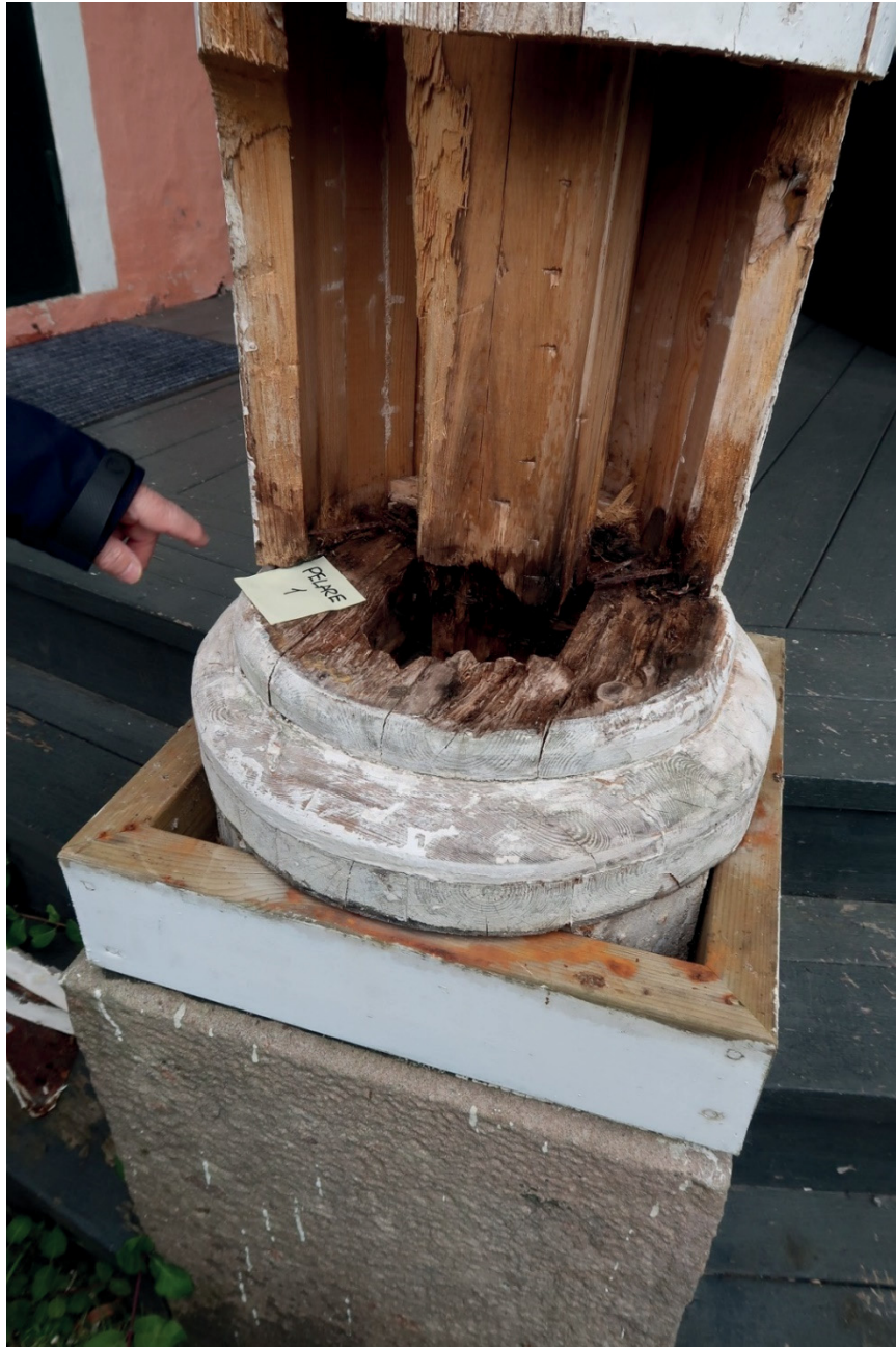
Figur 2. Pelare 1 efter att Sedvall öppnat upp den för att bedöma omfattning på skadorna. Här syns den gjutna delen i lådbasen samt hur de rundade ovanliggande delarna består av flera hopsatta trädelar. Lådbasen är tillverkad av tryckimpregnerat virke. Foto: Ulrika Olsson, Länsmuseum Gävleborg, 2019-09-20.
