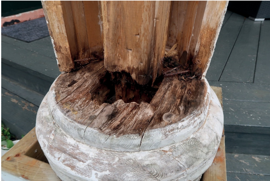
Figur 3. Närbild på skadorna vid pelarbasen på pelare 1. Foto: Ulrika Olsson, Läns museet Gävleborg, 2019-09-20.
