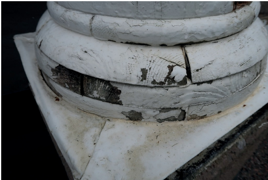
Figur 4. Pelare 6 och exempel på hur de rundande delarna bestod av flera hopsatta virkesdelar som sinsemellan torkat isär med inträngande fukt som följd. Foto: Ulrika Olsson, Läns museet Gävleborg, 2019-09-20.
