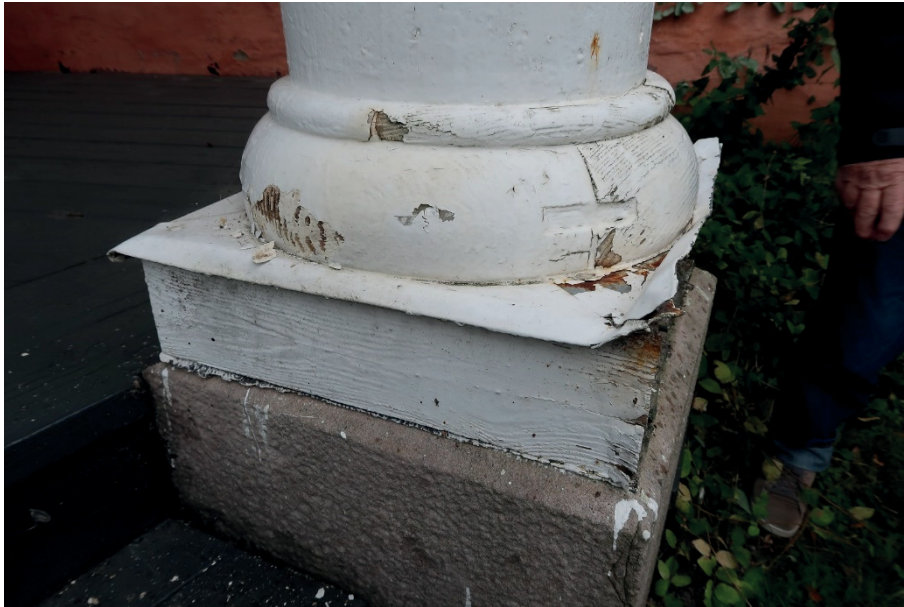
Figur 5. Pelare 7. Jämför de rundande delarna på bilden med hur de är utformade på föregående bild. Pelare 7 bedömdes vara den pelare som hade den äldsta bevarade utformningen. Tack vare de hela virkesdelarna hade inte väta läckt in i lådbasen. Foto: Ulrika Olsson, Läns museet Gävleborg, 2019-09-20.
