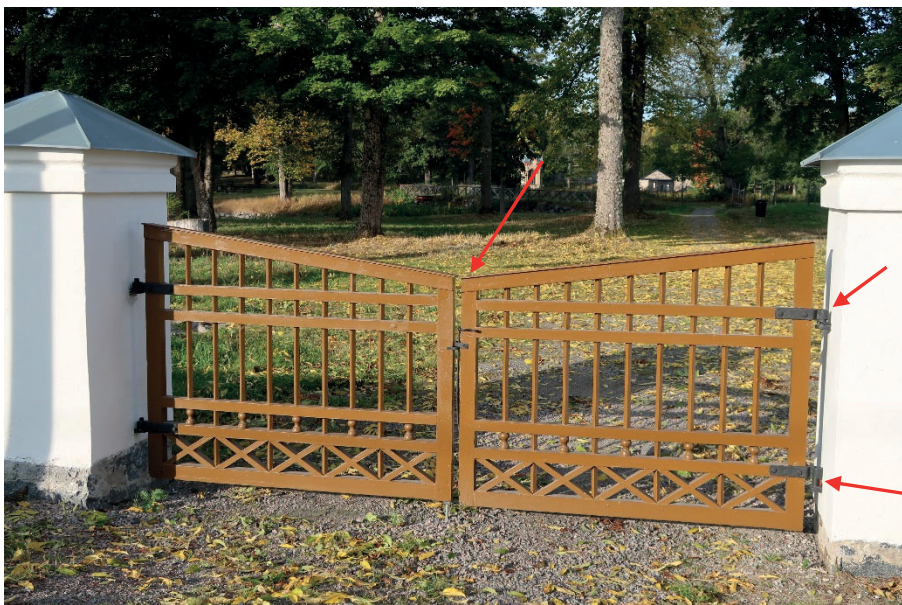
Figur 8. Gångjärnen och krokarna mot höger stämmer inte helt överens med varandra. Detta gör att den högra grinden hänger något lägre än den vänstra, samt inte helt säkert i det nedre gångjärnet. Foto: Ulrika Olsson, Läns museet Gävleborg, 2020-09-25.
