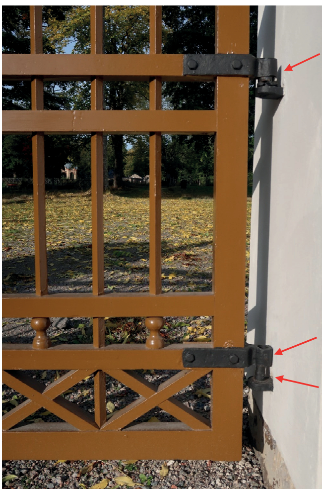
Figur 9. Gångjärnen och krokarna mot höger stämmer inte helt överens med varandra. Detta gör att den högra grinden hänger något lägre än den vänstra, samt inte helt säkert i det nedre gångjärnet. Foto: Ulrika Olsson, Läns museet Gävleborg, 2020-09-25.
