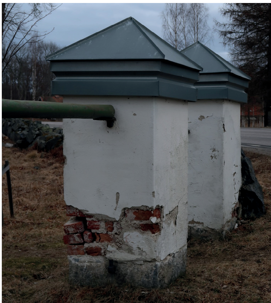
Figur 4. Den högra mittstolpen hade stora skador i murverket. Notera utformningen på huvarna från 1970-talet, att jämföra med de äldre i figur 6. Foto: Ulrika Olsson, Läns museet Gävleborg, 2020-03-31.
