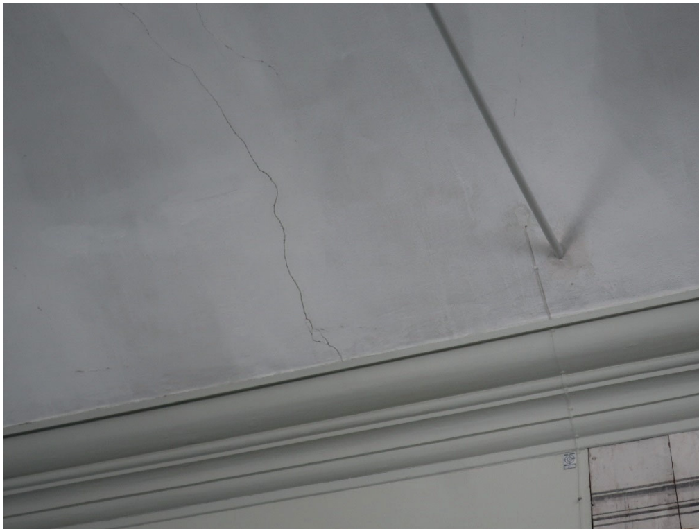
Figur 15. Detalj av det östra dragstagets anslutning till valvet över koret på den södra sidan med befintlig sprickbildning i taket som ska hållas under uppsikt i framtiden. Foto: Daniel Olsson, Läns museet Gävleborg 2019-04-15.
