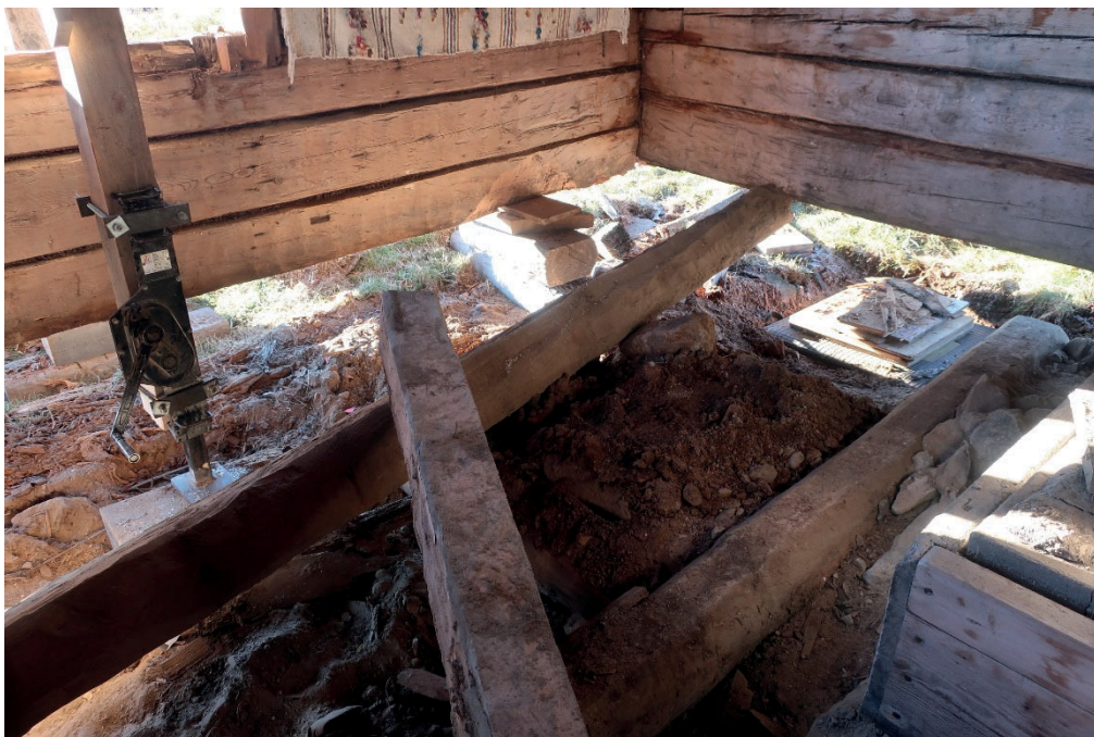
Figur 13. Detalj av den stora stugans västra hörn efter demontering av golvkonstruktionen och under pågående lyftning av husets sydvästra del. Foto: Daniel Olsson, Länsmuseet Gävleborg 2018-10-26.
