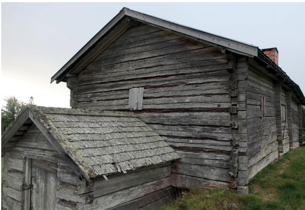
Figur 11. Vallstugan från norr med den rötskadade nordöstra väggen och källarsvalen med spåntak i dåligt skick. Foto: Daniel Olsson, Läns museet Gävleborg 2018-09-25.
