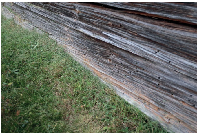
Figur 8. Detalj av syllstock skadad av insektsangrepp samt hög marknivå vid den sydvästra fasaden (vägg B). Foto från söder. Foto: Daniel Olsson, Läns museet Gävleborg 2018-09-25.
