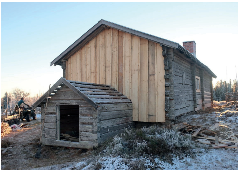
Figur 20. Vallstugan från norr med ny panel på fasaden mot nordöst. Källarsvalen hade då ännu inte försetts med ett nytt spåntak. Foto: Daniel Olsson, Läns museet Gävleborg 2018-11-23.
