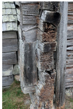
Figur 9. Detalj av instabil timmervägg vid knut mot norr (knut C/D). Foto från nordväst. Foto: Daniel Olsson, Läns museet Gävleborg 2018-09-25.
