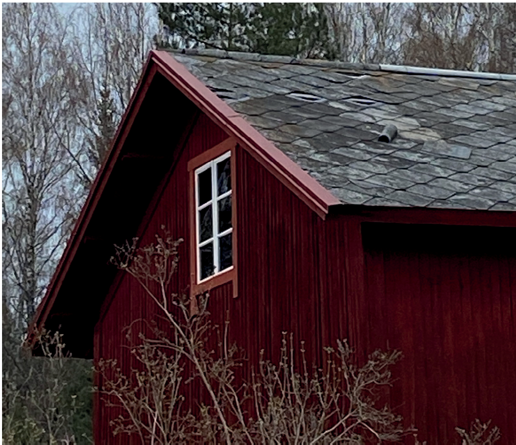
Figur 4. Närbild på den tidigare taktäckningen av eternitplattor. På bilden syns flera trasiga plattor. Notera också den rödfärgade vindsiveplåten. Foto: Ulrika Olsson, Länsmuseum Gävleborg, 2021-04-27.
