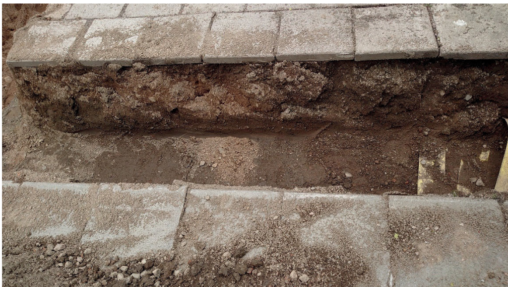
Figur 15. Anslutningsschakt i Kyrkogatan. Foto: mot västsydväst av Anders Altner.
