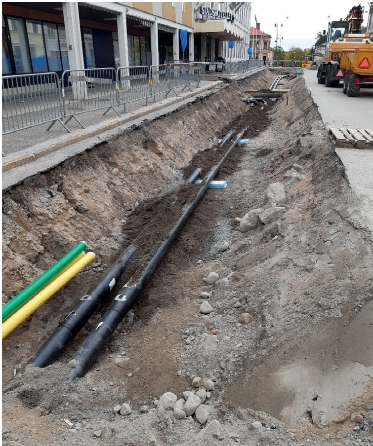
Figur 8. Den centrala och norra delen av schaktet var mycket påverkad av tidigare grävarbeten. Foto: Frida Löjdström, taget mot öster.
