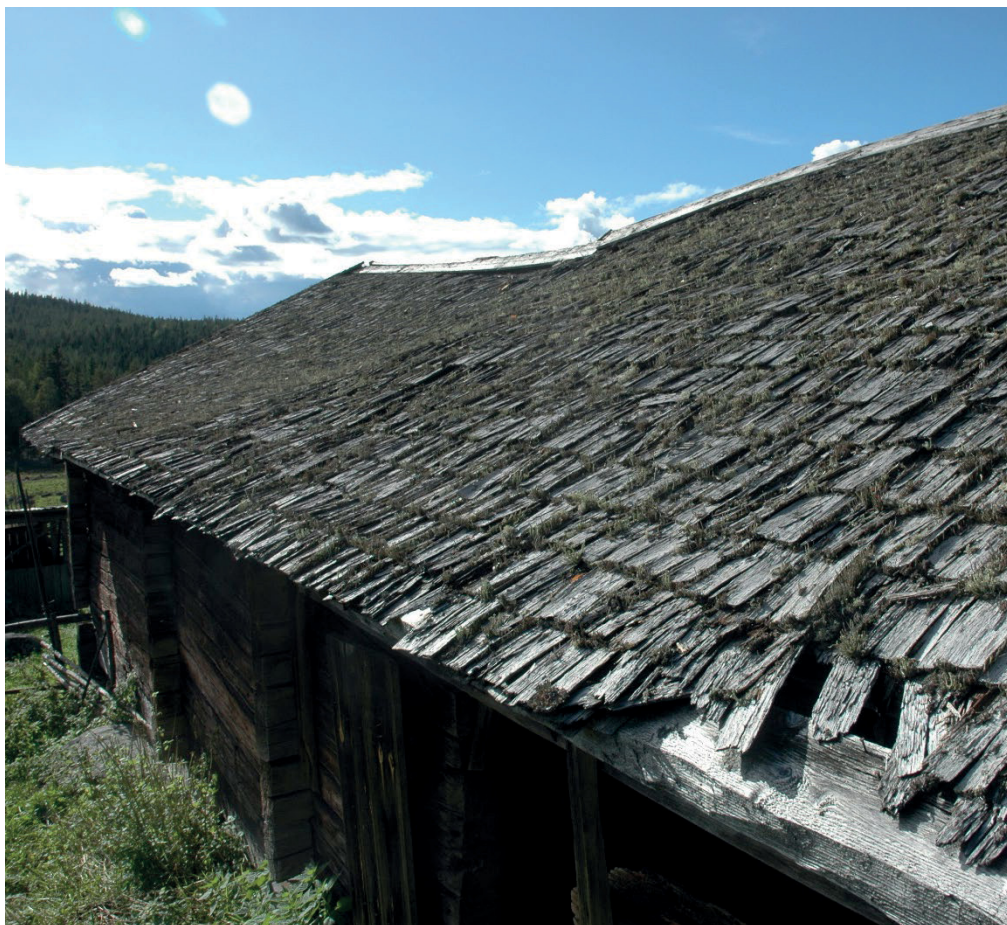
Figur 11. Fäxets skadade takfall mot sydöst med knäcktnockås och takspån i mycket dåligt skick. Foto: Daniel Olsson, Läns museet Gävleborg 2018-09-06.
