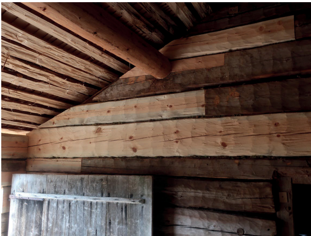
Figur 23. Detalj av timmerbyten i den övre delen av mellanvägg E, närmast vägg A. Foto: Daniel Olsson 2020-05-28.
