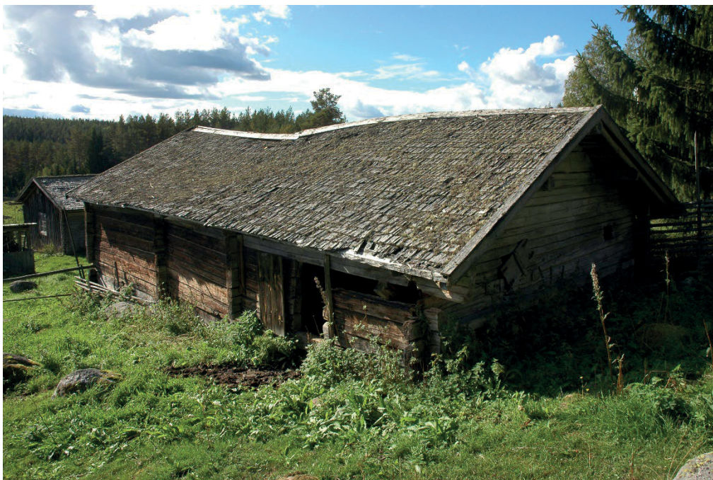
Figur 7. Fäxet från öster innan renoveringen med kraftig takskada. Foto: Daniel Olsson, Länsmuseet Gävleborg 2018-09-06.
