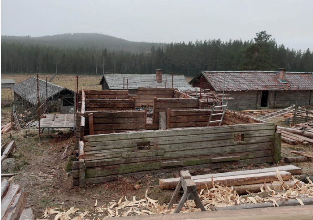
Figur 12. Timmerstommen från nordöst efter demontering av byggnadens övre del vilken hade omfattande rötskador. Foto: Daniel Olsson 2019-11-06.
