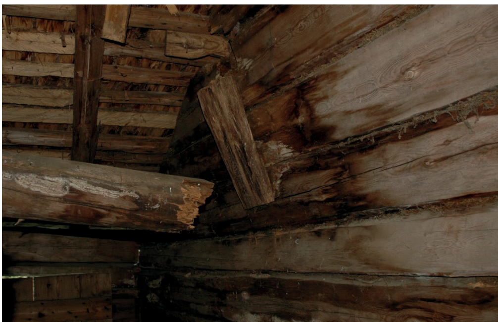
Figur 10. Fäxets lider med nedfallen rötskadad takås samt mellanvägg mot småfähuset med omfattande rötskador. Foto: Daniel Olsson, Länsmuseet Gävleborg 2018-09-06.
