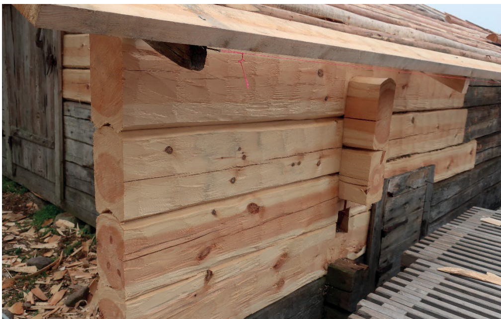
Figur 14. Detalj av utbytta timmerstockar vid knut C/D från norr. Foto: Daniel Olsson 2020-10-19.
