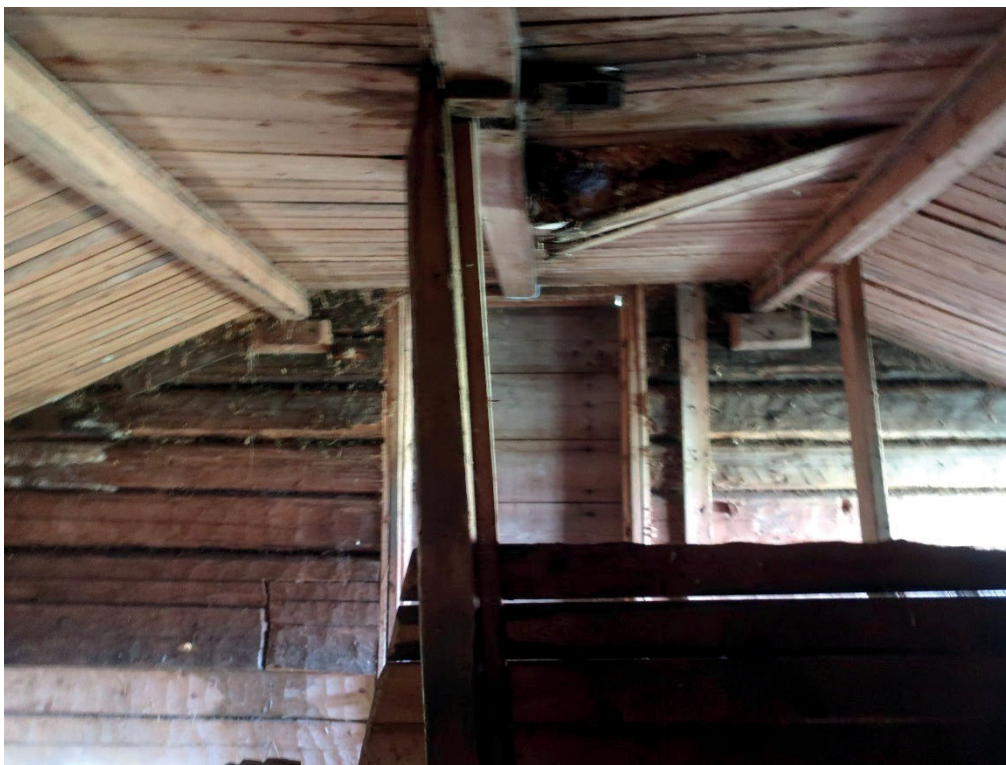
Figur 7. Stallens interiör från sydväst innan renoveringen med båsavskiljare och undertak. Foto: Daniel Olsson 2020-05-28.
