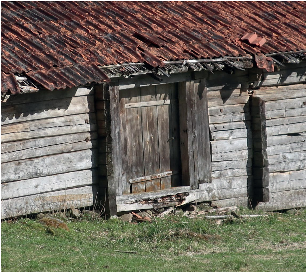
Figur 10. Detalj av takfallet mot nordväst med tegeltak i mycket dåligt skick samt en rötskadad stock under porten. Foto: Daniel Olsson 2020-05-28.
