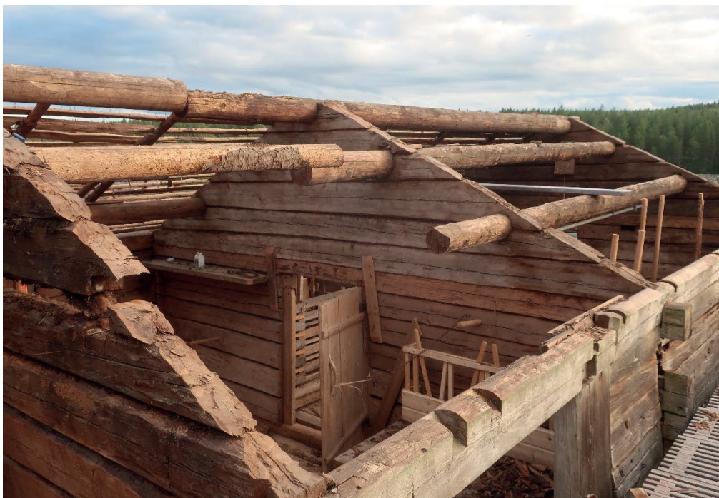
Figur 11. Lidret och fäxet från norr efter demontering av takspån, trovirke, sparrar och skadade takåsar. Foto: Daniel Olsson 2020-08-28.
