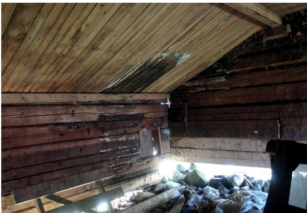
Figur 9. Del av stallets norra interiör från söder med rötskador på timmer och undertak. Foto: Daniel Olsson, 2020-05-28.
