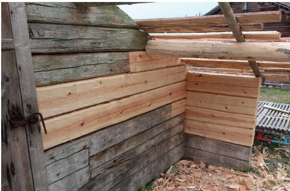
Figur 18. Detalj av utbytta stockar vid knut C/D från öster. Foto: Daniel Olsson 2020-09-21.
