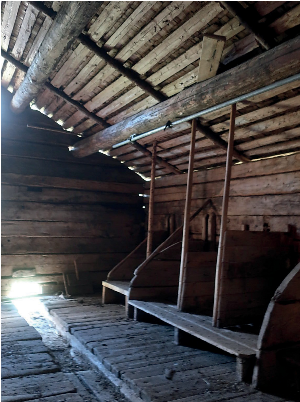
Figur 6. Del av fäxets interiör från nordöst med ombyggda och delvis förhöjda båsplatser från 1980-talet. På bilden ses även takkonstruktionen med runda åsar, taksparrar och taktro som underlag för spåntaket. Foto: Daniel Olsson 2020-05-28.
