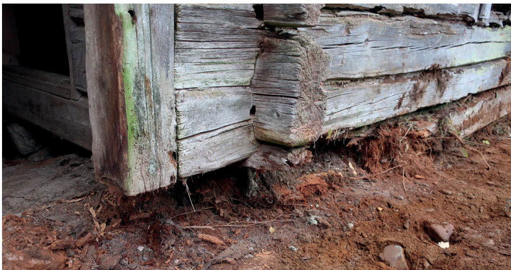
Figur 11. Svårt rötskadad syllstock under stalllets nordöstra fasad. Foto: Daniel Olsson 2018-10-09.
