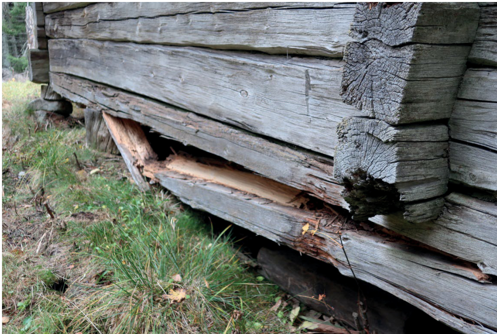
Figur 8. Källarbodens rötskadade syllstock i vägg mot sydöst. Foto: Daniel Olsson 2018-10-09.
