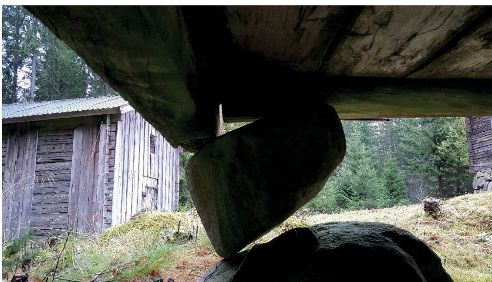
Figur 10. De instabila grundstenarna under stalllets västra hörn från sydöst innan renoveringen. Foto: Lars Olofsson 2017-10-09.
