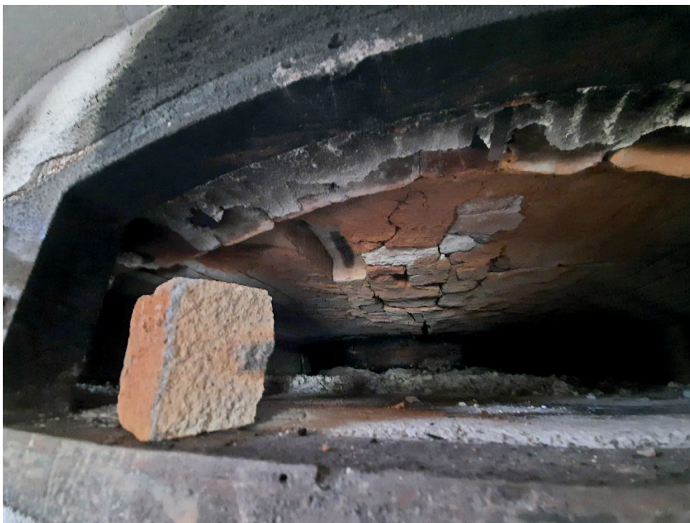
Figur 7. Bakugnens valv innan renoveringen med omfattande sprickbildning och tegelbitar som lossnat. Foto från nordost. Foto: Anders Eklind 2020-10-01.
