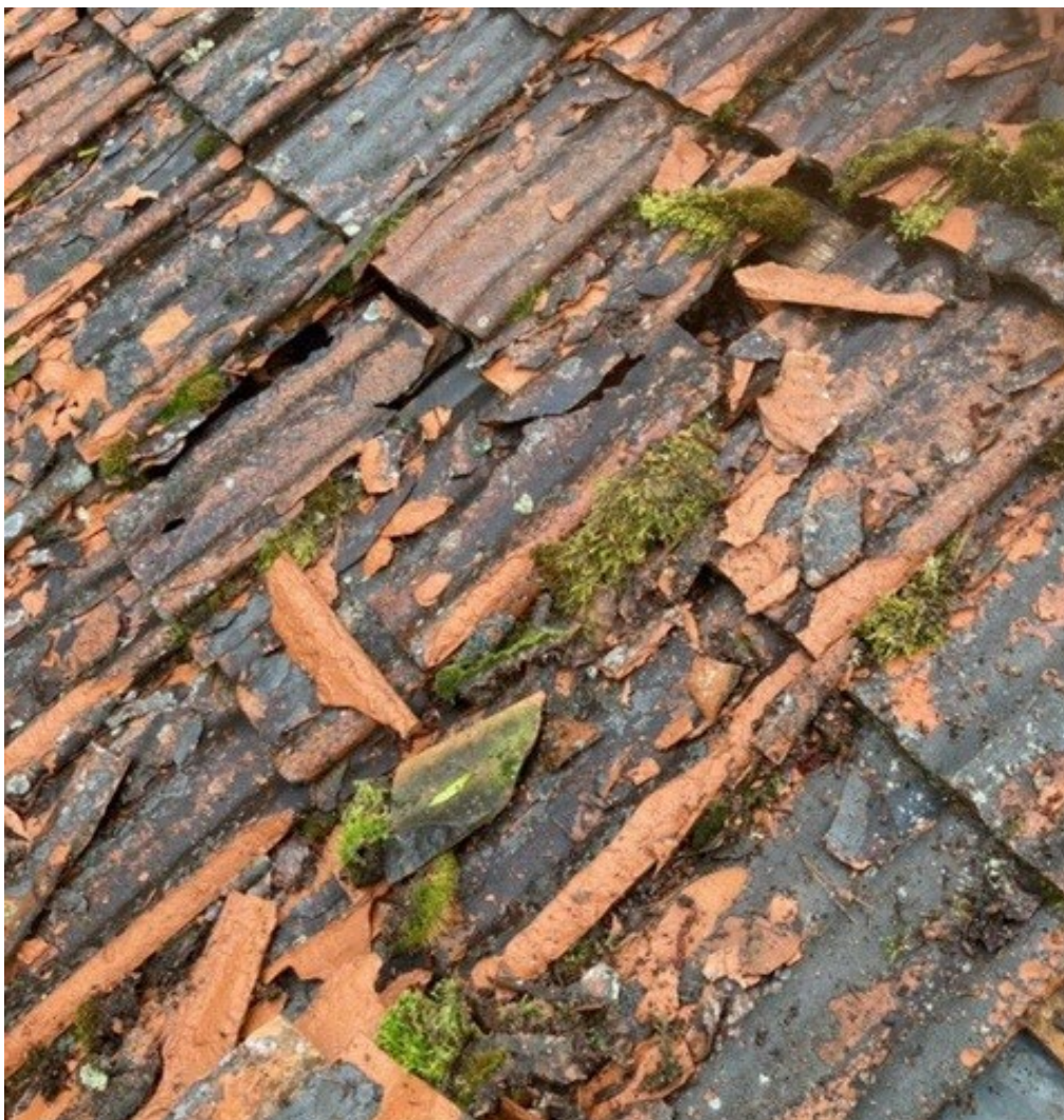
Figur 4. De gamla trekupiga takpannorna var utom räddning då en stor del av dem var frostskaadade eller trasiga på annat vis. Foto: Kalvsnäs byalag.
