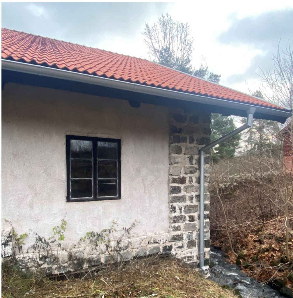
Figur 10. Stuprören har skarpa vinklar. Här syns stupröret vid det sydvästra hörnet. Vattnet leds direkt ner mot forsen. Foto: Ulrika Olsson, 2022-11-11.
