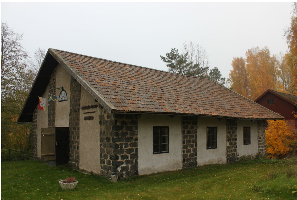
Figur 2. Kalvsnäs kvarn innan påbörjade takarbeten. Foto: Ulrika Olsson, 2018-10-18.
