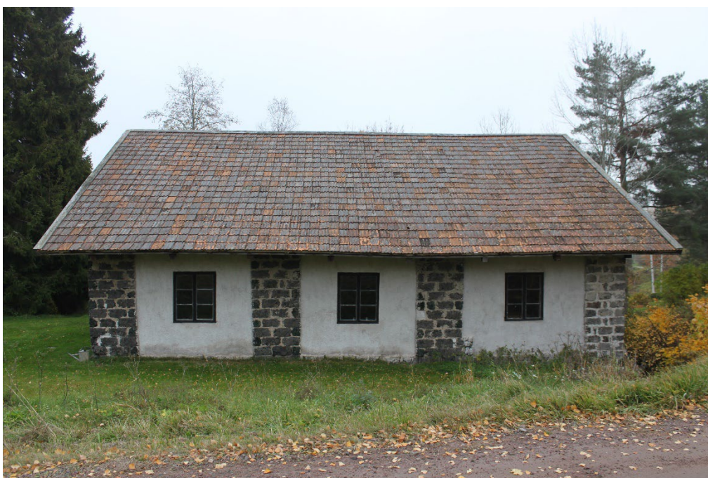
Figur 3. Kalvsnäs kvarn innan påbörjade takarbeten. Foto från väster. Notera svackan vid takfoten. Foto: Ulrika Olsson, 2018-10-18.
