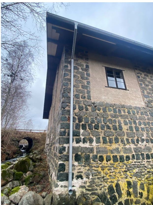
Figur 12. Foto från öster, mot den södra gaveln. Här syns ilagade delar i takfoten. Dessa ska tjärstrykas till våren. Foto: Ulrika Olsson, 2022-11-11.
