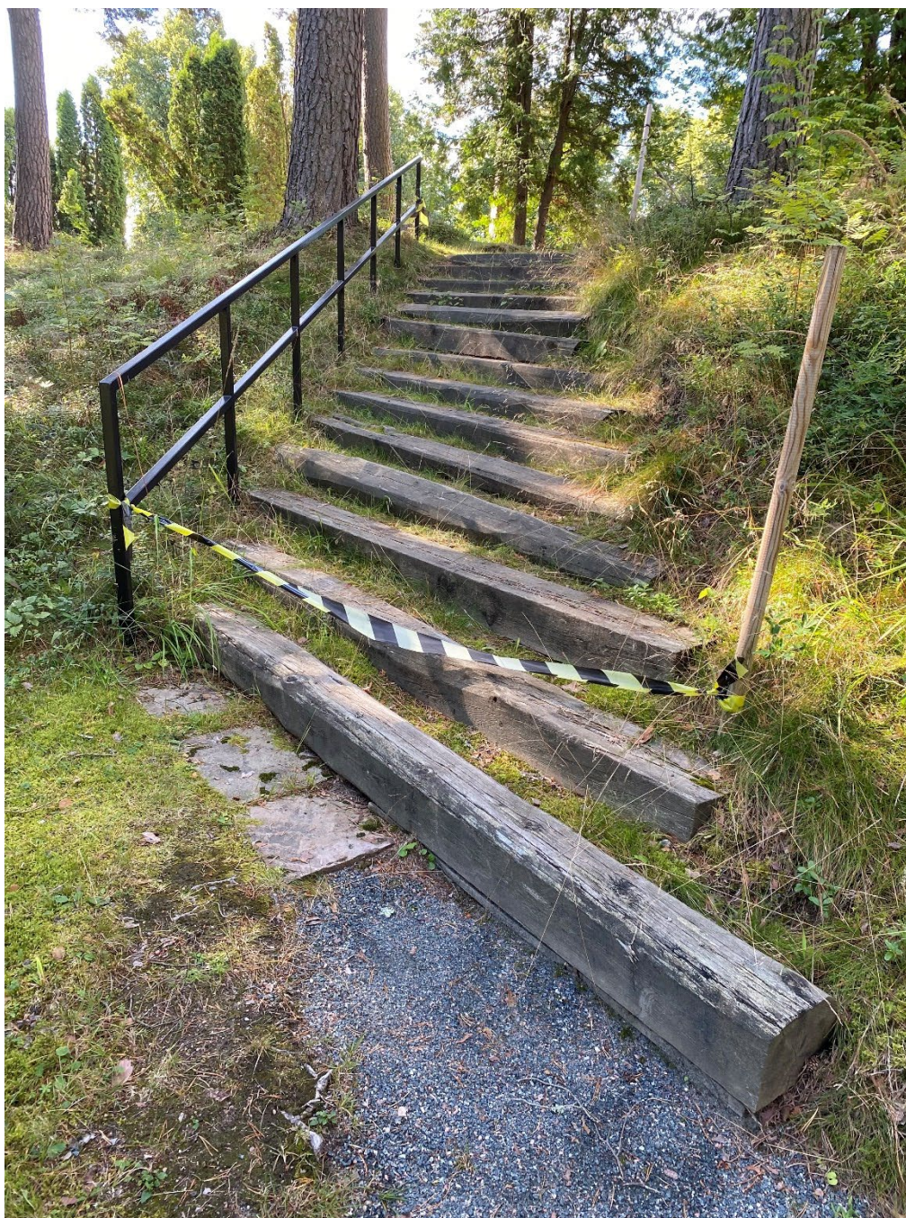
Figur 8. Trappan av slipers innan påbörjade arbeten. Trappans tillgänglighet var undermålig. Foto: Ulrika Olsson, 2022-09-01.
