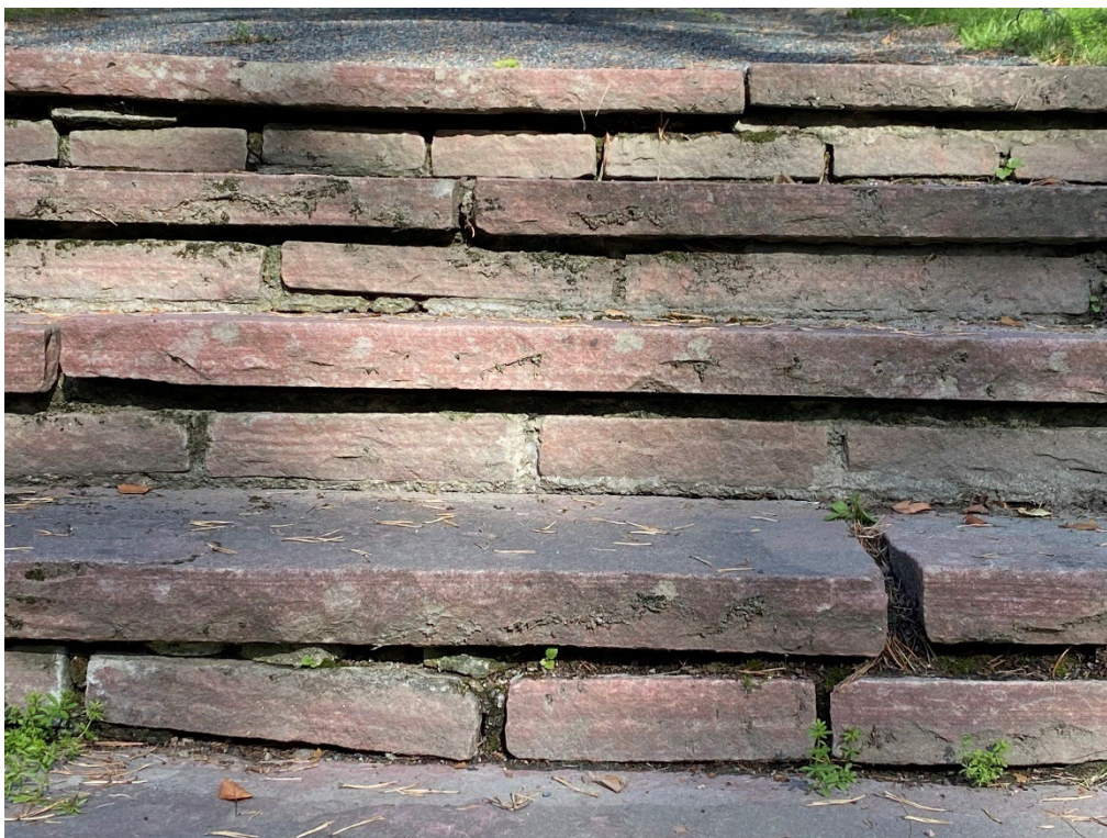
Figur 6. Närbild på sättningskadorna i den ena av de två stentrapporna. Foto: Ulrika Olsson, 2022-09-01.
