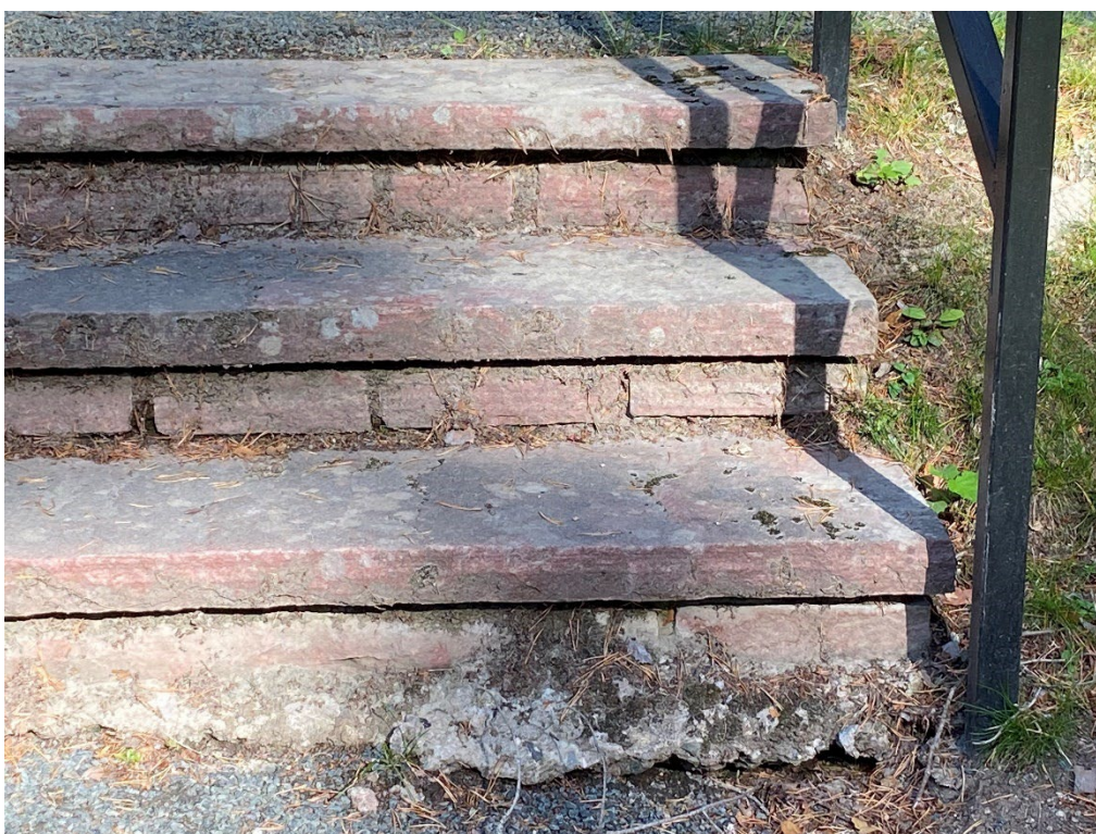
Figur 7. Närbild på skada i den ena av de båda stentrapporna. Foto: Ulrika Olsson, 2022-09-01.
