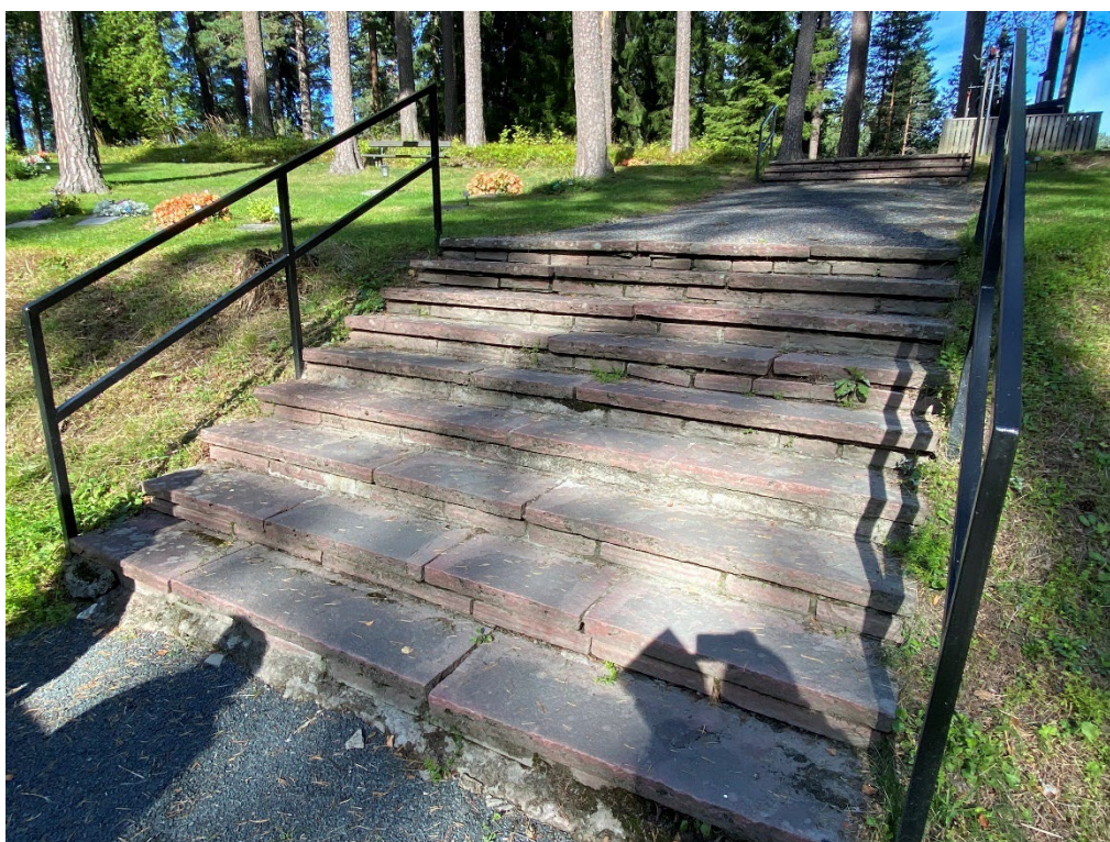
Figur 5. Sättningskador i de båda stentrapporna i minneslundens norra del, kvarter U. Stenarna var angripna av påväxt och gräs trängde fram i konstruktionen. Foto: Ulrika Olsson, 2022-09-01.
