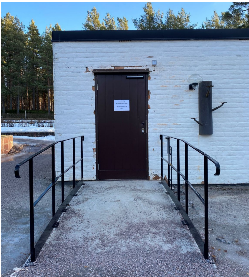
Figur 8. Den nya RWC'n nås via en gjuten ramp. Ledstänger med avåkningskydd har monterats på båda sidor av rampen. Snett till höger ovanför dörren sitter en sensor. Den vägghängda armaturen är nytillkommen. Foto: Ulrika Olsson, 2023-01-31.
