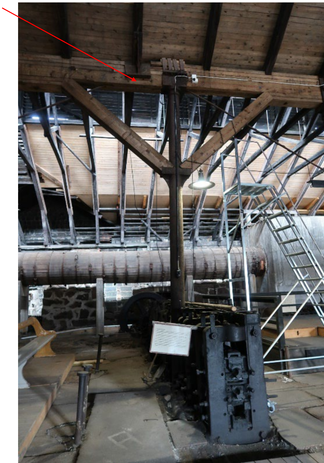
Figur 8. Det är okänt när stålpelaren flyttades från sin ursprungliga placering och ungefär 0,5 meter till höger. Pilen markerar pelarens ursprungliga läge. Foto: 2020-04-24.
