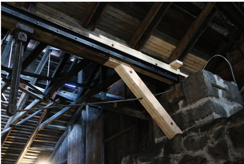
Figur 6. Närmare foto på de ilagade delarna i bärlina och snedstag. Foto: 2020-08-13.
