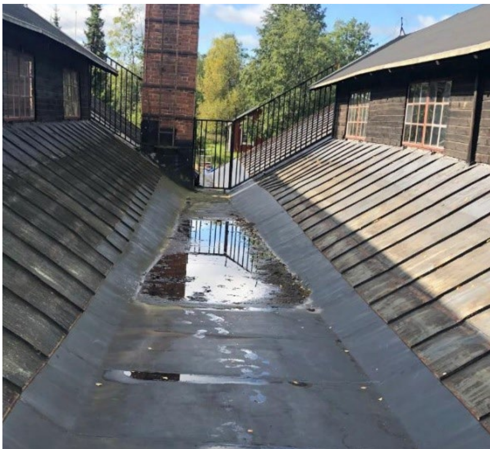
Figur 3. Ränn dalen innan påbörjade arbeten. Vidammen anas i bakgrunden. I och med att hela takkonstruktionen hade skador och sättningar påverkade det avrinningen i ränn dalen. Regnvatten blev stående i svackorna. Foto ur projekteringsunderlag åtgärder Wij valsverk, Käver & Mellin Byggekonstruktion, 2019-10-07.
