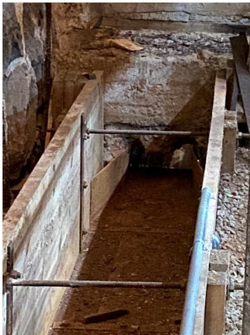
Figur 25. Från den befintliga rännan leds vattnet ut från byggnaden till sidofäran på framsidan. Foto: 2021-05-18.
