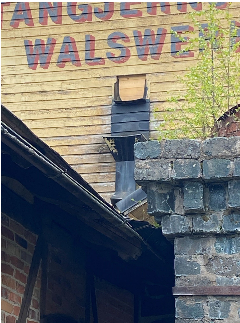
Figur 14. Innan arbetena med ränn dalen fanns också ett utkast mot nordöst, genom ett hål i fasaden. Vattnet rann då vidare ner på smedjans tak, där fotrännan med åren blivit undermålig, vilket givit upphov till ett väldigt fuktigt hörn mellan valsverket, smedjan och den gamla skorstenen i slaggsten. På fotot syns att öppningen från ränn dalen har byggts igen från insidan/ ränn dalen, men ännu återstår slutliga fasadarbeten. Foto: 2021-05-18.
