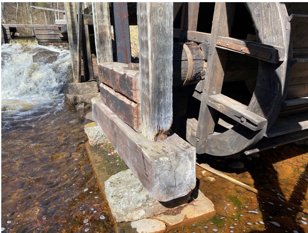
Figur 3. Stödpost vid linklappen innan påbörjade arbeten. Bilden visar rötskador på stolparna som bär upp överbyggnaden. Foto: 2023-05-08.
