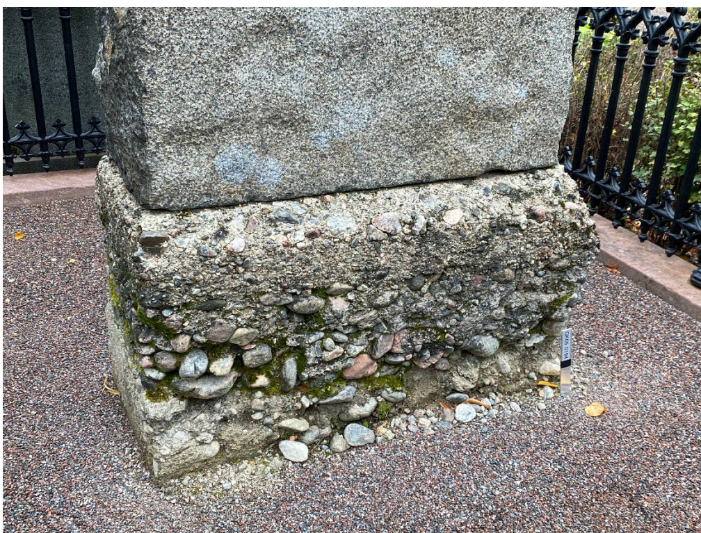
Figur 27. K05 0194 efter åtgärd. Vid slutbesiktningen tittade vi på den gjutna sockeln som gravvården vilar på. En möjlig orsak till att gravvården lutar kan vara att bruket är urlakat. Foto: Ulrika Olsson, 2023-09-29.
