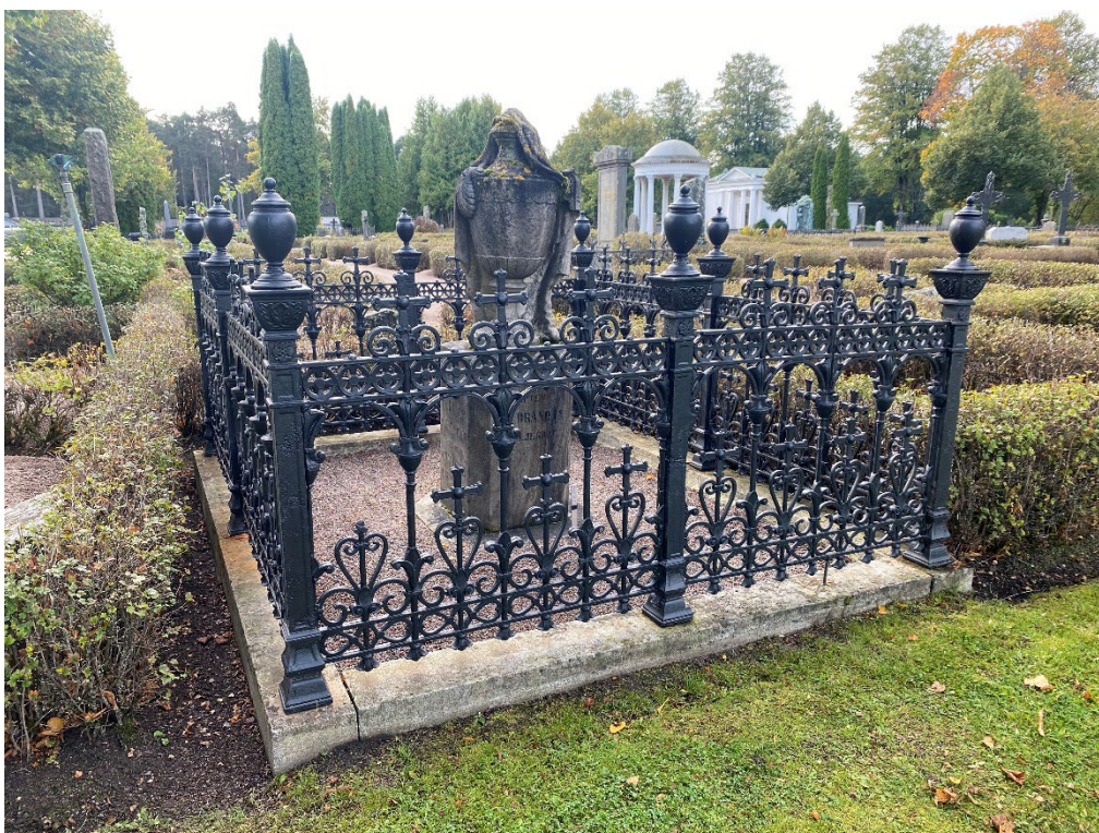
Figur 21. GK05 0017 efter åtgärd. Åtgärd av gjutjärnsstaketet krävde mycket svetsarbeten. Stensockeln har riktats. Foto: Ulrika Olsson, 2023-10-04.
