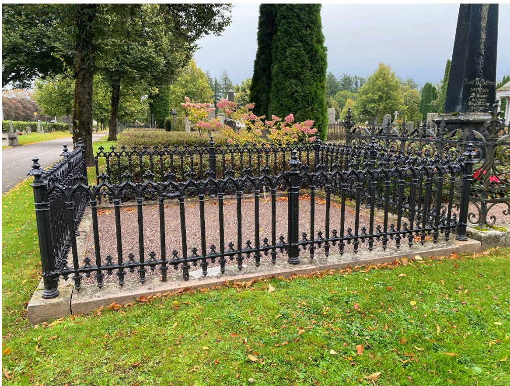
Figur 18. GK05 0135 efter åtgärd. Åtgärd av gjutjärnsstaketet krävde mycket svetsarbeten. Saknade delar har lämnats utan åtgärd. Stensockeln har riktats. Foto: Ulrika Olsson, 2023-09-29.
