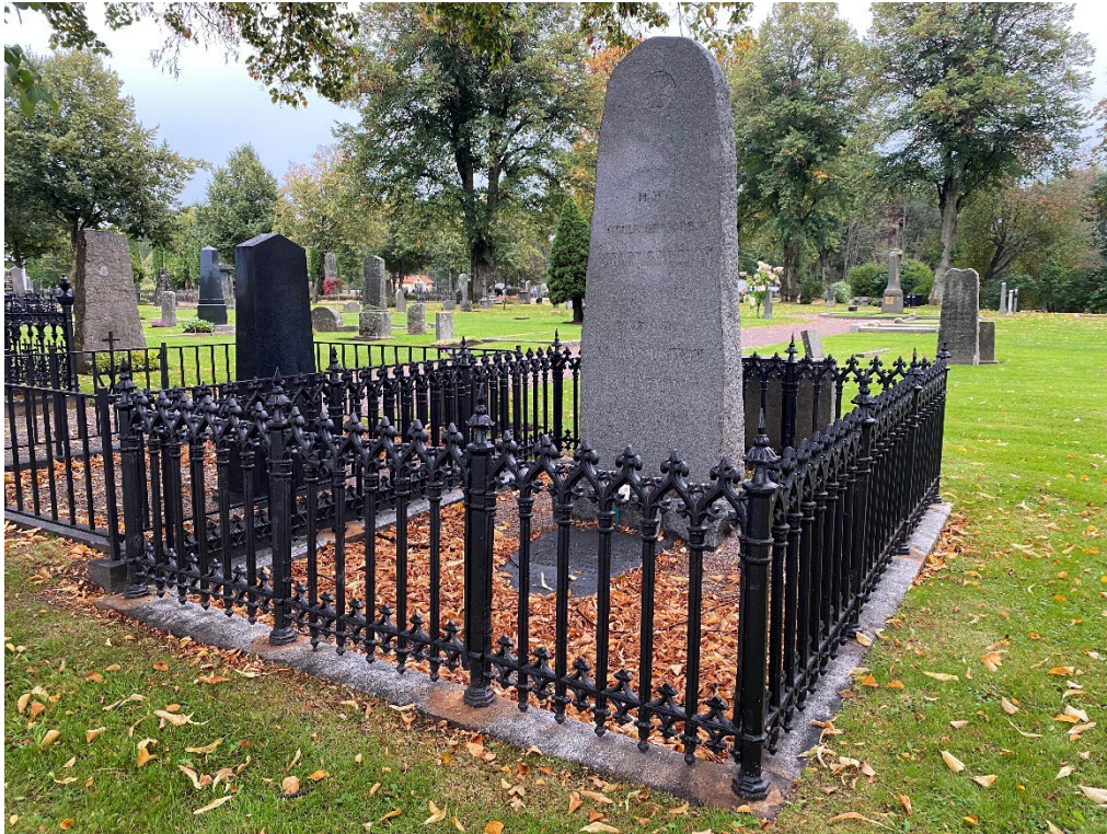
Figur 10. GK06 0303 efter åtgärd. Stensockeln har riktats och gravplatsens ursprungliga marktäckning med grus har återskapats. Gjutjärnsstaketet har lagats och grinden har fullgod stängningsfunktion. Foto: Ulrika Olsson, 2023-09-29.
