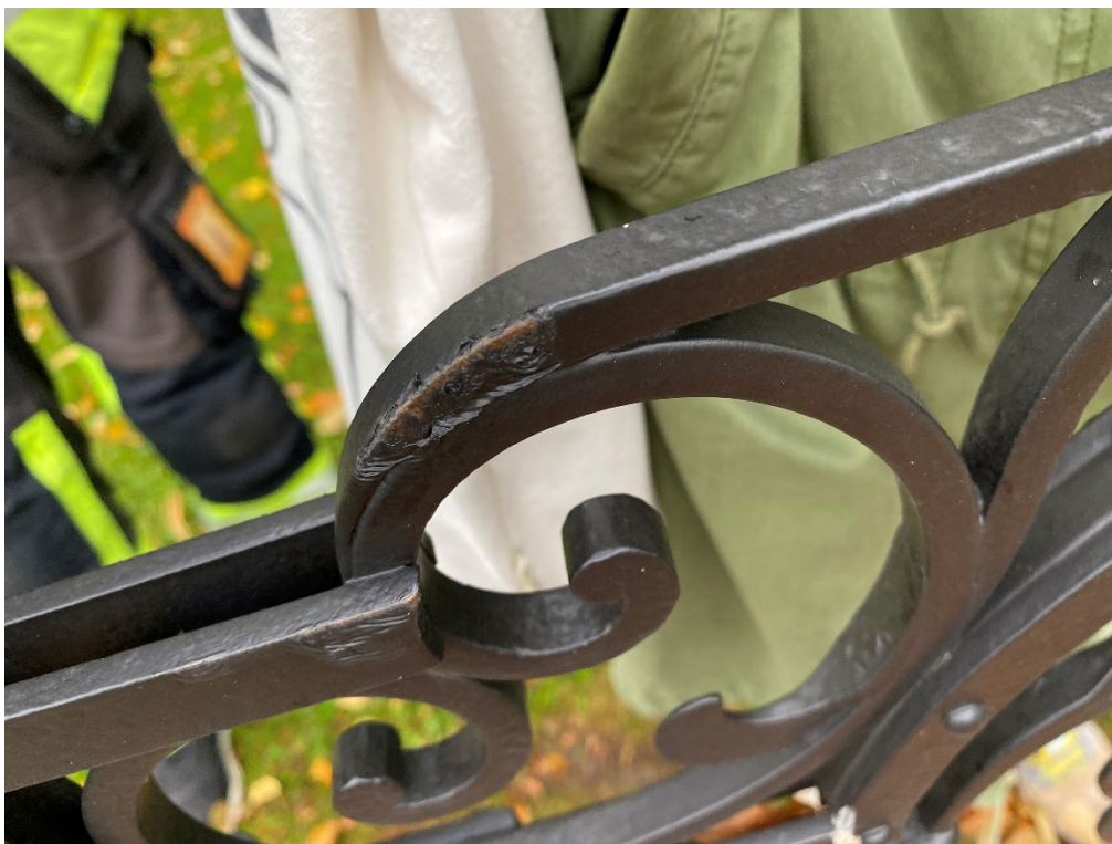
Figur 16. GK06 0450 efter åtgärd. Ett exempel på de skador som uppstår i färgskiktet när staketet transporteras liggande innan färgen helt har härdat. Liknande skador finns på flera staket och kommer att släpas släta och bättras på plats. Foto: Ulrika Olsson, 2023-09-29.
