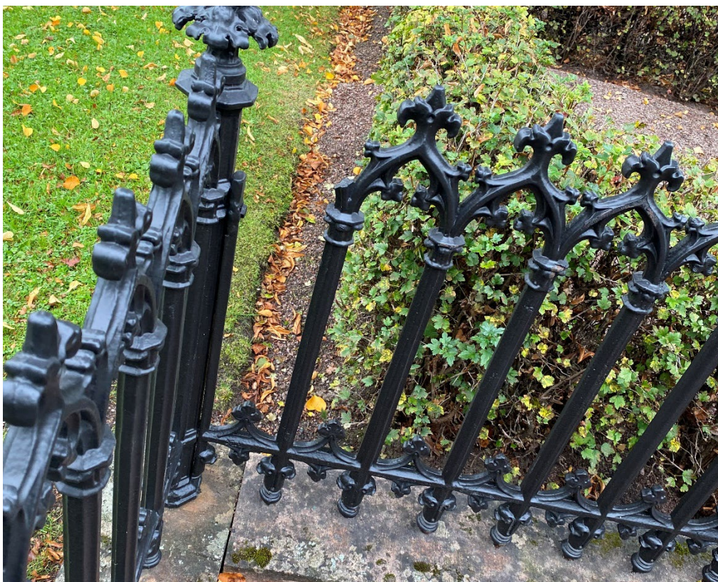
Figur 19. GK05 0135 efter åtgärd. Gjutjärnsstaketets lösa delar har monterats ihop. Fotot visar ett exempel på saknad del som lämnats utan åtgärd. Foto: Ulrika Olsson, 2023-09-29.
