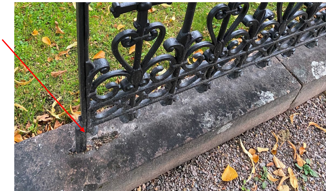
Figur 6. GK06 0089 efter åtgärd. Gjutjärnsstaketet krävde mycket svetsarbeten. Ett diskret stöd har tillkommit vid grindöppningens högra sida. Foto: Ulrika Olsson, 2023-09-29.
