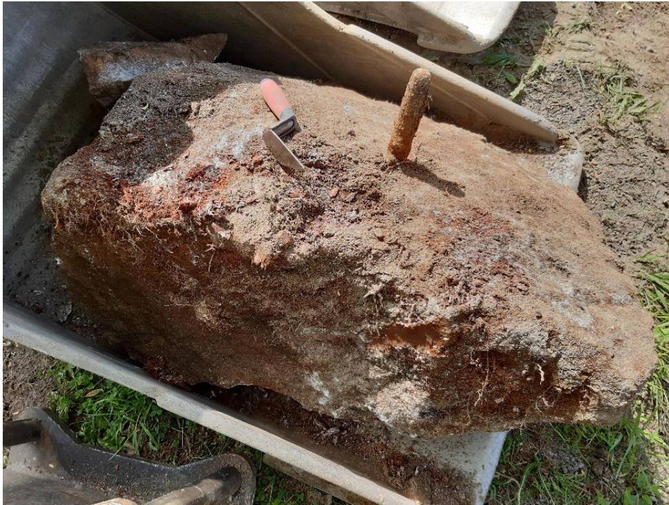
Figur 10. Stenen med korroderat rundjärn som påträffades av maskinisten i nära anslutning till strandskoningen.
