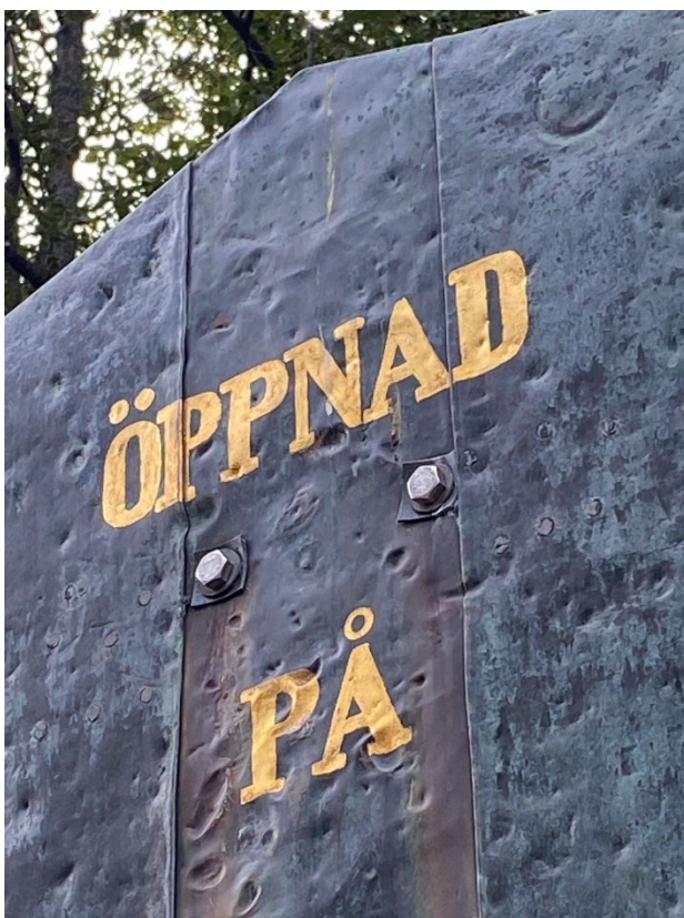
Figur 19. Järnets infästning på framsidan. Blybrickor sitter mellan skruvarna och plåten. Foto: Ulrika Olsson, 2023-09-26.
