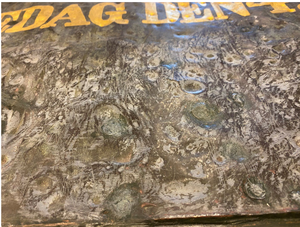
Figur 13. Kulhål har tätats med bly som därefter har patinerats in i plåtens kulör. Foto: Ulrika Olsson, 2023-03-17.
