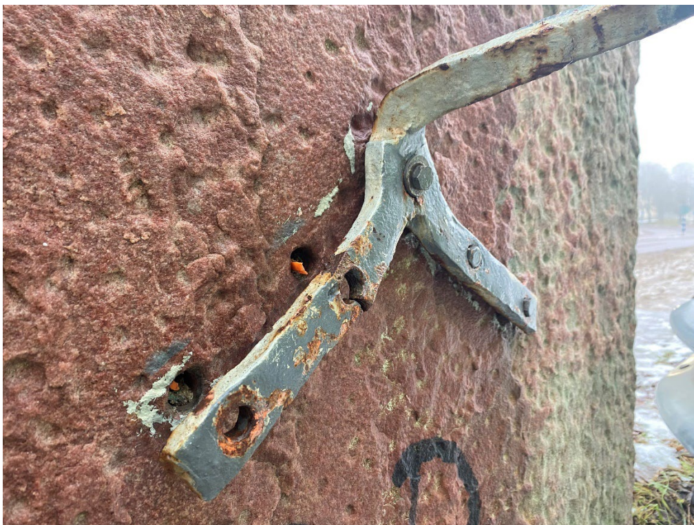
Figur 8. Infästningen av smidesjärnet i fundamentet var undermåligt. Flera skruvar saknades. Foto: Ulrika Olsson, 2023-01-09.
