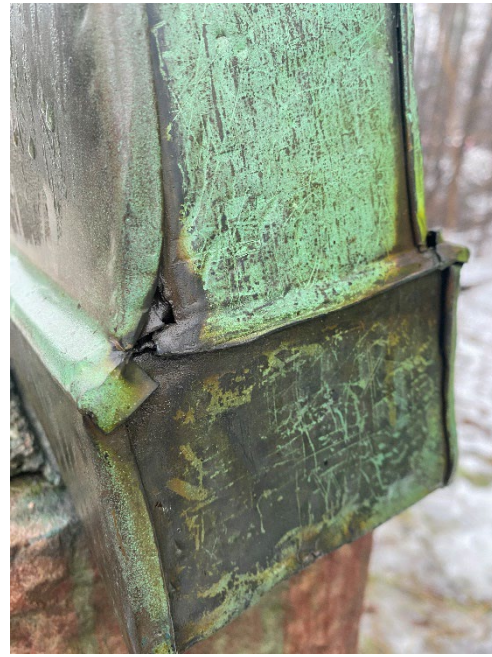
Figur 6. Fukt har trängt in till trästommen bland annat på grund av falsar som gått isär. Foto: Ulrika Olsson, 2023-01-09.
