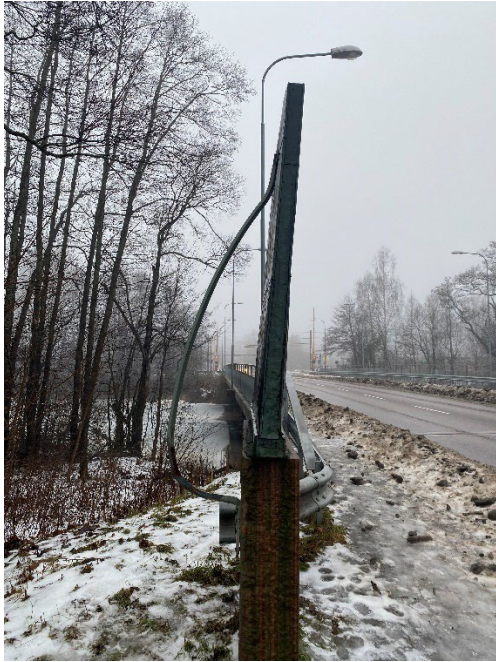
Figur 3. Besiktning på plats innan minnestavlan skulle demonteras. Tavlan lutade framåt. Foto: Ulrika Olsson, 2023-01-09.
