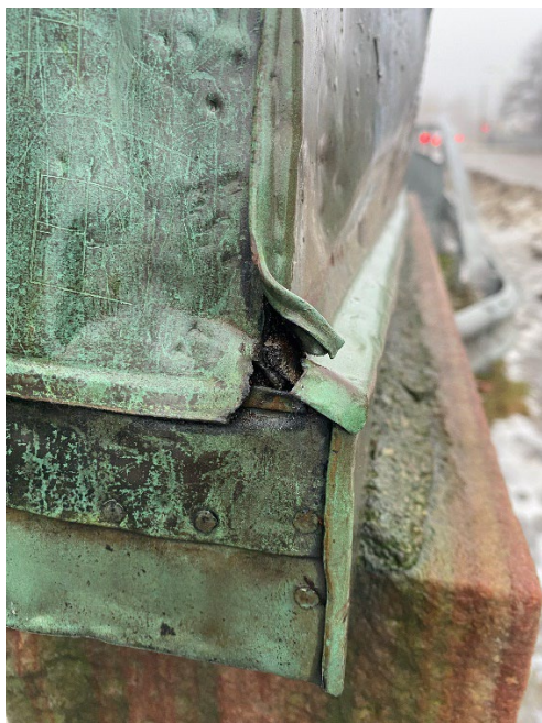
Figur 5. Fukt har trängt in till trästommen bland annat på grund av falsar som gått isär. Foto: Ulrika Olsson, 2023-01-09.
