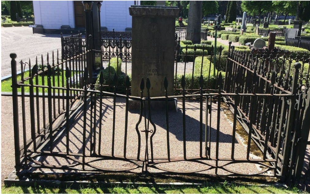
Figur 2. GK03 0070 före åtgärd. Smidesstaket i behov av renovering. Stensockel i behov av riktnig. Foto: Kyrkogårdsenbeten, Gävle församling, hösten 2020.
