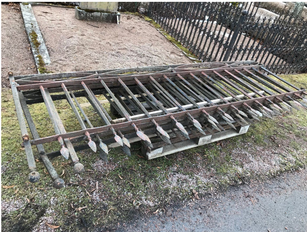
Figur 3. GK03 0070 före åtgärd. Smidesstaket i behov av renovering. Stensockel i behov av riktnig. Foto: Pirab, våren 2023.
