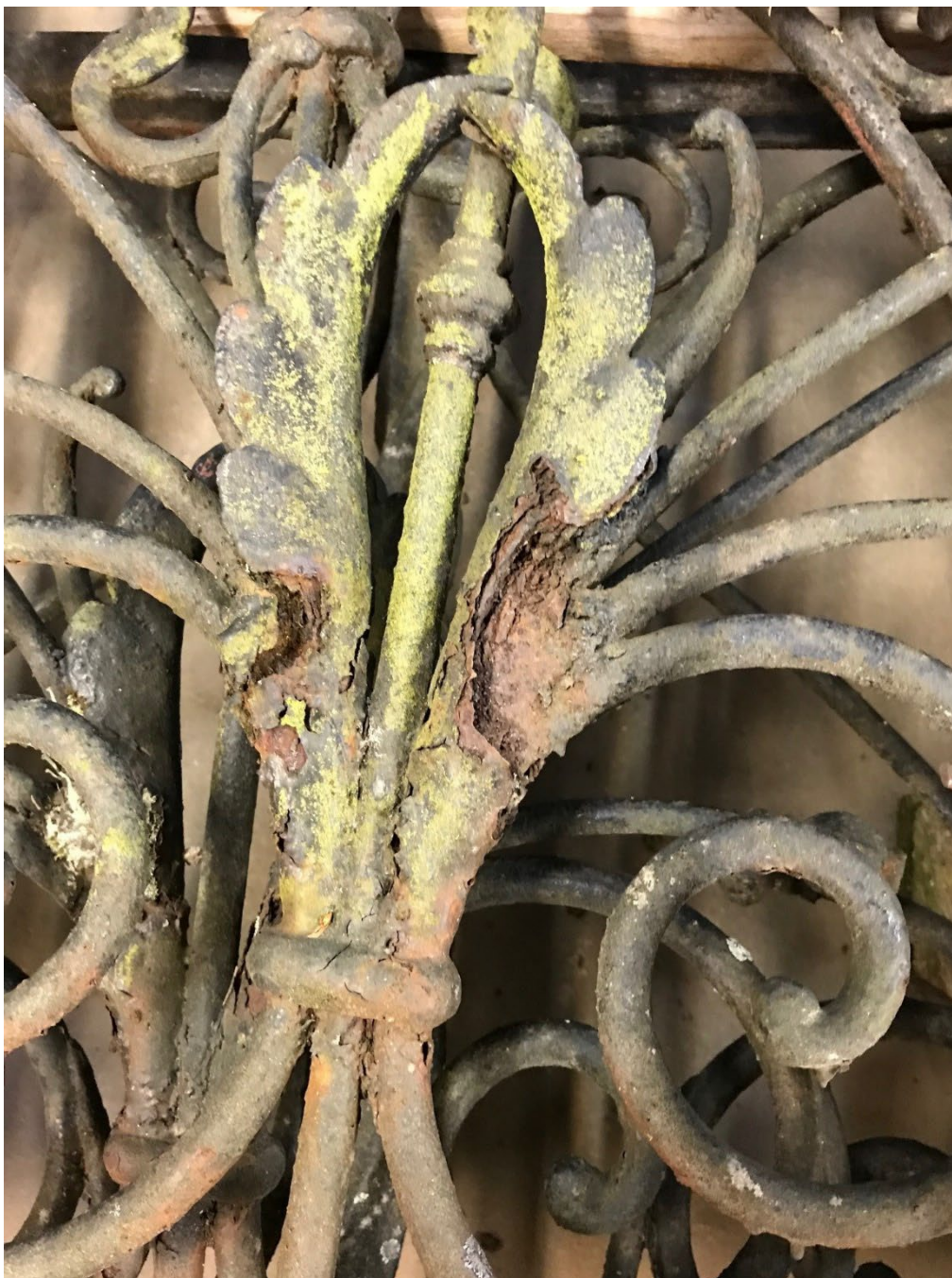
Figur 14. GK05 0124 före åtgärd. Vissa delar av staketet uppvisade kraftiga rostangrepp. Foto: Pirab, våren 2023.
