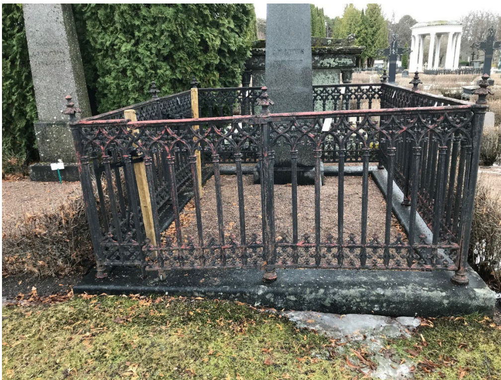
Figur 10. GK05 0007 före åtgärd. Gjutjärnsstaket i behov av renovering. Stensockel i behov av riktning. Foto: Pirab, våren 2023.
