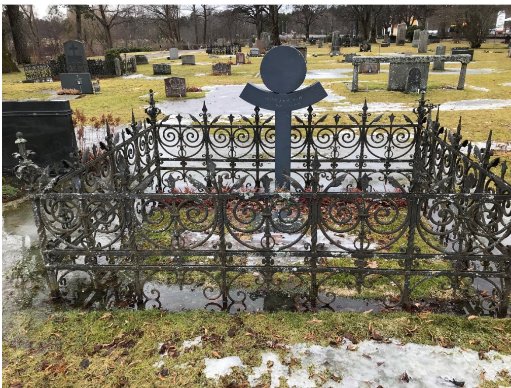
Figur 26. GK06 0258 före åtgärd. Smidesstaket i behov av renovering. Stensockel i behov av riktning. Foto: Pirab, våren 2023.
