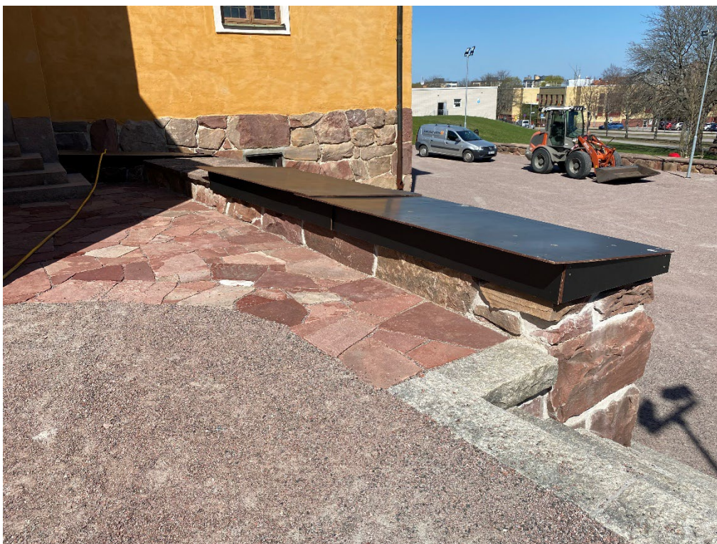
Figur 8. Innan påbörjade arbeten. Lock saknas ännu på den tidigare åtgärdade muren söder om koret. Foto: Ulrika Olsson, 2023-05-11.
