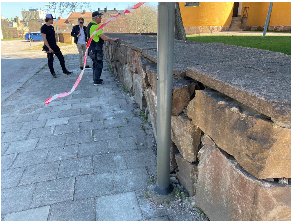
Figur 5. Innan påbörjade arbeten. Muren mot norr var bitvis i mycket dåligt skick. Hans Bergsten från Närkesten inspekterar muren ihop med David Deutsch från Belfor och Robert Edman från KFS AB. Foto: Ulrika Olsson, 2023-05-11.
