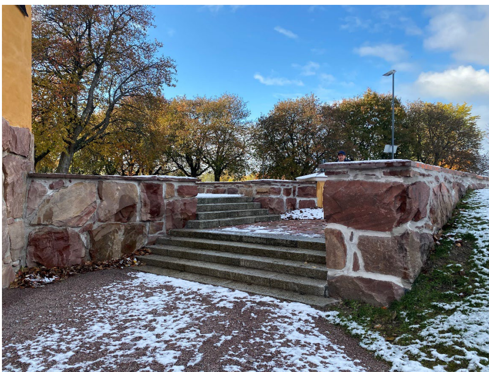
Figur 19. Muren nordöst om sakristian. Denna var fogad sedan tidigare, men saknade lock. Locken har åtgärdats inom denna etapp. Foto: Ulrika Olsson, 2023-10-19.
