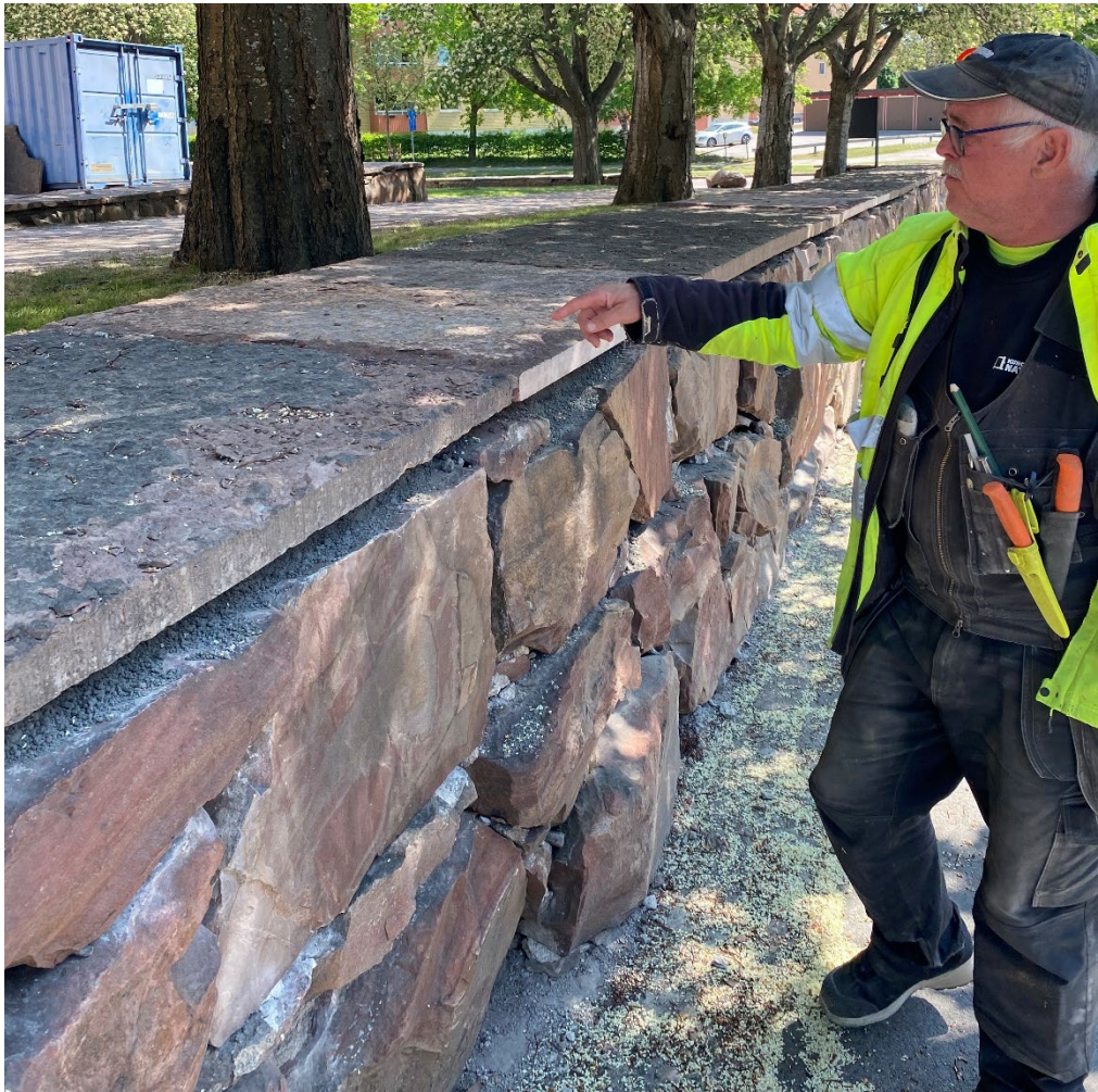
Figur 11. Under pågående arbeten. Hans Bergsten från Närkesten visar en av de nya lockhällarna. Stenarna levereras med sågade kanter. Nästa säsong ska kanterna lägerhuggas likt omkringliggande ursprungliga lock. Foto: Ulrika Olsson, 2023-06-07.
