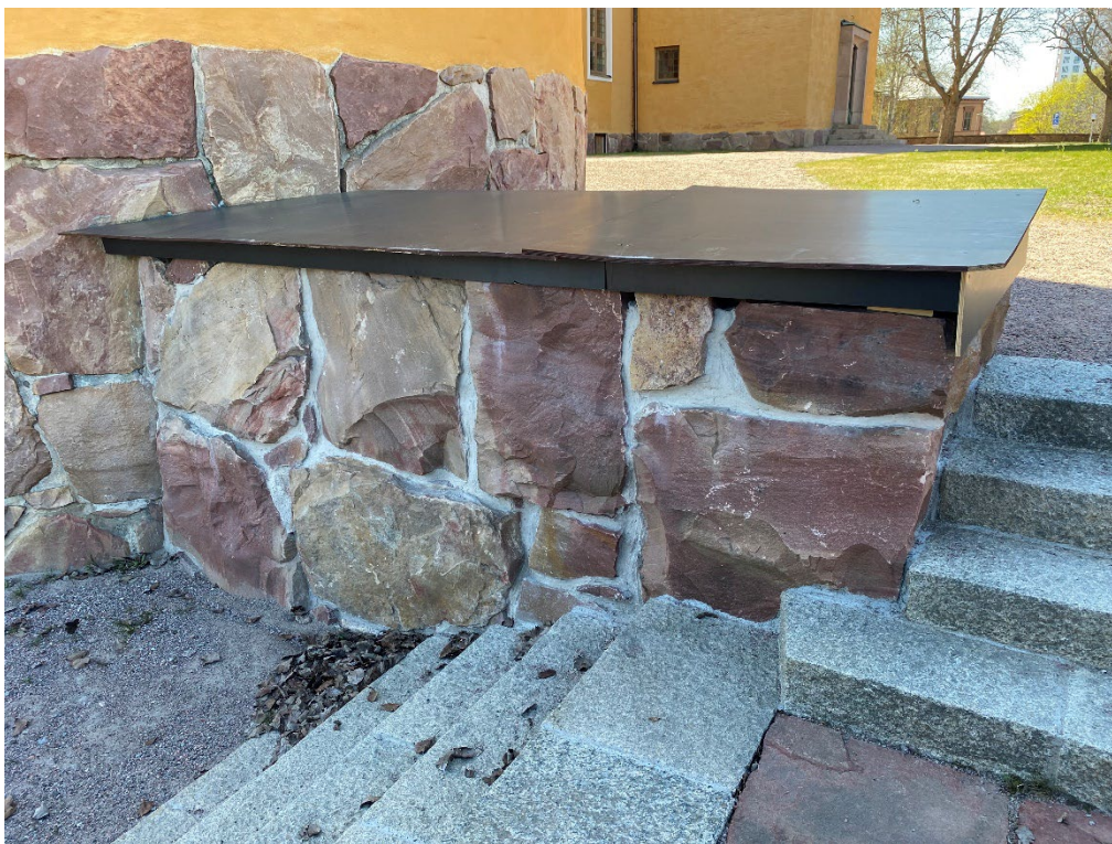
Figur 7. Innan påbörjade arbeten. Några lock på muren nordöst om sakristian saknas. Muren är dock åtgärdad och fogad i samband med det stora renoveringsprojektet, 2019–2022. Fogytorna tjänar som referens. Foto: Ulrika Olsson, 2023-05-11.
