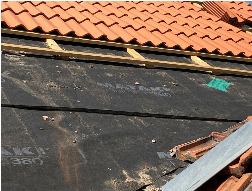
Figur 13. Under pågående takomläggning på huvudbyggnadens tak. Här syns takduken, läkten och det nya tvåkupiga lerteglet från Monier. Foto: Ulrika Olsson, 2023-06-12.
