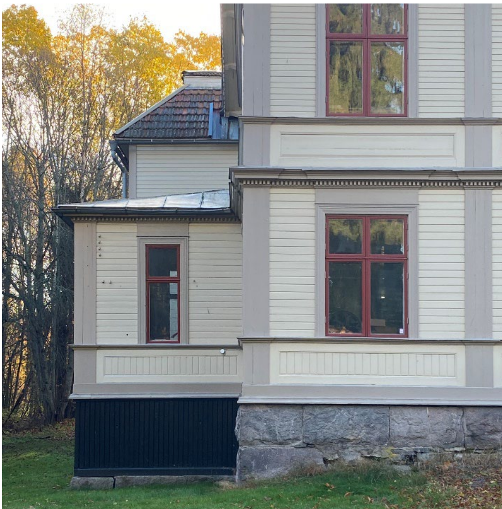
Figur 9. Den låga utbyggnaden på huvudbyggnadens norra gavel innan påbörjade arbeten. Notera även plåtinklädnaden mellan taken på den nordöstra flygeln och huvudbyggnaden. Foto: Ulrika Olsson, 2022-10-18.
