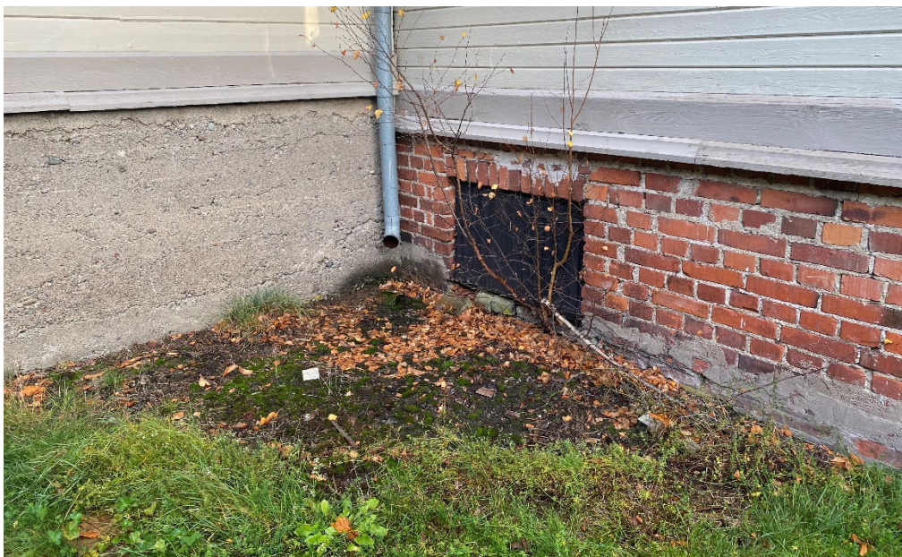
Figur 8. Hörnet mellan den låga sammanbindande delen och den nordöstra flygeln. Markytan mellan flyglarna var fuktig och marken under vissa stuprör hade i det närmaste underminerat murarna. Foto: Ulrika Olsson, 2022-10-18.
