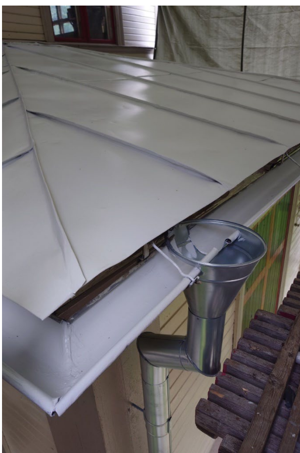
Figur 29. Närbild på taket på den lilla utbyggnaden på huvudbyggnadens norra gavel. Närbild på renoverad plåttäckning. Plåten är målad i kulör zinkgrå. Vattkuper och stuprör är nya i zinkmagnesium. Foto: Ulrika Olsson, 2023-08-31.
