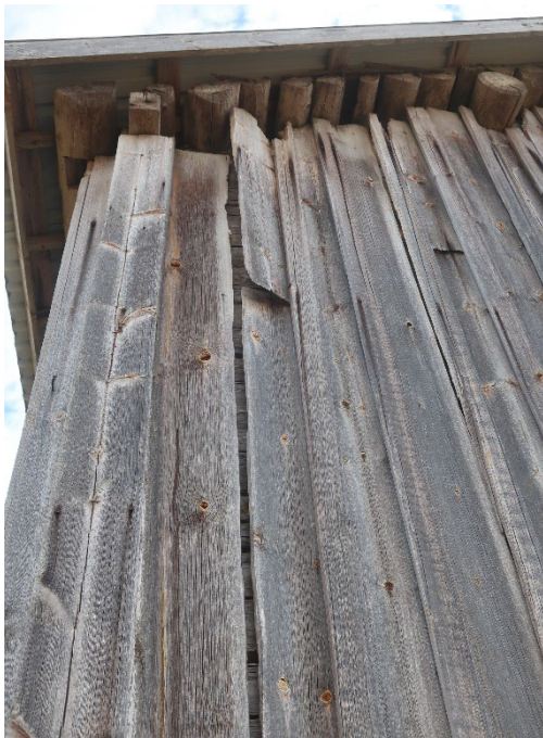
Figur 9. Detalj av skadad panel på härbret. Foto: Daniel Olsson 2022-08-31.
