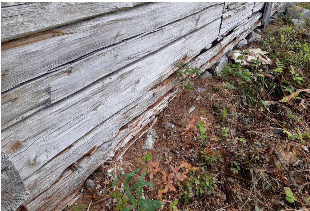
Figur 12. Detalj av vagnsbodens syllstock mot nordväst där virket legat helt emot jorden. Foto: Daniel Olsson 2022-08-31.
