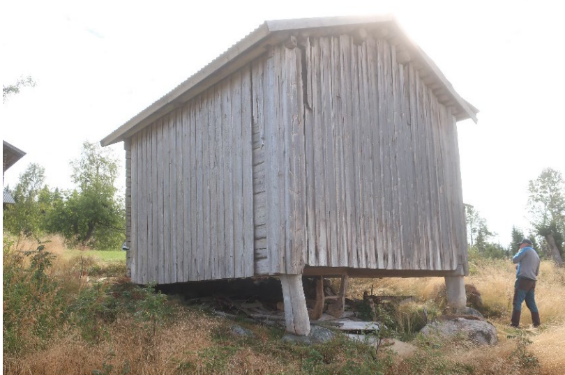
Figur 11. Härbret från väster med skadad panel och lutande stolpar. Foto: Daniel Olsson 2022-08-31.
