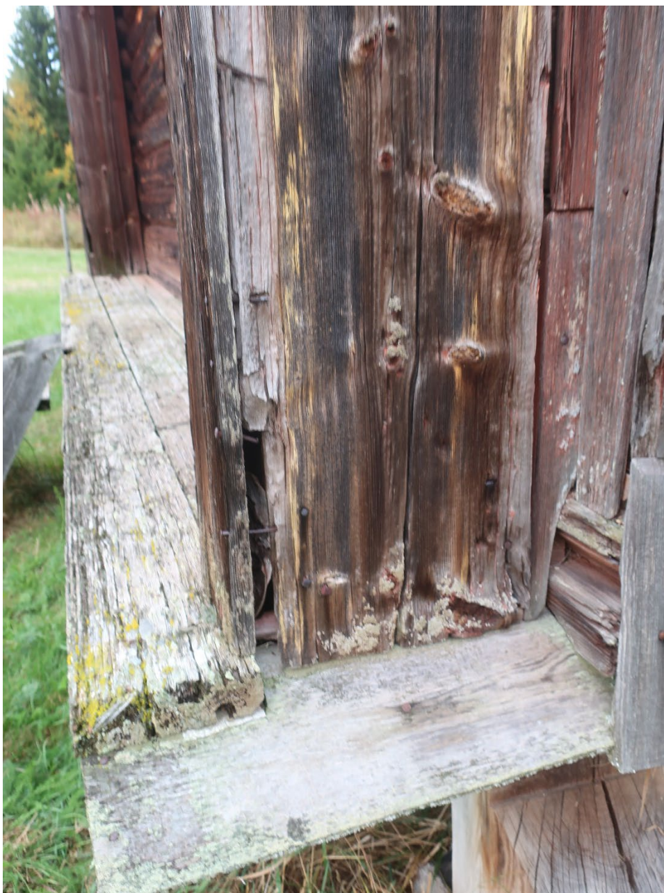
Figur 15. Detalj av svalens yttersta del med rötskadade brädor och skadad och otät knutlåda. Foto: Daniel Olsson 2020-09-16.
