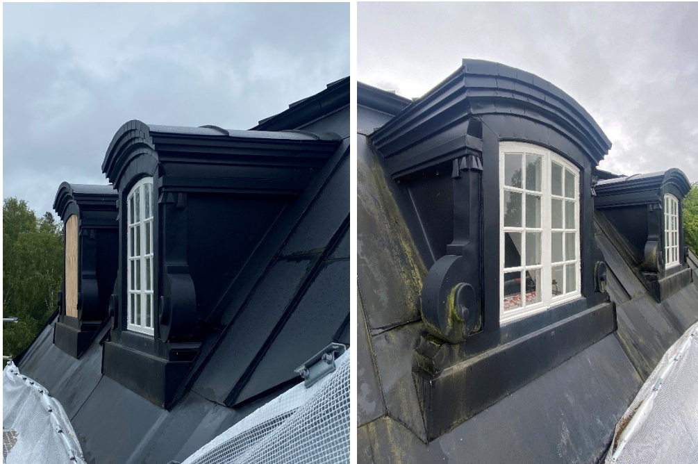
Figur 15 och 16. Under pågående renovering av fönsterbågarna i takkuporna. Tre av fyra fönsterenheter är färdigställda. Foto: Ulrika Olsson, 2023-07-04.
