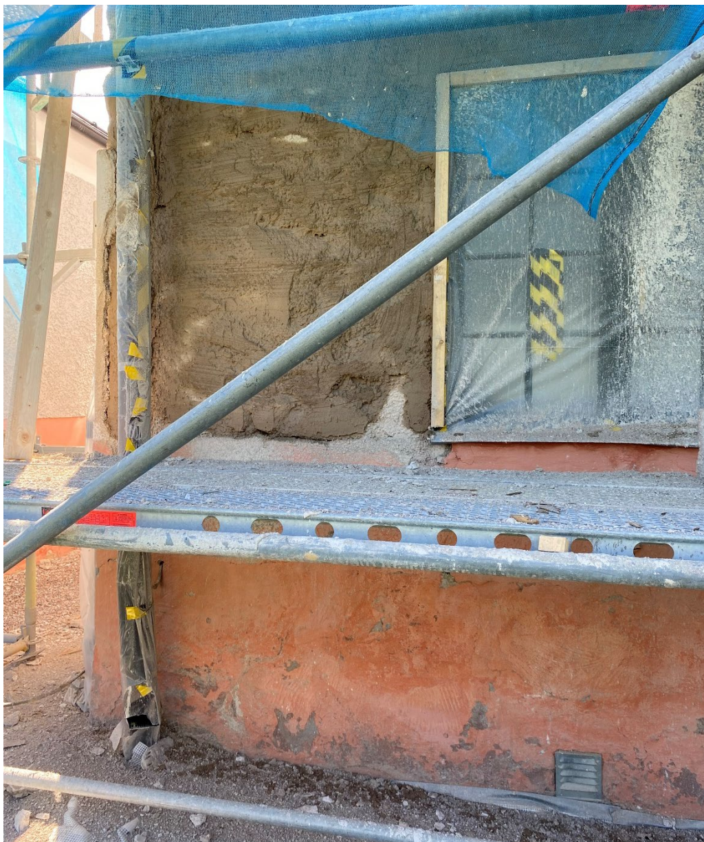
Figur 9. Omputsning pågår. Här syns också den rosafärgade sockeln innan påbörjad renovering. Foto: Ulrika Olsson, 2023-05-30.
