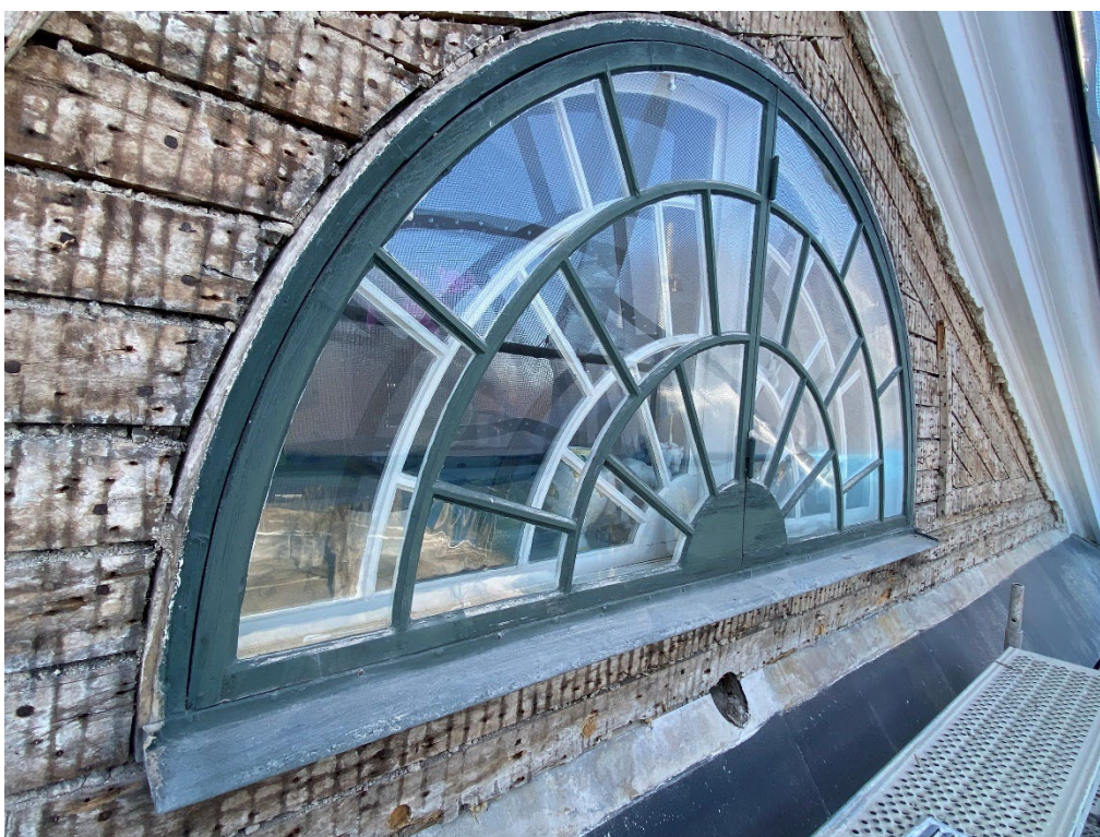
Figur 7. Under pågående arbeten. Lunettfönstret i frontonen. Här syns att den profilerade takfoten kunde renoveras utan att den till fullo behövde knackas ner. Foto: Ulrika Olsson, 2023-04-18.
