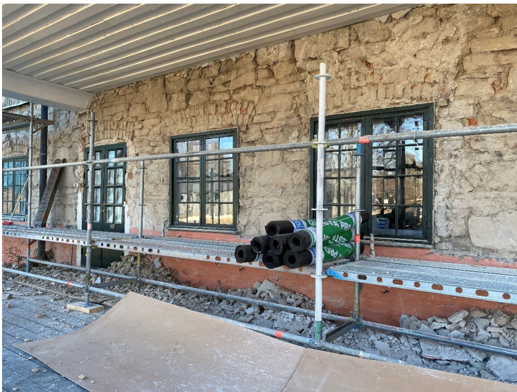
Figur 8. Under pågående arbeten. Bottenvåningens murade stomme är frilagd från spritputsen. Foto: Ulrika Olsson, 2023-04-18.
