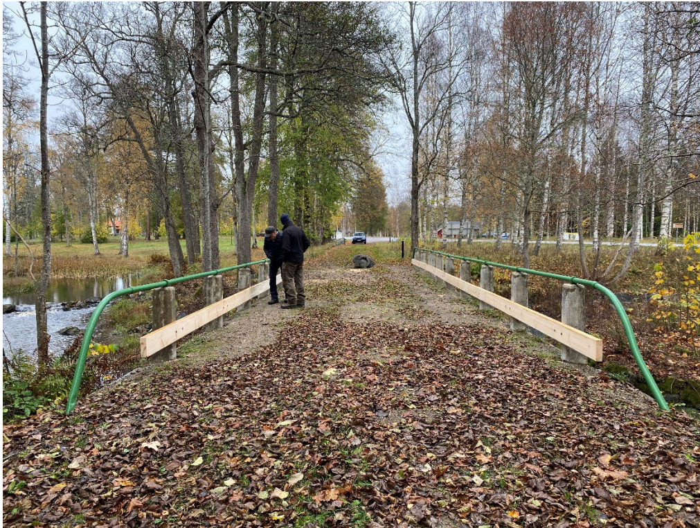
Figur 5. Vid slutbesiktningen av betongbrons räcken. Överst syns de kromgröna rörföljarna som vilar på betongardister. På dessa sitter navföljare i trä monterade. Foto: 2021-10-19.
