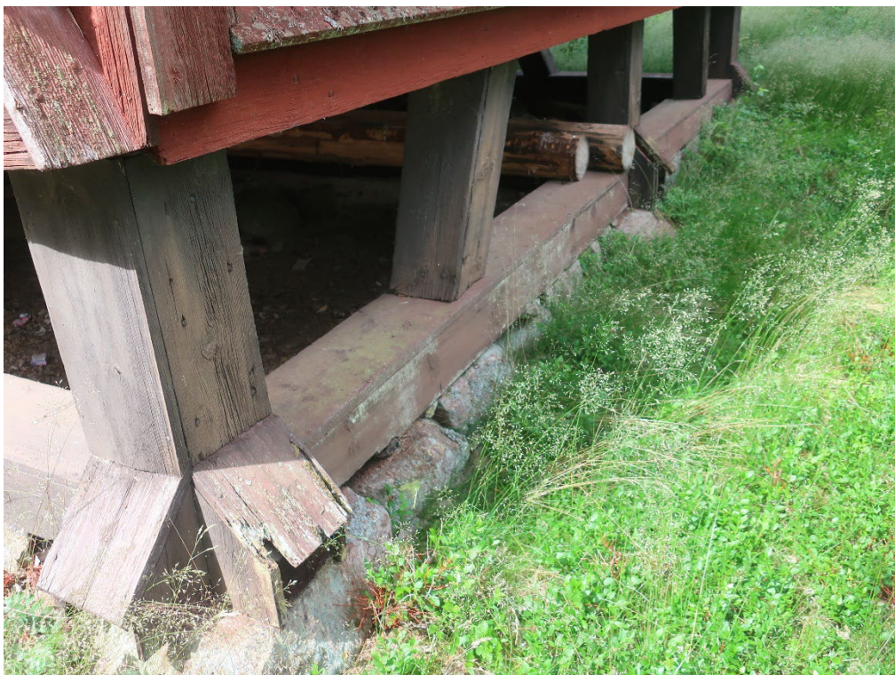
Figur 7. Detalj av syllramen med skadade täckbrädor. Foto: Daniel Olsson 2022-07-05.
