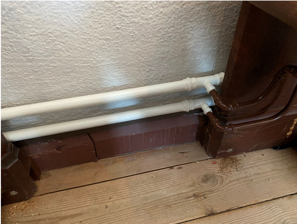
Figur 11. De inmålade rören efter väggen och mot bänkvärmaren. Foto: Ulrika Olsson, 2024-02-05.
