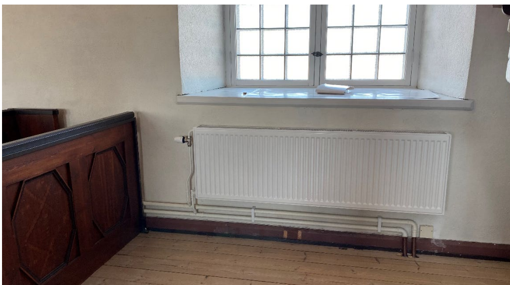
Figur 6. Den nya radiatoren på den norra sidan. Under radiatoren går rören upp genom gamla håltagningar i golvet. Foto: Ulrika Olsson, 2024-02-05.
