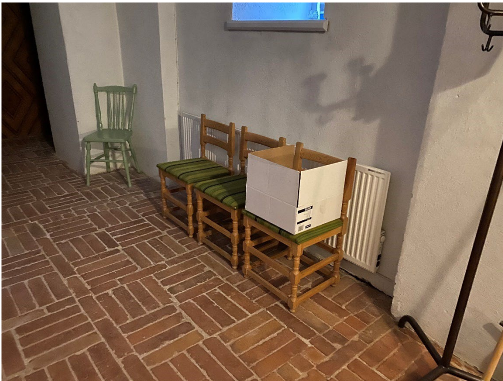
Figur 23. Vapenhusets södra del innan påbörjade arbeten. Radiatorn var monterad mot ytterväggen. Foto: Ulrika Olsson, 2022-11-29.
