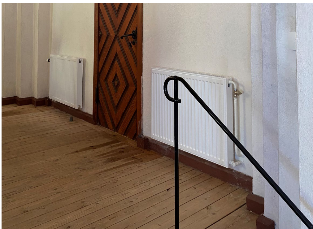
Figur 18. Korets södra sida vid slutbesiktningen. Två nya radiatorer har monterats på vardera sidan om dörren som leder in till sakristian. Foto: Ulrika Olsson, 2024-02-05.
