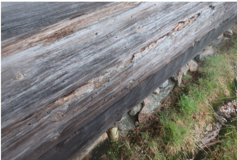
Figur 12. Detalj av vallstugans sydvästra fasad (vägg A) öster om ytterdörren med skador efter insektsangrepp. Foto från väster. Foto: Daniel Olsson 2021-05-17.
