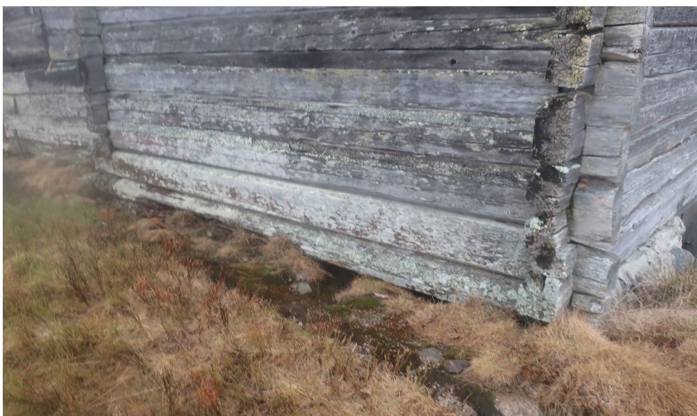
Figur 11. Detalj av den norra delen av vallstugans nordöstra fasad (vägg C) med hög marknivå och rötskadad fyllnadsstock under syllstocken. Foto från norr: Daniel Olsson 2021-05-17.
