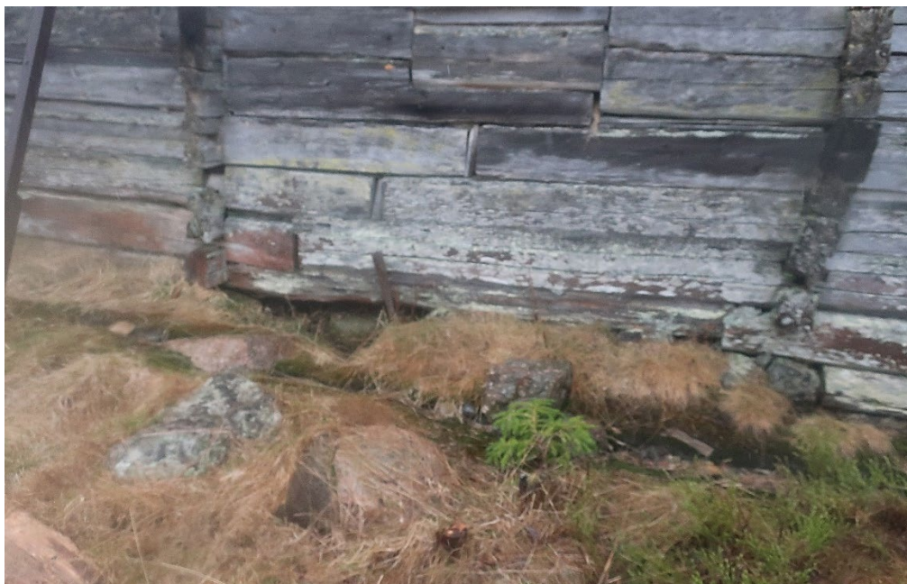
Figur 10. Detalj av den mittersta delen av vallstugans nordöstra vägg (vägg C) med hög marknivå och rötskadade stockar längst ned. Foto från nordöst: Daniel Olsson 2021-05-17.
