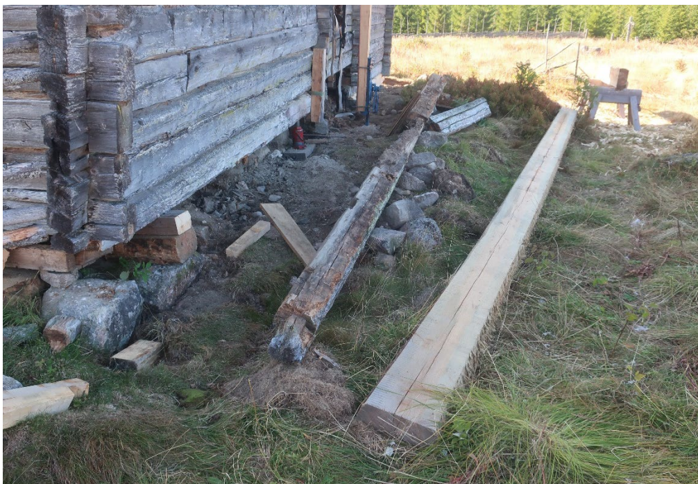
Figur 16. Framtagning av ny syllstock till vallstugans nordvästra vägg (vägg C). Till vänster om denna ligger den rötskadade syllstocken. Foto från öster. Foto: Daniel Olsson 2021-09-15.
