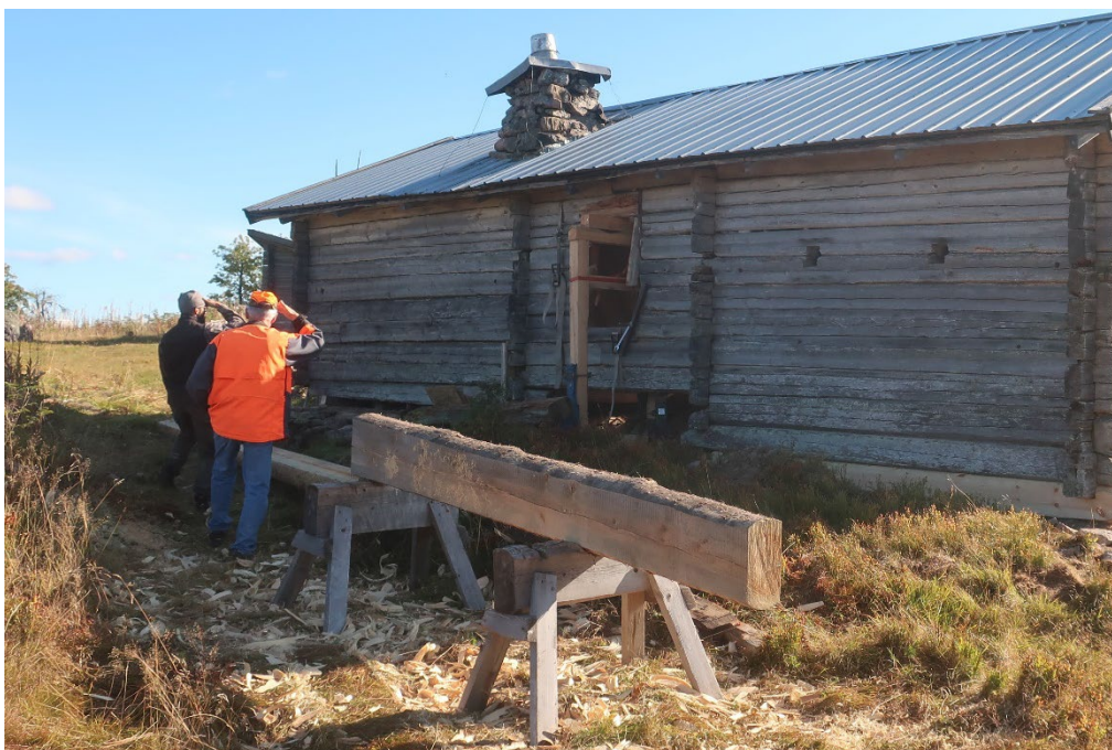
Figur 15. Timmerman Anders Bekkos och fastighetsägare Leif Karlsson under pågående renovering av vallstugans nordvästra vägg. Foto från norr. Foto: Daniel Olsson 2021-09-15.
