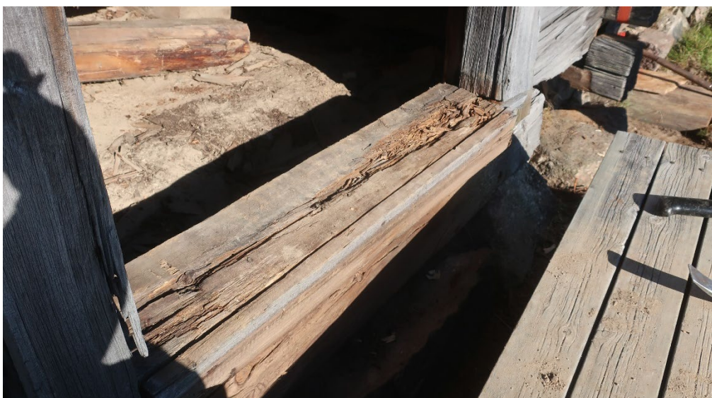
Figur 13. Detalj av rötskada i tröskeln vid vallstugans ytterdörr. Foto från väster. Foto: Daniel Olsson 2021-09-15.
