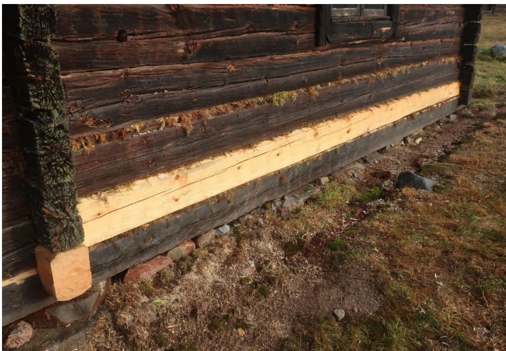
Figur 20. Detalj av den utbytta stocken i vallstugans vägg mot sydväst (vägg A). Till vänster i bild syns den ena änden på den utbytta syllstocken under mellanväggen (vägg F) mellan farstun och stugan. Foto från väster: Daniel Olsson 2021-10-27.
