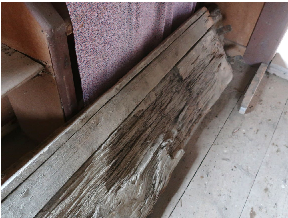
Figur 15. Detalj av den rötskadade baksidan på en bräda som ingått i gravsyllen. Foto: Daniel Olsson, 2022-06-22.
