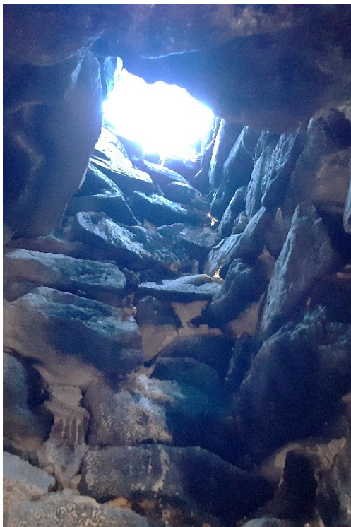
Figur 13. Murstocken sedd nedifrån innan arbetet inleddes. Foto: Daniel Olsson, 2022-05-17.
