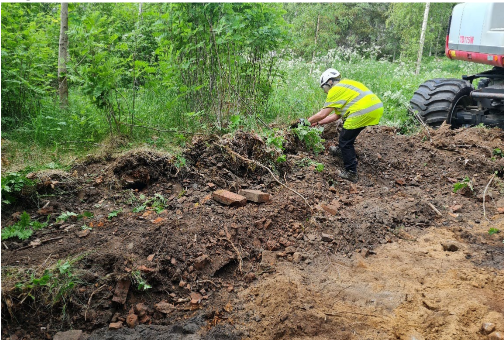
Figur 6. Schaktet fick upptas där det var möjligt utifrån terrängförhållandena, växtligheten och en jordkällare som finns under grunden. Foto från norr: Maria Björck.
