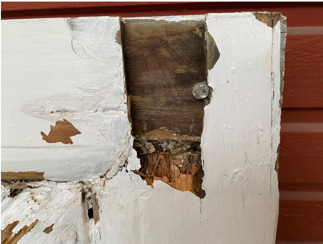
Figur 5. Rötskadorna var mest omfattande i dörrbladets yttre nedre del. På fotot ligger dörren ner. Foto: Ulrika Olsson, Länsmuseet Gävleborg, 2023-10-24.
