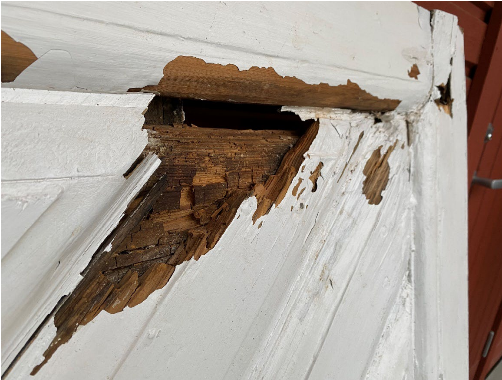
Figur 4. Rötskadorna var mest omfattande i dörrbladets yttre nedre del. På fotot ligger dörren ner. Foto: Ulrika Olsson, Länsmuseet Gävleborg, 2023-10-24.
