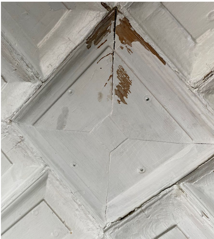
Figur 6. I mittplattan fanns missprydande synliga skruvar. Foto: Ulrika Olsson, Länsmuseet Gävleborg, 2023-10-24.
