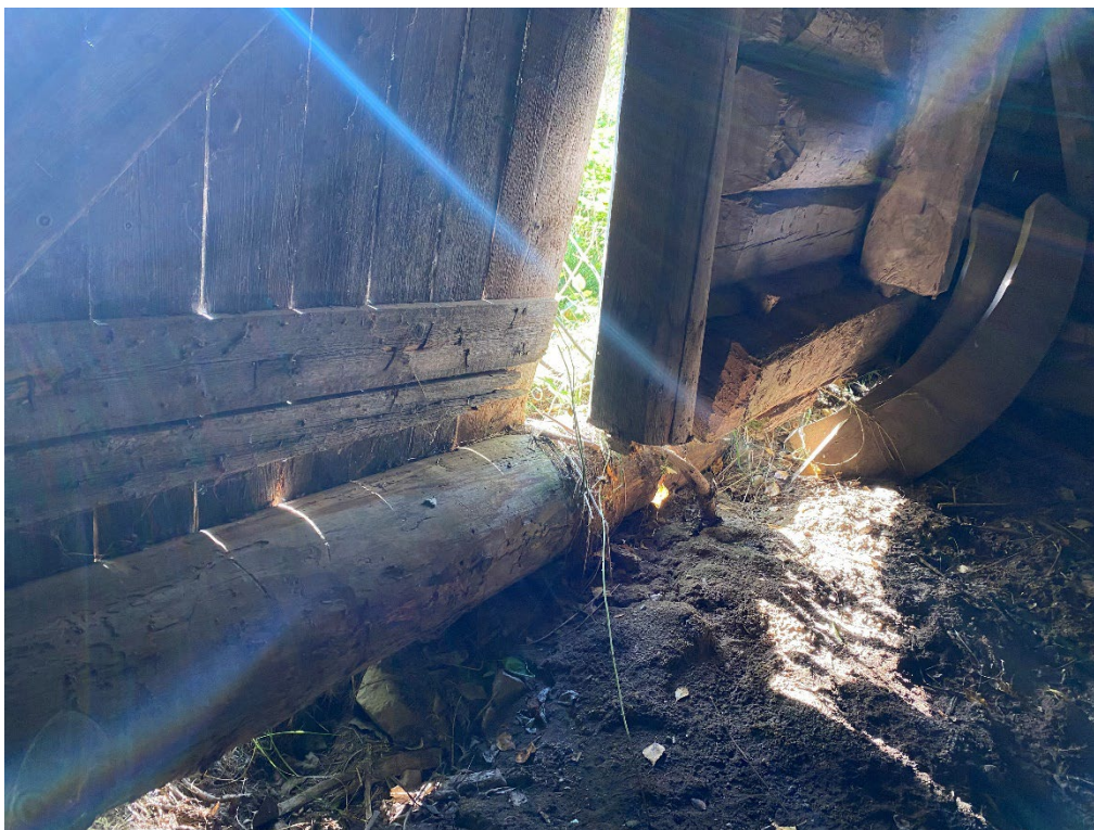
Figur 7. Den sydöstra långsidan innan påbörjade arbeten. Här syns hur de två överlappande sylldelarna hade gått isär. Foto: Ulrika Olsson, 2024-09-13.
