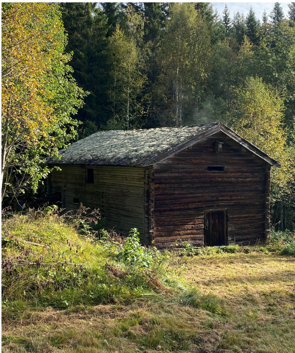
Figur 4. Ålkarsskåkten sedd från sydväst innan påbörjade arbeten. Spåntaket var täckt av mossa och uttjänt. Foto: Ulrika Olsson, 2024-09-13.
