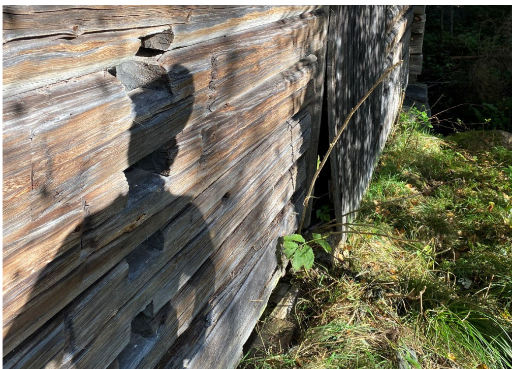
Figur 6. Den sydöstra långsidan innan påbörjade arbeten. De två överlappande sylldelarna hade gått isär. Vid dörren syns hur syllen skjuter ut från fasadlivet. Foto: Ulrika Olsson, 2024-09-13.
