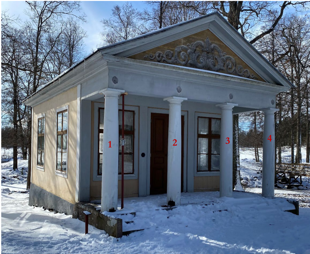
Figur 2. Lusthuset innan påbörjade arbeten. Pelare 1–3 uppvisade kraftiga rötskador medan pelare 4 visade sig vara i gott skick. Foto: Ulrika Olsson, 2024-03-19.
