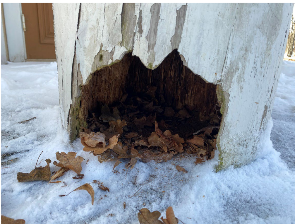
Figur 3. En av pelarna innan påbörjade arbeten. Nederdelen var kraftigt murken. Foto: Ulrika Olsson, 2024-03-19.
