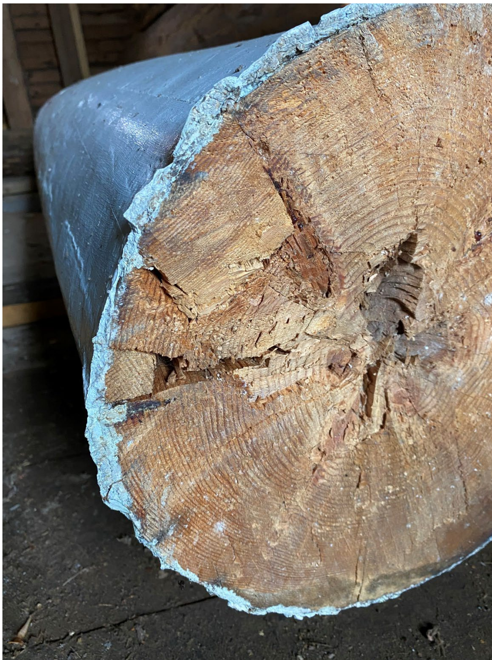
Figur 13. I de demonterade pelarna fanns spår av kilar som slagits i sprickor eller skador av annat slag. Foto: Ulrika Olsson, 2024-09-24.
