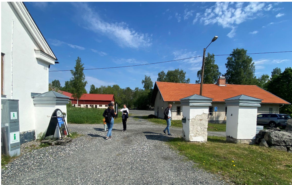
Figur 13. Vid orangeriets östra gavel finns tre grindstolpar som var i behov av underhåll. Den mittersta hade omfattande skador orsakade av påkörning av fordon. Huvarna var från 2010-talet och hade en utformning utan historisk förankring. Foto: Ulrika Olsson, 2024-05-28.
