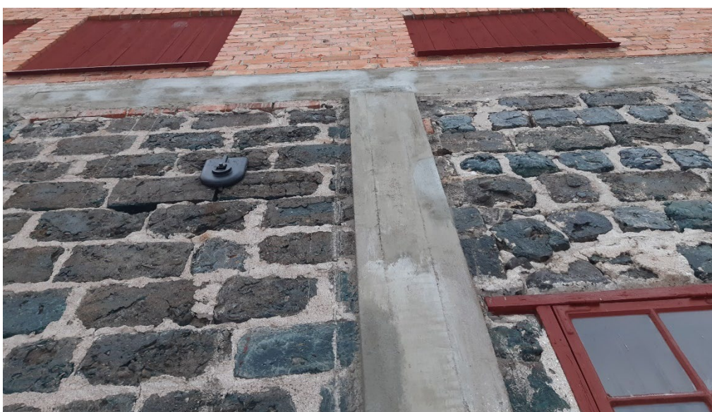
Figur 44. Närbild på lagningar i betongpelare och balkar. Foto: Daniel Olsson, 2024-11-29.
