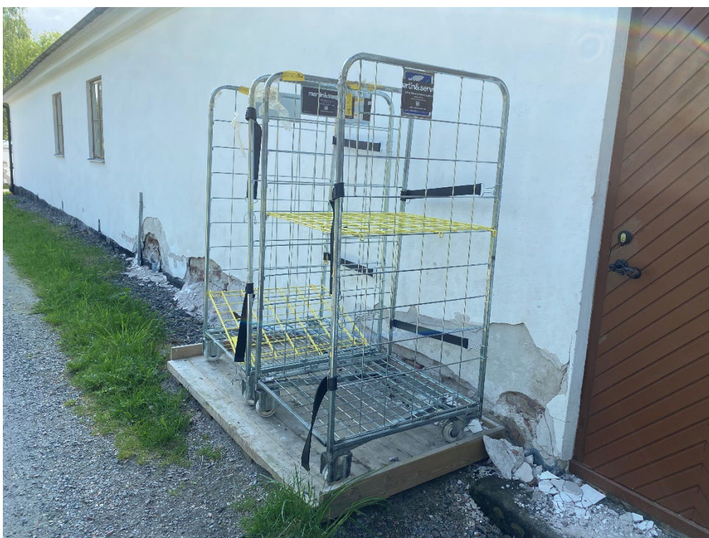
Figur 11. Orangeriets norra sida där intag av varor sker. Vissa av puts-skadorna var mekaniskt orsakade genom att varuvagnarna slagits i fasaden. Orsaken till skadorna bortanför varuvagnen är däremot inte utredda. Foto: Ulrika Olsson, 2024-05-28.
