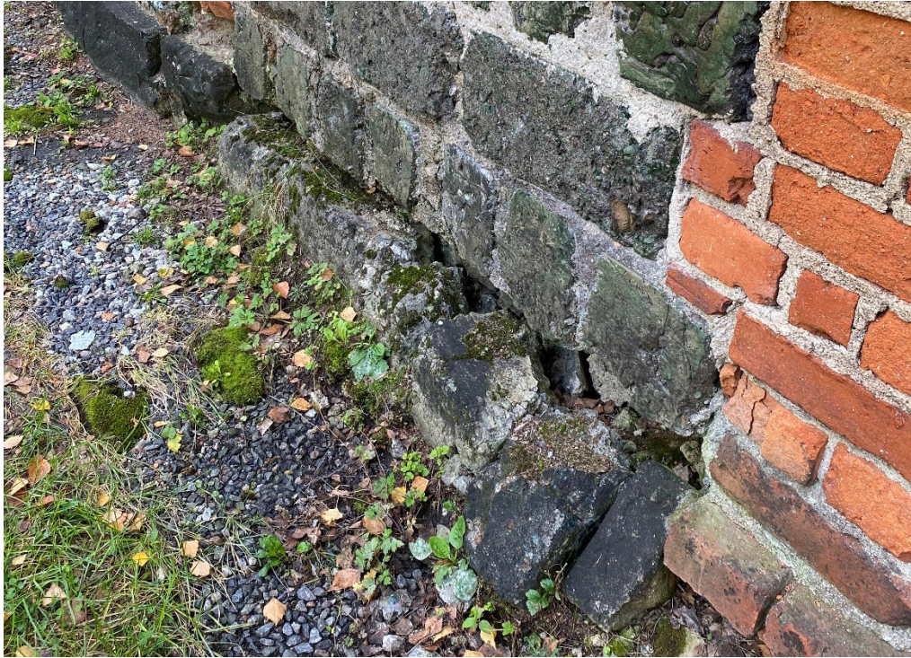
Figur 17. Urfallna sockelstenar på hyttans västra sida. Foto: Ulrika Olsson, 2024-09-18.
