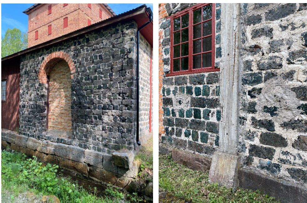
Figur 15 och 16. Slaggstens- och tegeldel på hyttans södra sida var i behov av omfogning. Betongpelare och balkar på hyttans östra och norra sida var sönderspjälkade. Foto: Ulrika Olsson, 2024-05-28.
