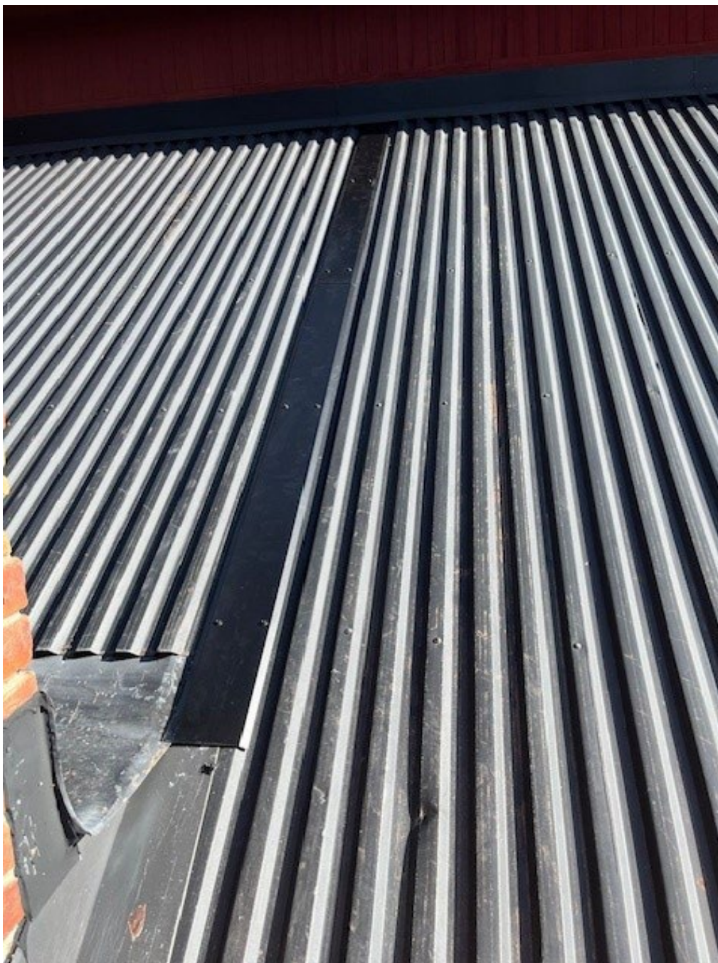
Figur 47. Exempel på komplettering av plåt som har gjorts på hyttans östra sida, där läckage dock fortfarande förekommer. Den svarta plåten överlappar nu de nedre plåtarna som var felmonterade med följd att väta tilläts rinna in. Foto: Anders Löfman, sommaren 2024.
