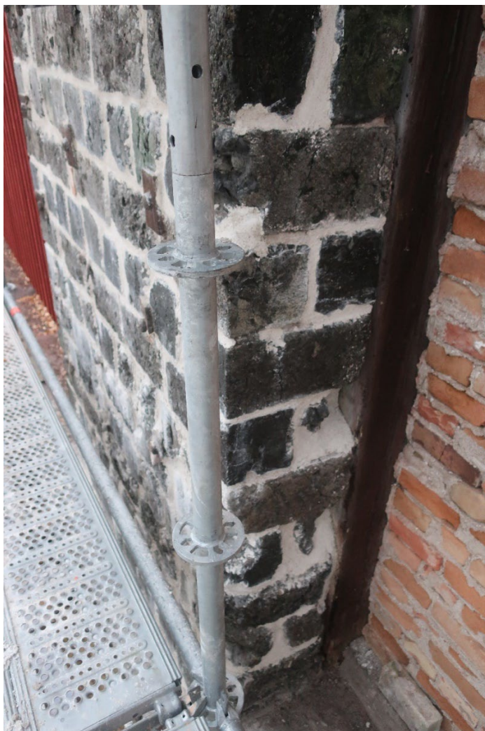
Figur 42. Omfogning har skett på slaggstensmuren på hyttans södra sida. Foto: Daniel Olsson, 2024-11-29.
