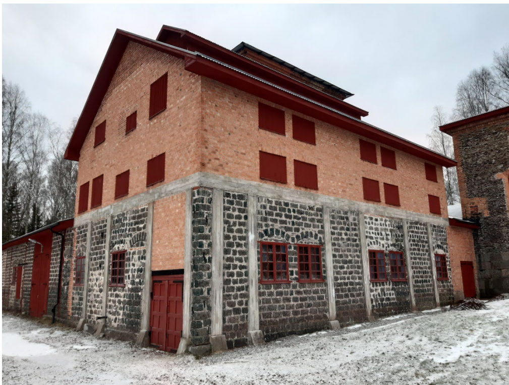
Figur 43. Betongpelare och balkar på hyttans norra och östra sida har lagats. Foto: Daniel Olsson, 2024-11-29.
