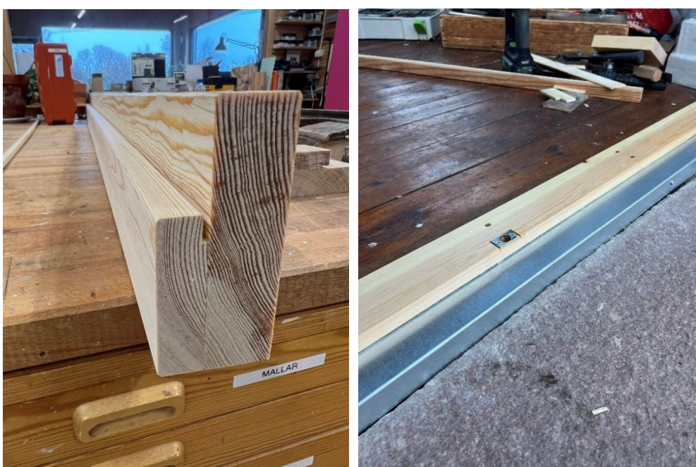
Figur 26 och 27. Den nya tröskeln försågs med ett spår där plåtskoningen leddes in. Framkanten på plåten löper en bit nedanför tröskelns tjocklek så att väta inte når trädelarna. Foto: Heinemanns snickeri, hösten 2024.
