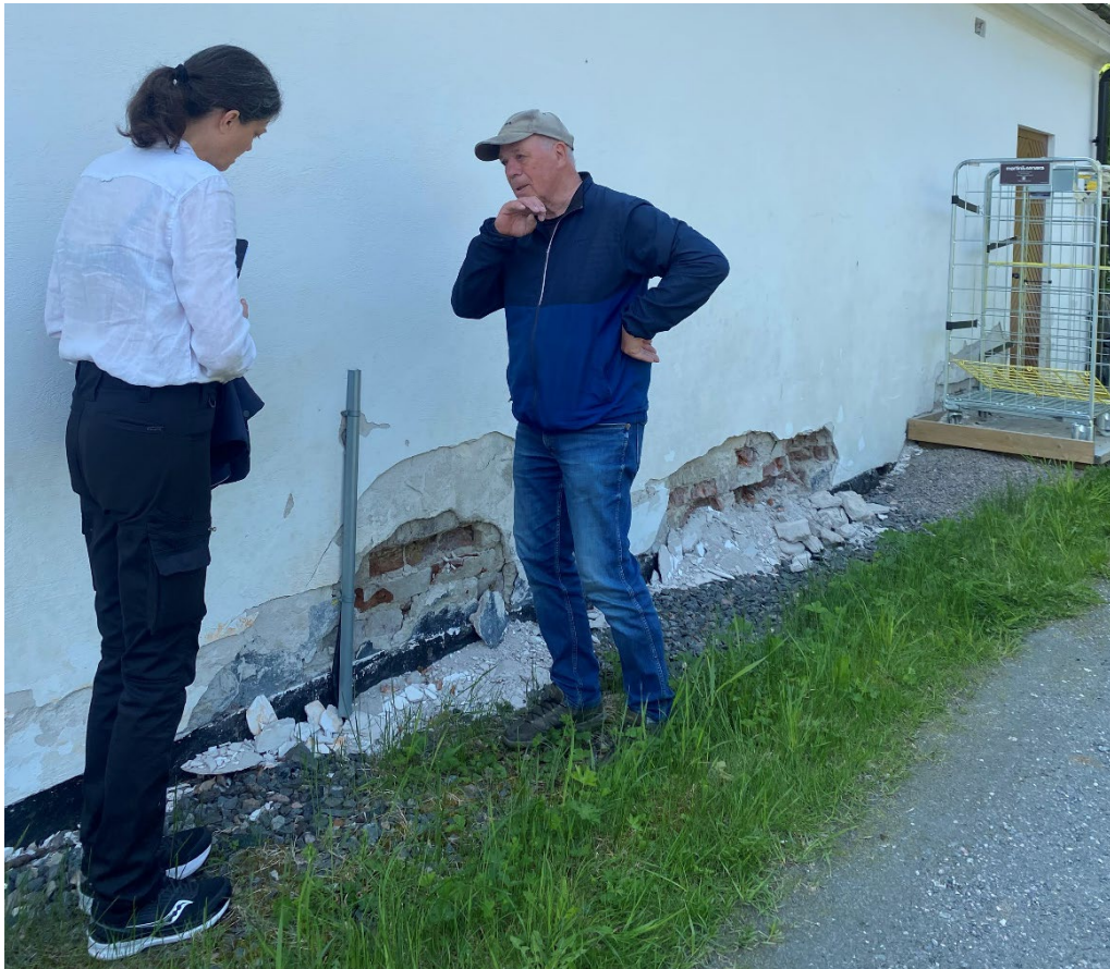
Figur 12. Carina Lindqvist från Länsstyrelsen Gävleborg inspekterar puts-skador på orangeriets norra fasad ihop med Arne Lundin från Föreningen Hyttan. Foto: Ulrika Olsson, 2024-05-28.
