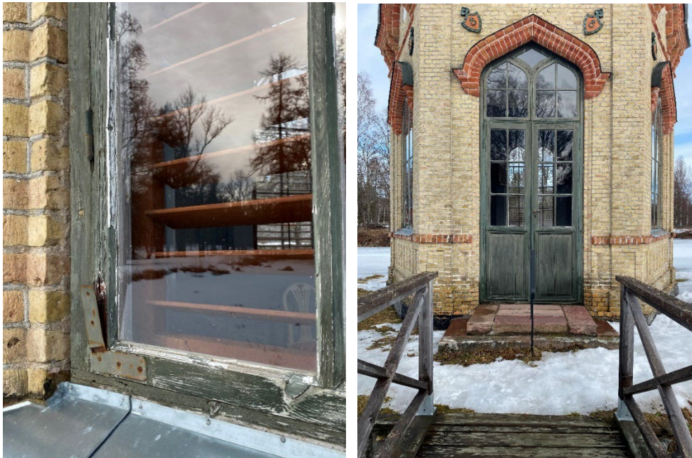
Figur 4 och 5. Skick på fönster och dörrar på lusthuset i samband med läns museets uppdrag att statusbesikta byggnaden. Foto: Ulrika Olsson, 2023-03-31.
