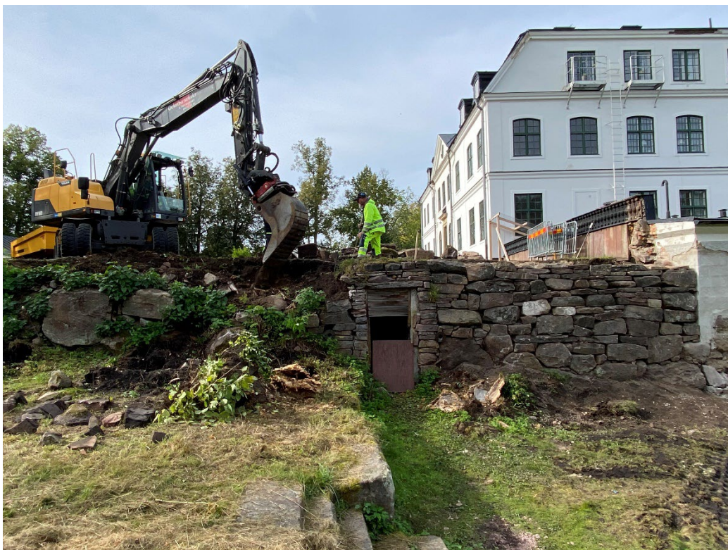
Figur 23. Ugrävningen av kärnan på den södra sidan har påbörjats. Grävningen utfördes både med skopa och för hand. Foto: Ulrika Olsson, 2024-09-18.
