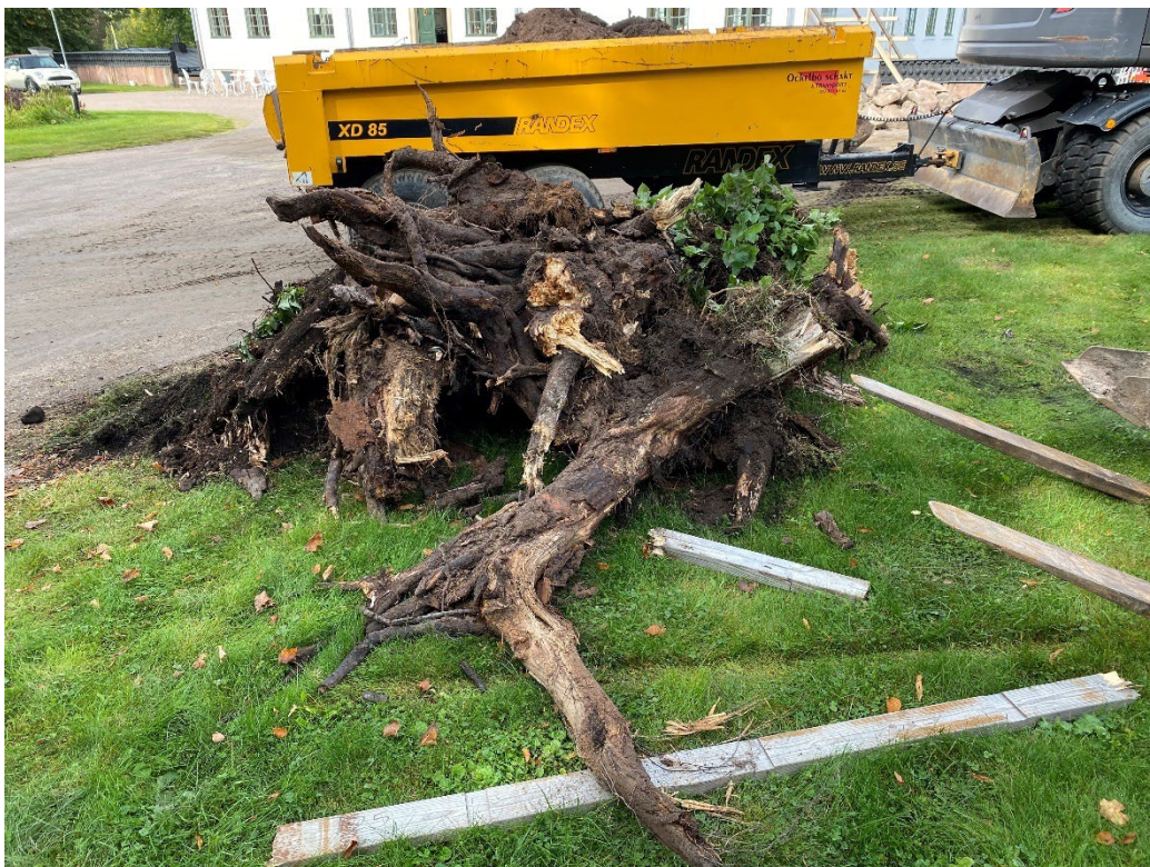
Figur 27. Trärötterna som hade växt i terrassmuren och kärnan var stora och kraftiga. Foto: Ulrika Olsson, 2024-09-18.
