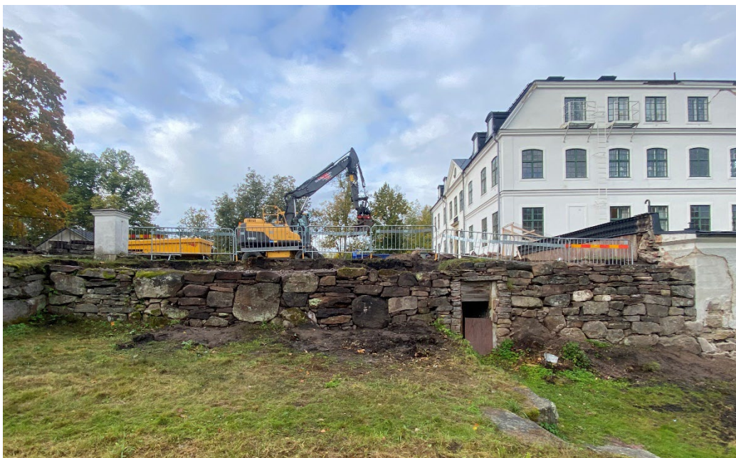
Figur 33. Båda sidorna av terrassmuren är till största del färdigmurade. Ännu återstår att justera sluthöjden på de nylagda delarna. Foto: Ulrika Olsson, 2024-10-01.
