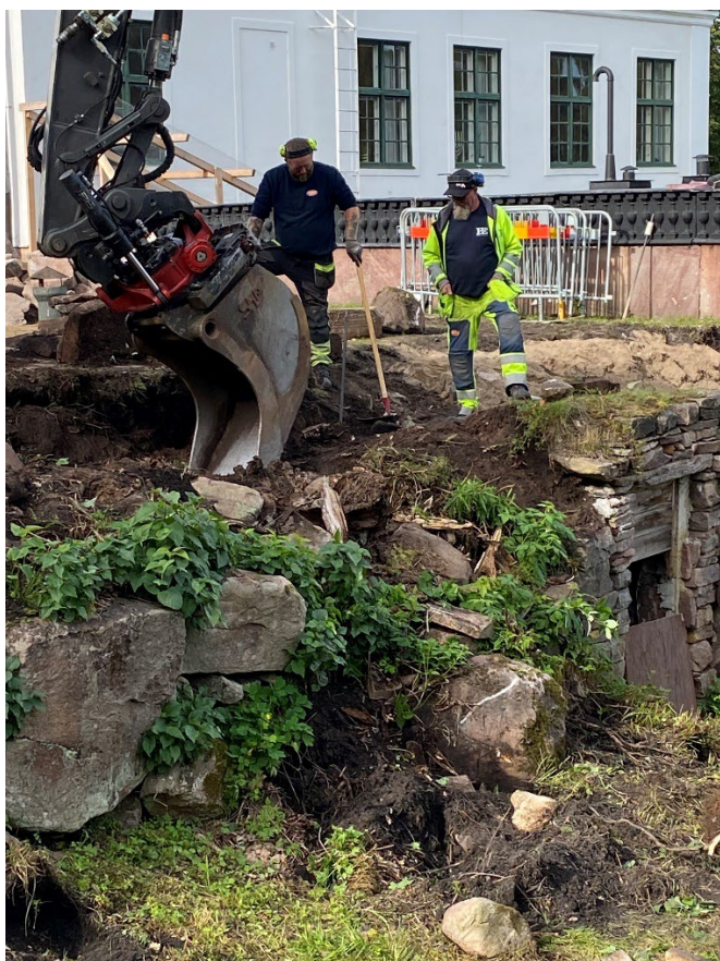
Figur 24. Grävningen med skopa utfördes ytterst varsamt, hela tiden övervakad av stenväggarna som befann sig nära maskinen. Foto: Ulrika Olsson, 2024-09-18.
