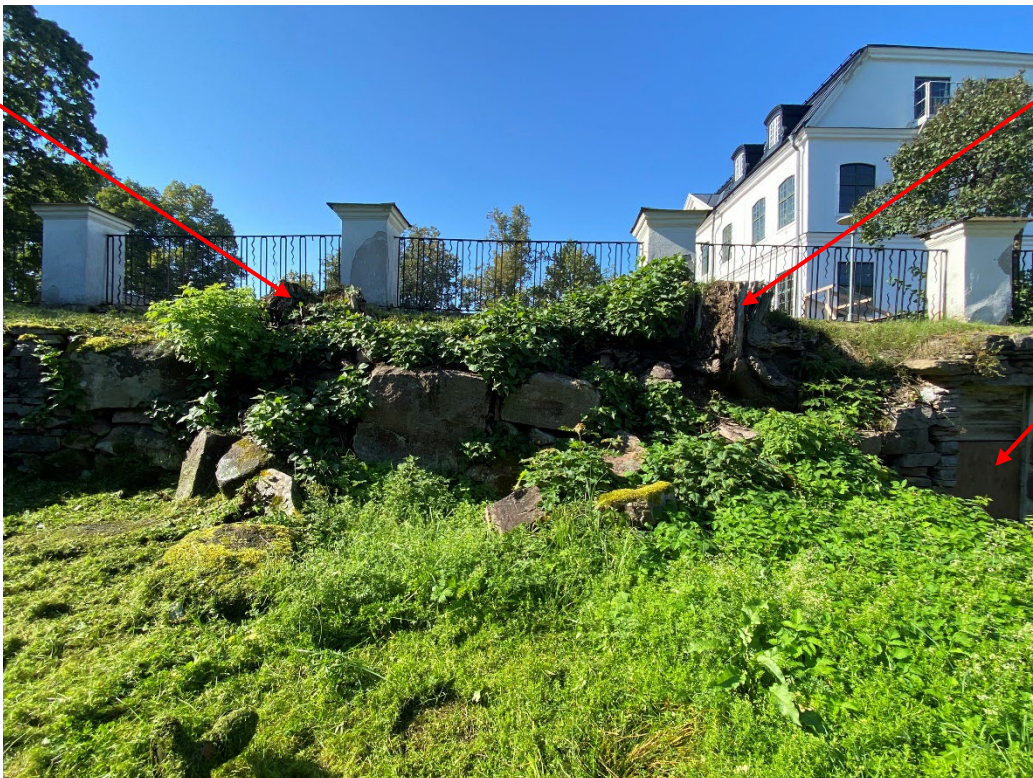
Figur 12. Den södra sidan av terrassmuren var till stor del raserad. De tidigare träden och dess kvarvarande rotsystem var en av orsakerna till skadorna på muren. Stubbarna efter träden samt källaringången är markerade med röda pilar. Foto: Ulrika Olsson, 2024-09-06.
