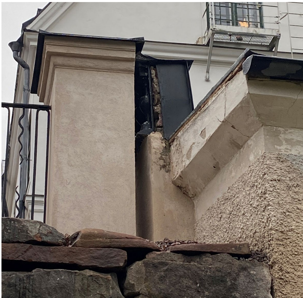
Figur 48. Plåtavtäckningen som skyddar östra flygelns gavel saknas på fotot men hittades efter slutbesiktningen och sattes på plats. Avtäckningen direkt till höger om den nya staketstolpen behöver åtgärdas. Foto: Ulrika Olsson, 2024-12-02.
