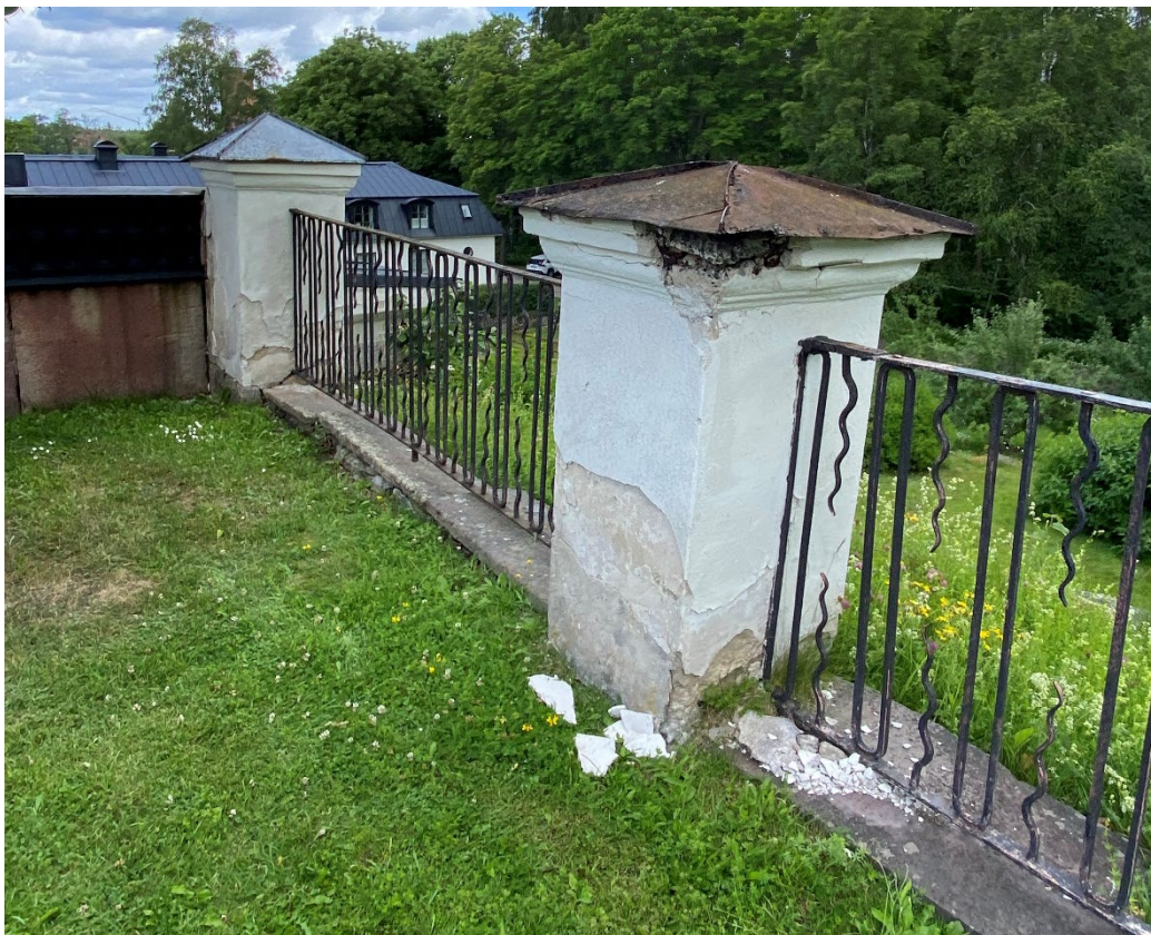
Figur 17. Skicket på två av fyra murade staketstolpar, dess plåthudar och de mellanliggande staketsektionerna i smide innan påbörjade arbeten. Notera även sättningar och skjutningar i granithällarna framför den bortersta stolpen. Foto: Ulrika Olsson, 2024-07-04.
