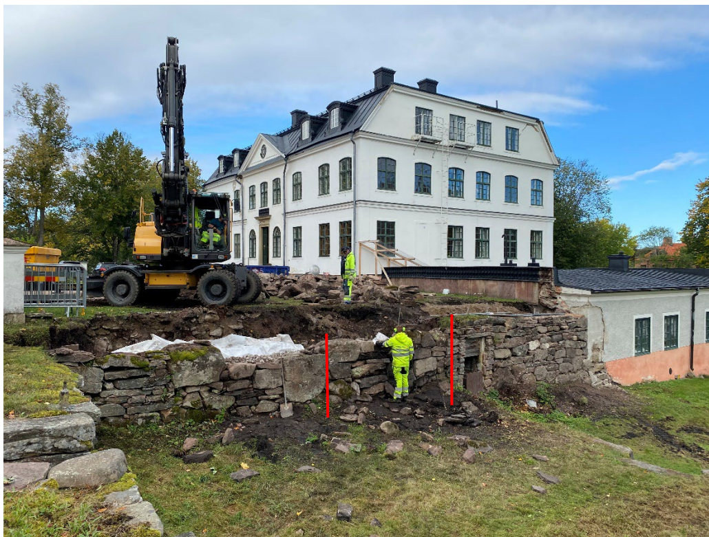
Figur 31. Under pågående arbeten med den södra sidan. Allt eftersom stenarna i muren lades på plats, fylldes också kärnan upp. De röda strecken markerar vilken del av terrassmuren på den södra sidan som har lagts om. Foto: Ulrika Olsson, 2024-09-26.
