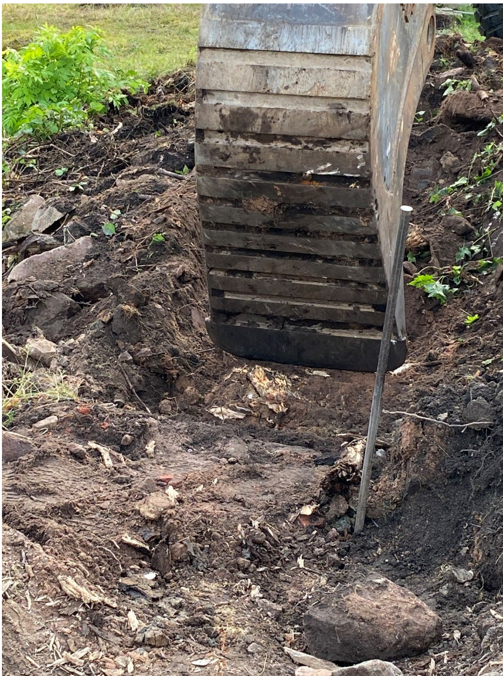
Figur 25. Kärnan bakom den södra delen utgjordes till stor del av kraftiga rötter efter de två träd som växt precis ovanför muren fram till slutet av 1990-talet. Foto: Ulrika Olsson, 2024-09-18.
