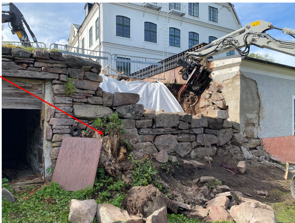
Figur 20. Uppmurnning av den norra delen pågår. Uppfyllning av murkärnan sker i takt med att stenarna i muren läggs på plats. Östra flygelns raserade hörn är lagat. Pilen markerar resten efter ett träd. Foto: Ulrika Olsson, 2024-09-12.
