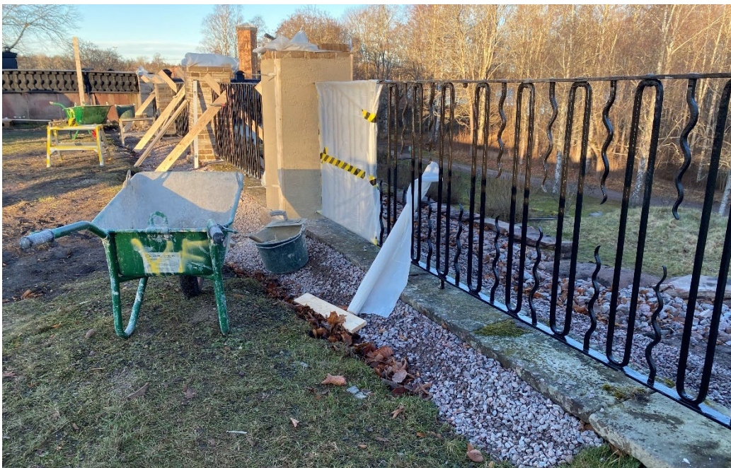
Figur 41. Under pågående arbeten med staketskonstruktionen. Alla fyra stolparna är uppmurade, den närmast i bild är putsad. Nästa moment som följer är att mura och dra profilen högst upp. Foto: Ulrika Olsson, 2024-11-21.
