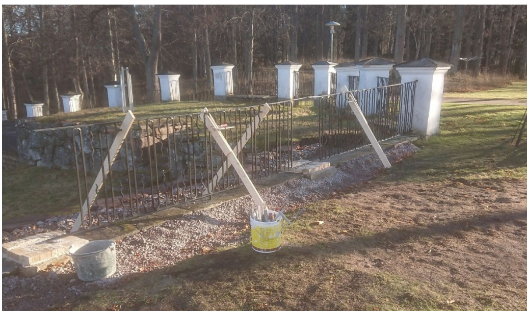
Figur 39. Smidesektionerna är fixerade och uppmurningen av staketstolparna är påbörjad. Det första skiftet är lagt. Foto: Valbo Fasad, oktober 2024.
