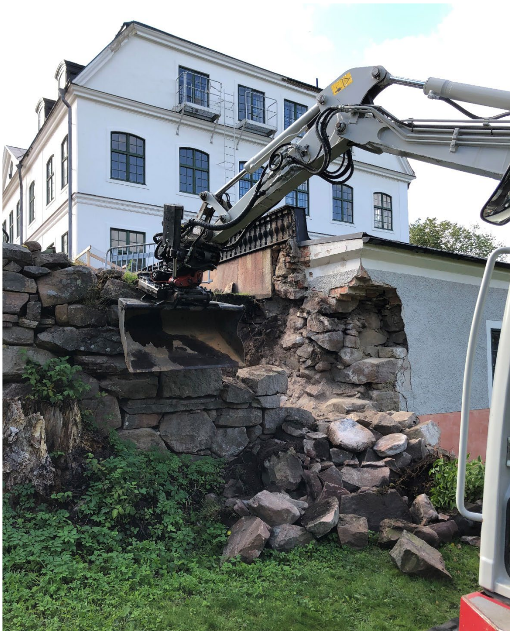
Figur 19. Den norra sidan av muren kort efter raset. Eftersom terrassmuren var inmurad i hörnet på den östra flygeln drog raset med sig delar av murverket i flygelns vägg. Foto: Ulrika Olsson, 2024-09-10.
