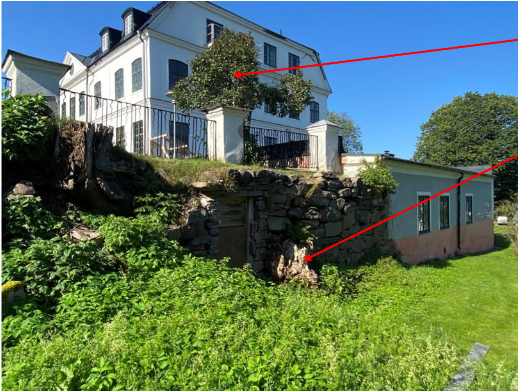
Figur 11. Murverket i den norra sidan av muren var kalvat. Höger om källardörren fanns en stubbe efter ett träd, markerad med en pil. Notera även pilen mot det stora syrenträdet ovanför muren mot gårdsplan. Foto: Ulrika Olsson, 2024-09-06.
