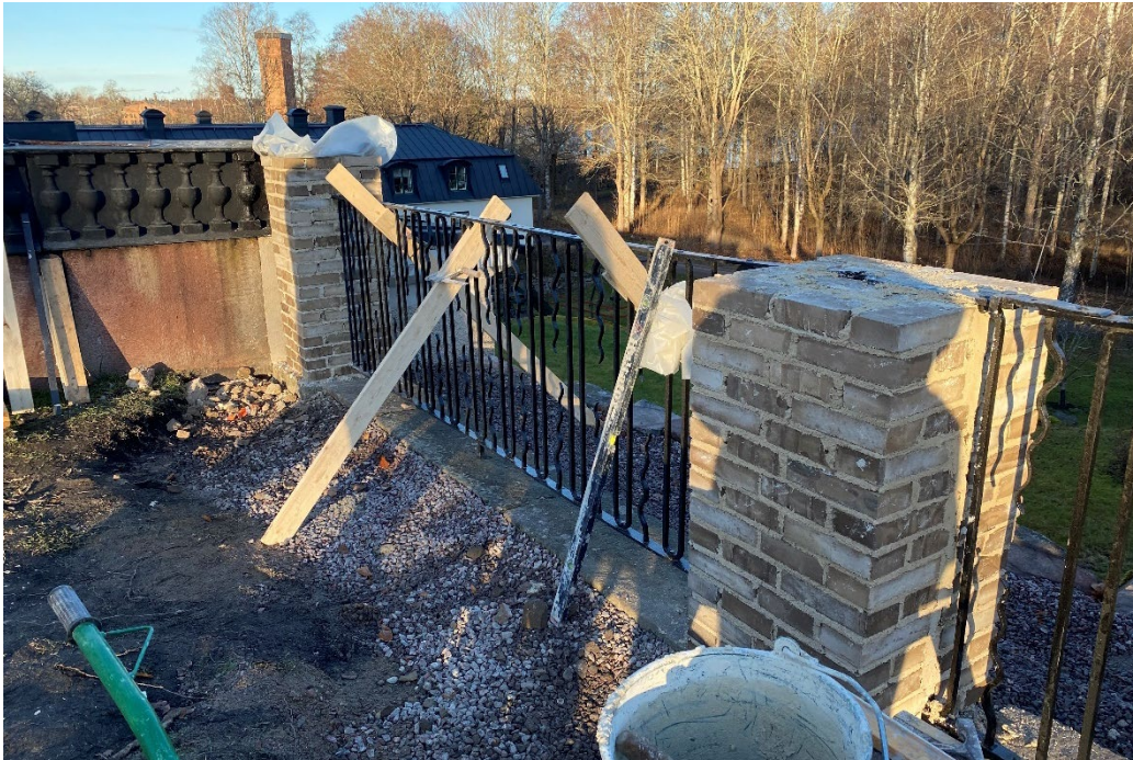
Figur 40. Under pågående arbeten med staketkonstruktionen. Staketstolparna är under uppbyggnad. Planken är till för att fixera smidessektionerna under arbetets gång. Foto: Ulrika Olsson, 2024-11-21.
