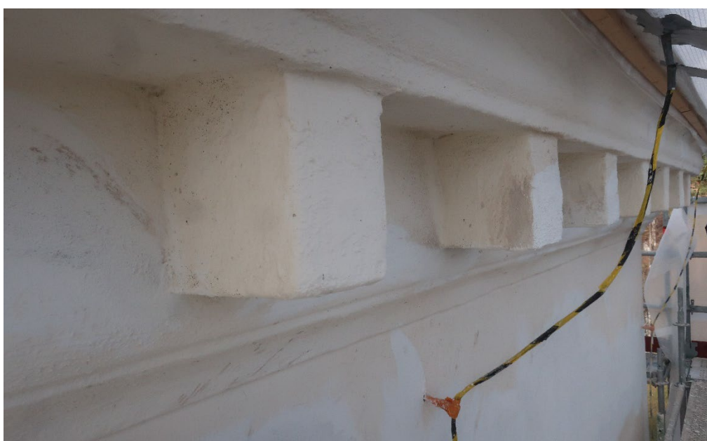
Figur 11. Detalj av listen högst upp på kyrktornets östra fasad efter putsning, men innan avfärgning. Jämför med figur 10. Foto från sydöst: Daniel Olsson, 2020-10-13.
