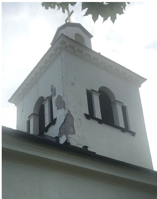
Figur 4. Kyrktornets omfattande skador i putsen innan renoveringen. Foto: Lennart Carlsson, 2020-08-13.
