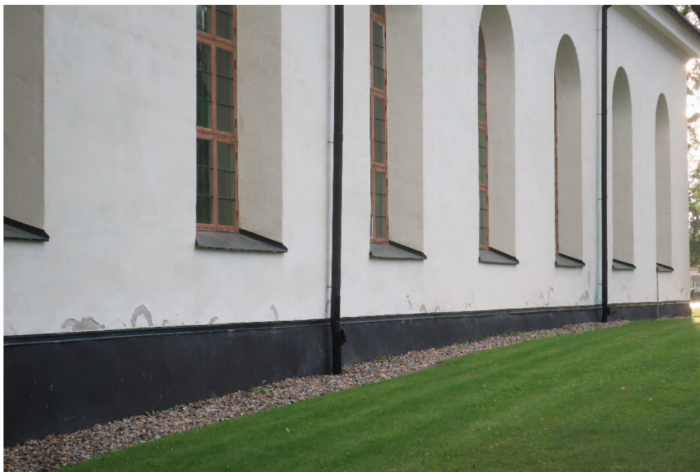
Figur 5. Långhusets norra fasad från nordöst innan arbetet inleddes med skador i putsen ovanför sockeln. Foto: Daniel Olsson, 2020-08-26.
