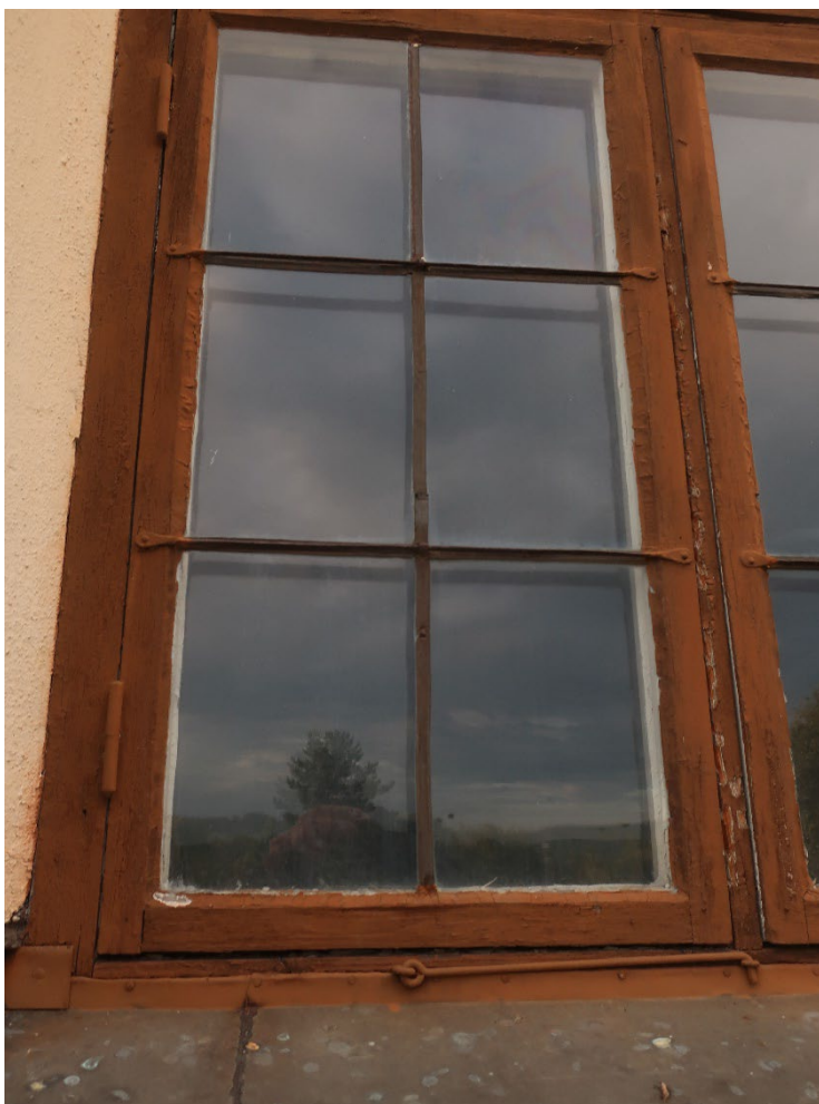
Figur 6. Detalj av fönsterbåge med flagnande färg. Foto: Daniel Olsson, 2020-08-26.
