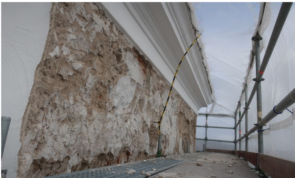
Figur 13. Den övre delen av kyrktornets östra fasad efter nedknackning av all löst sittande puts. Foto från sydöst: Daniel Olsson, 2021-04-30.
