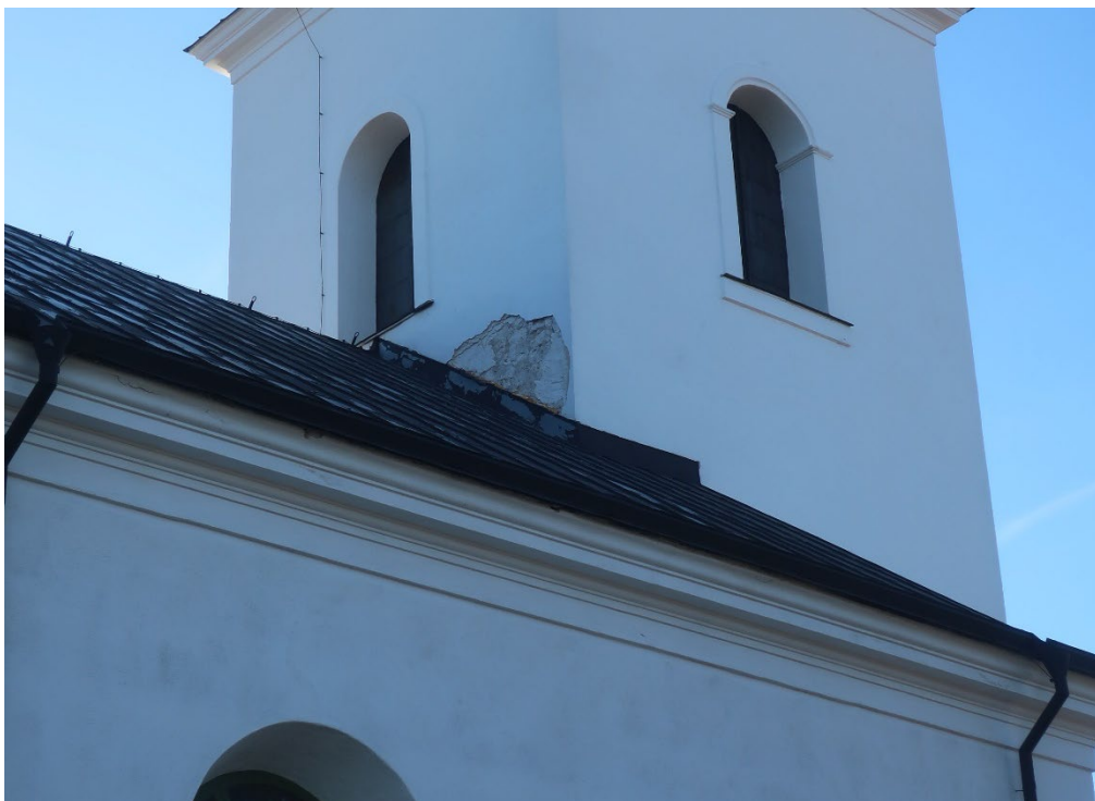
Figur 5. Kyrktornets övre del från nordöst med omfattande puts-skador på tornets östra fasad. Foto: Daniel Olsson, 2021-03-30.
