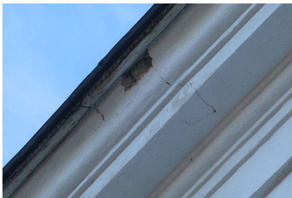
Figur 7. Detalj av skada vid långhusets taklist. Foto: Daniel Olsson, 2024-10-30.
