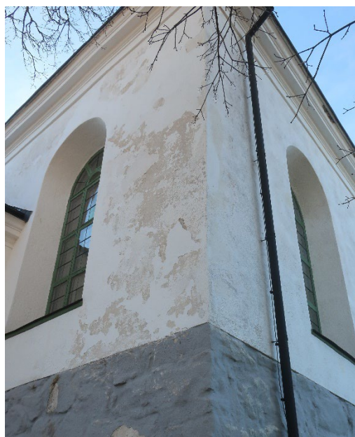
Figur 6. Putsskador på den norra delen av långhusets östra fasad. Foto från nordöst: Daniel Olsson, 2021-03-30.
