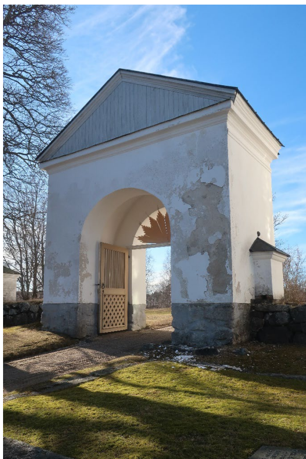
Figur 9. Stigporten från nordöst med omfattande puts-skador på den östra fasaden. Foto: Daniel Olsson, 2021-03-30.
