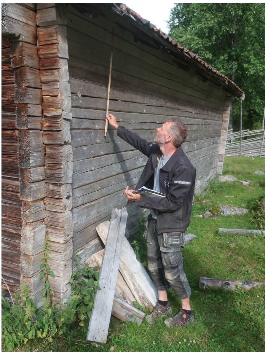
Figur 16. Daniel Åkerman undersöker hur mycket trösklogens nordöstra vägg lutar. På bilden ses även hur timmerväggen har börjat kalva ut. Foto från öster: Daniel Olsson, 2022-07-05.
