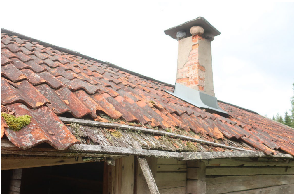
Figur 14. Detalj av vallstugans takfall mot nordöst med skadat tegel och spåntak samt skorsten med putsbortfall. Foto från öster: Daniel Olsson, 2022-07-05.
