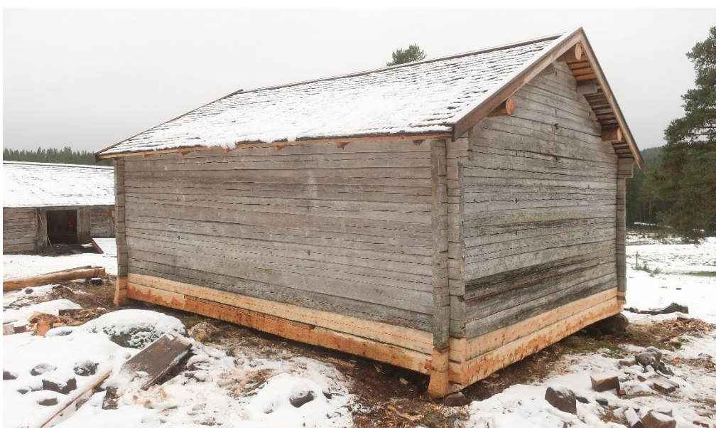
Figur 33. Trösklogen från norr med utbytta stockar. Foto: Daniel Olsson, 2023-11-10.
