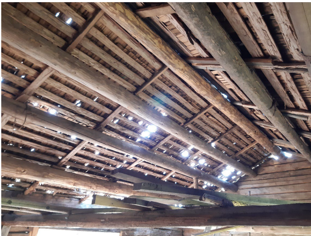
Figur 12. Takkonstruktionen från väster innan renoveringen inleddes med stora hål i spåntaket. Foto: Daniel Olsson, 2024-06-28.
