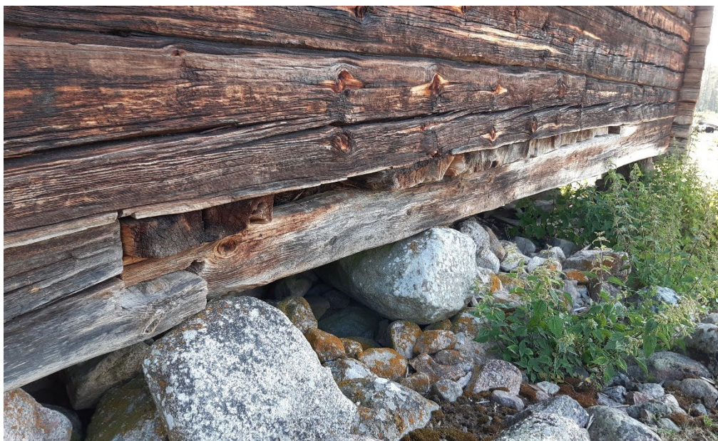
Figur 27. Detalj av öppningen i syllstocken i vägg C där loggolvet mittparti skjuter ut innan renoveringen. Jämför med figur 28. Foto från väster: Daniel Olsson, 2024-06-28.
