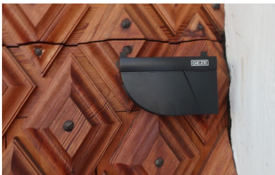
Figur 24. Dörrsensorn på det södra dörrbladets utsida innan inmålning. Foto från väster: Daniel Olsson, 2021-12-16
