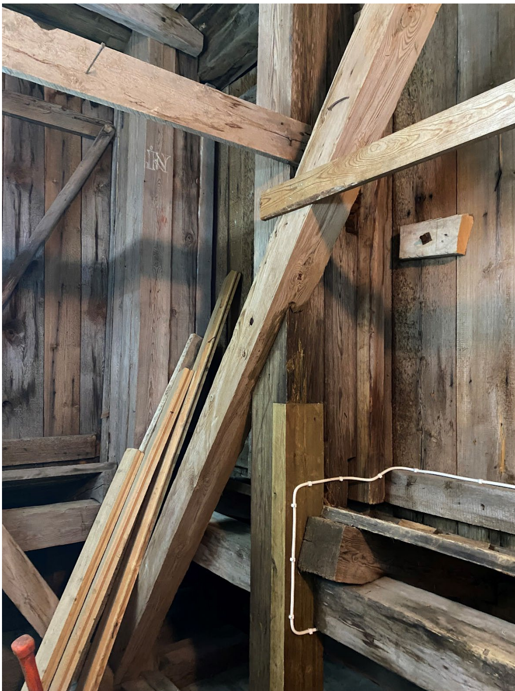
Figur 11. På fotot syns de två stolpar som finns inritade i åtgärdsförslaget och som är markerade i figur 9. På fotot syns att den yttre stolpen har lagats i ett tidigare skede. Foto: Ulrika Olsson, 2025-02-07.
