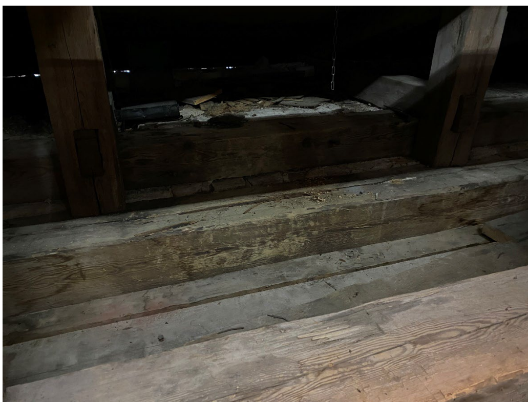
Figur 6. Det övre bjälklaget innan påbörjade arbeten. Här anses skadan på den östra sidan, markerad med "B" i figur 5. Foto: Ulrika Olsson, 2025-02-07.
