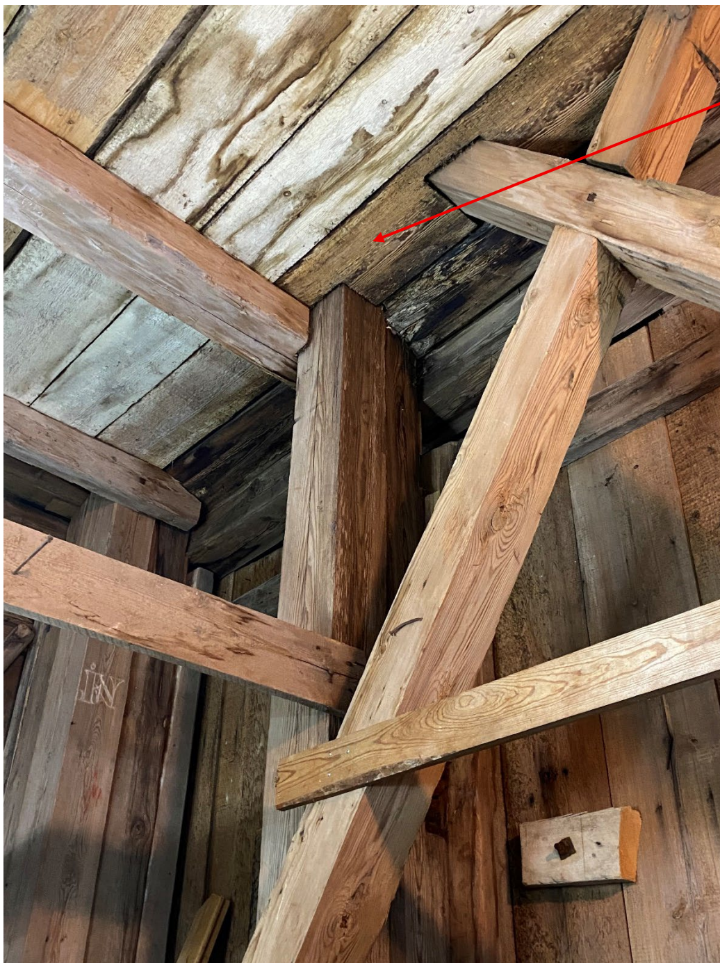
Figur 12. Vid det första besöket hade en tidigare ej uppmärksammas murken bräda ovanför stolparna upptäckts. Foto: Ulrika Olsson, 2025-02-07.
