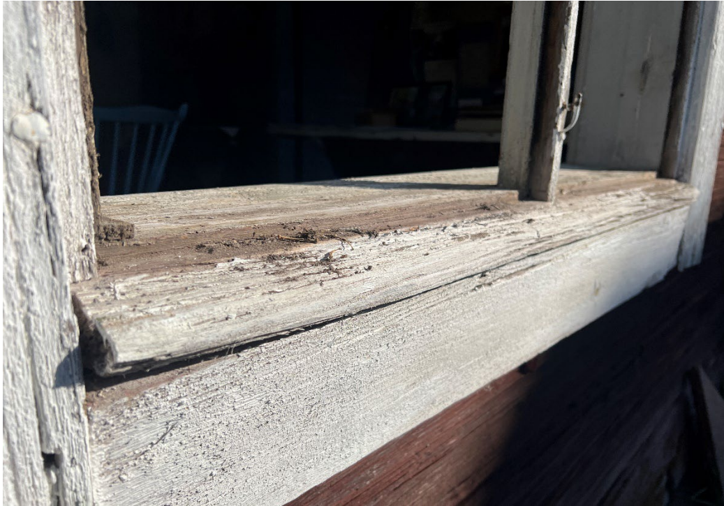
Figur 6. Uttjänt vattbräda i fönsterparti till vänster om ingången. Vattbrädorna på denna sida var tillverkade i samma stycke trä som utgör karmbottenstycket. Foto: Heinemann Snickeri AB september 2025.
