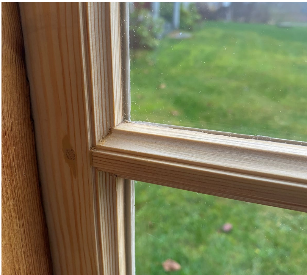
Figur 9. Profilen på en av de nytilverkade fönsterbågarna i rummet till höger om ingången. Foto: Ulrika Olsson, Länsmuseum Gävleborg, 2025-11-07.
