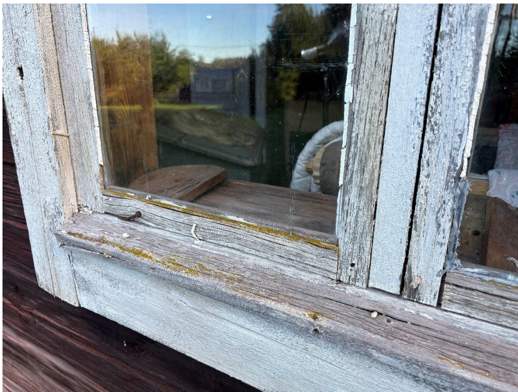
Figur 4. Två av de äldre fönsterbågarna innan påbörjade arbeten. Träet i fönsterbågarna var murket och urlakat. Kittfalsen var på sina ställen i det närmaste obefintlig. Vattbrädorna var uttjänta. Foto: Ulrika Olsson, Länsmuseum Gävleborg, 2025-09-23.
