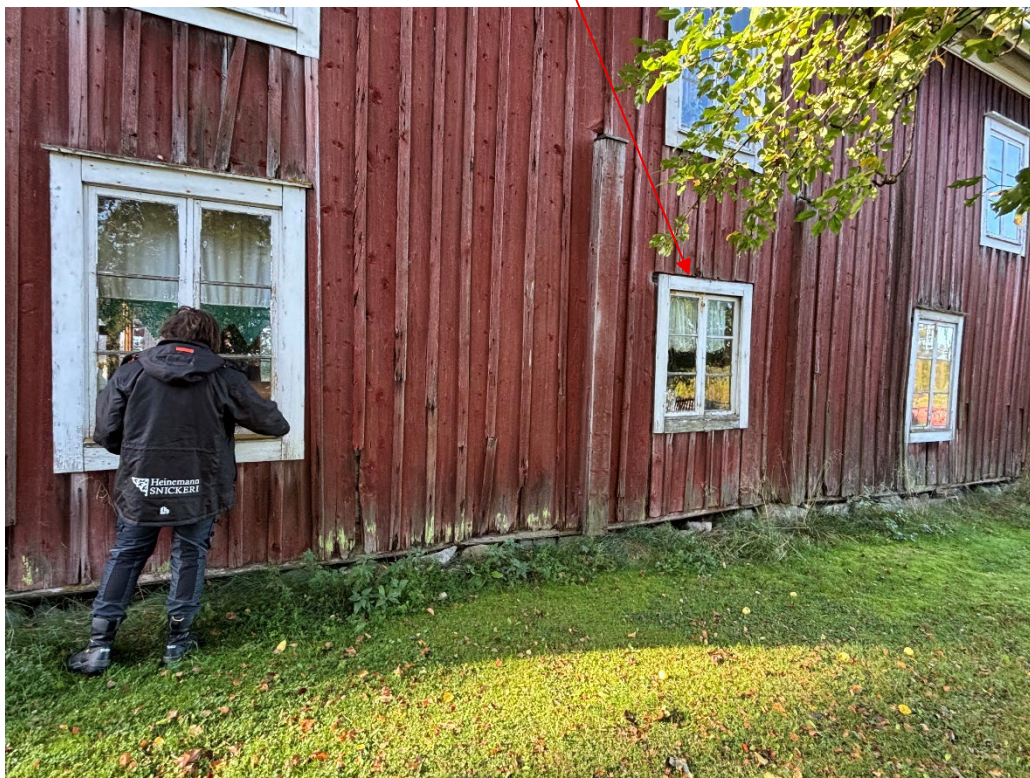
Figur 16. Samtliga vattbrädor på ännu inte åtgärdade fönster behöver ses över. Det gäller vattbrädor både ovanför och nedanför fönsterbågarna. På några av fönsterenheterna saknas vattbrädor helt, se markering med den röda pilen. Fasadpanelen behöver på sikt lagas i och vattbrädan längst ner behöver bytas. Foto: Ulrika Olsson, Läns museet Gävleborg, 2025-11-07.
