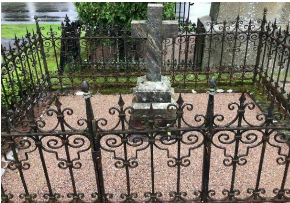
Figur 11. GK05 0054 innan åtgärd. Smidesstaket i behov av renovering. Stensockel i behov av riktning. Foto: Kyrkogårdsenheten, Gävle församling, sommar 2023.
