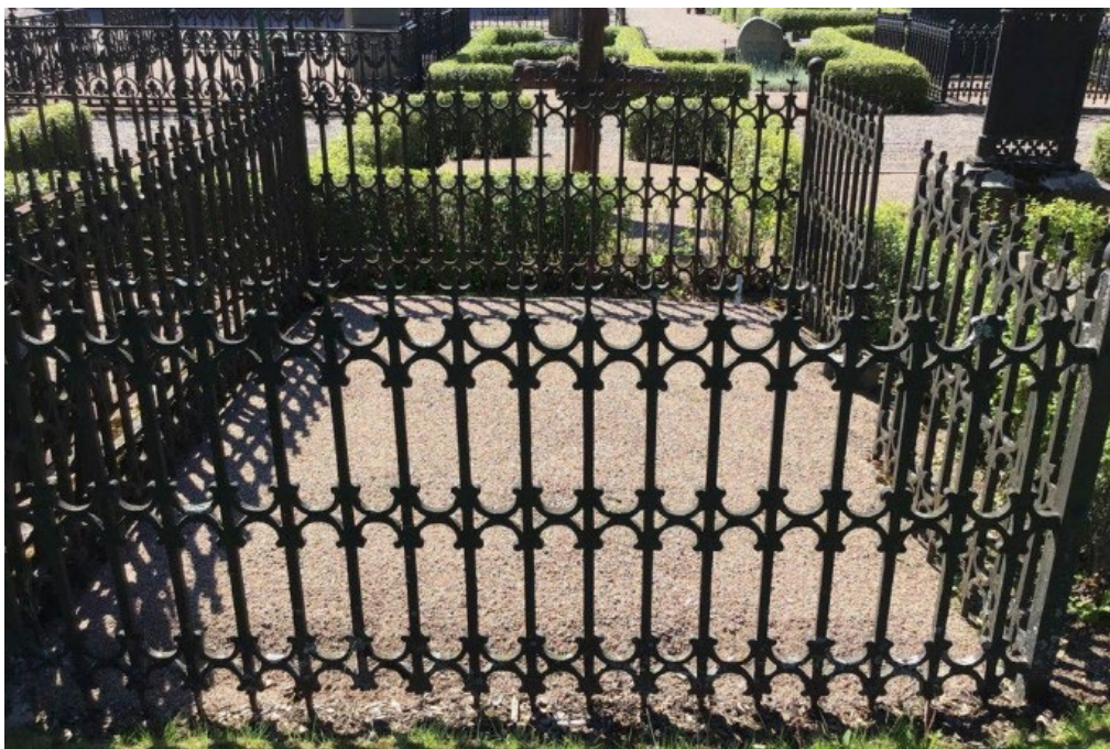
Figur 8. GK03 0069 innan åtgärd. Gjutjärnsstaket i behov av renovering. Stenkuber i behov av riktning. Foto: Kyrkogårdsenheten, Gävle församling, sommar 2023.
