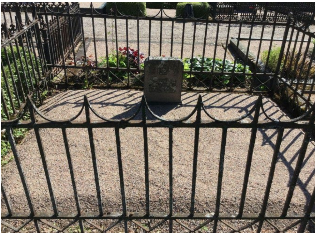
Figur 6. GK03 0057 innan åtgärd. Smidesstaket i behov av renovering. Hörnstenar i behov av riktning. Foto: Kyrkogårdsenheten, Gävle församling, sommar 2023.
