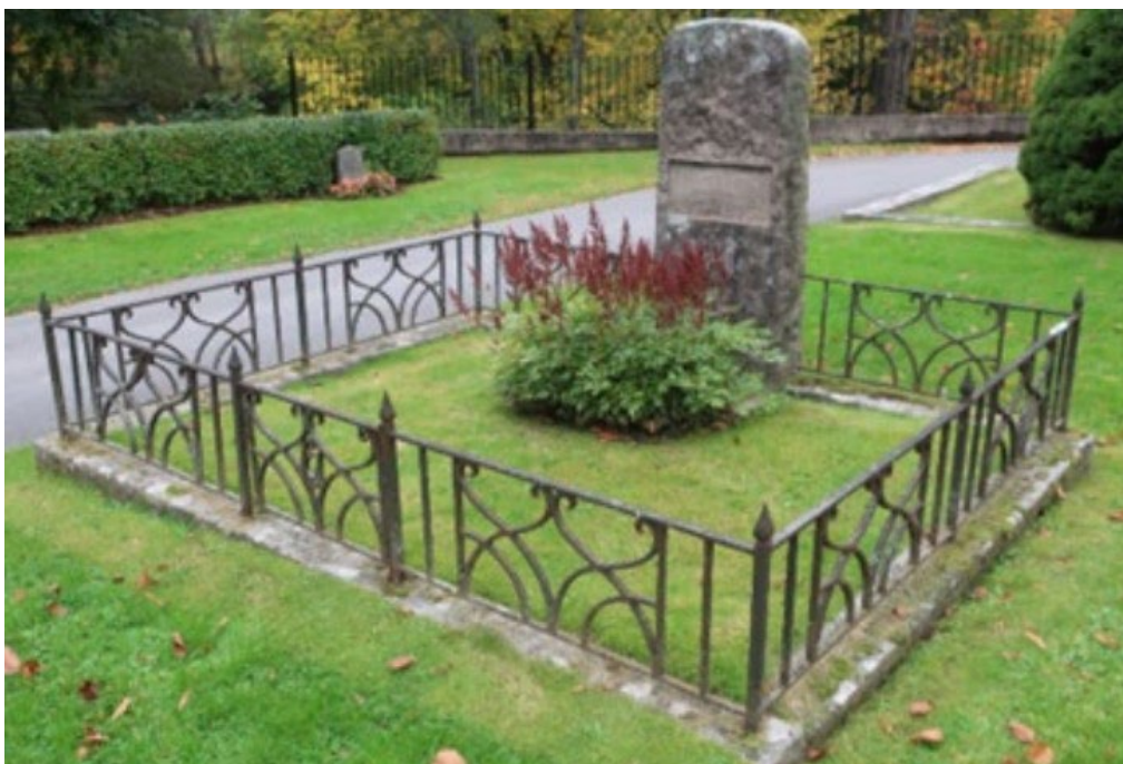
Figur 19. GK10 0175 innan åtgärd. Smidesstaket i behov av renovering. Stensockel i behov av riktning. Foto: Kyrkogårdsenheten, Gävle församling, sommar 2023.
