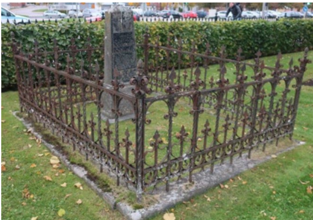
Figur 15. GK06 0020 innan åtgärd. Smidesstaket i behov av renovering. Stensockel i behov av riktning. Foto: Kyrkogårdsenheten, Gävle församling, sommar 2023.
