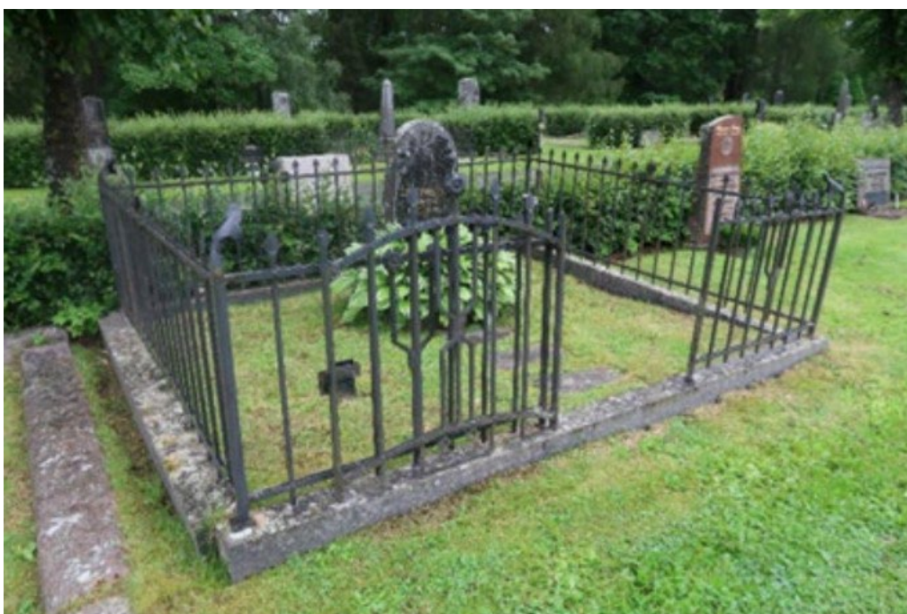
Figur 21. GK12 0028 innan åtgärd. Smidesstaket i behov av renovering. Stensockel i behov av riktning. Foto: Kyrkogårdsenheten, Gävle församling, sommar 2023.
